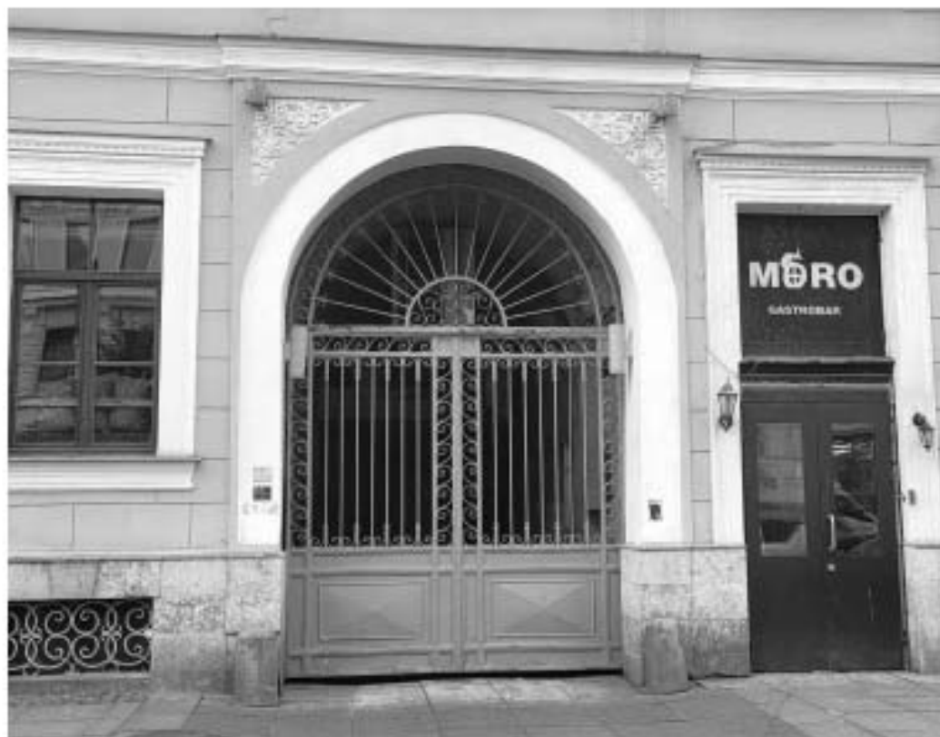
29. ВОКН «Особняк В.В. Долгоруковой (А.И. Шаховского)». Воротный проезд с полуциркульным завершением северного фасада – металлическая решетка, рисунок и конфигурация исполнения. Дата дополнительной съемки: 22.09.2025г.
