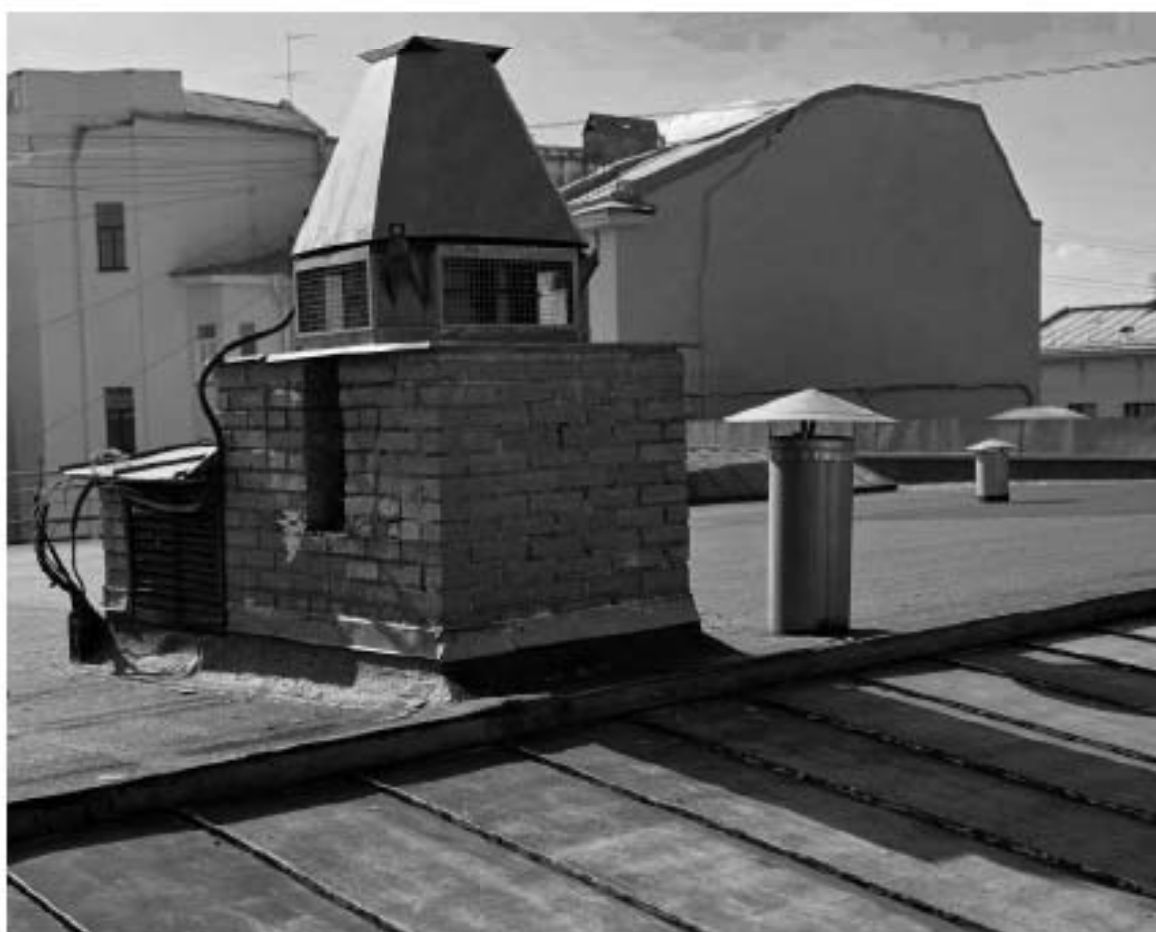
4. ВОКН «Особняк В.В. Долгоруковой (А.И. Шаховского)». Общий вид крыши. Фрагмент инженерных коммуникаций. Дата съемки: 25.08.2025г.
