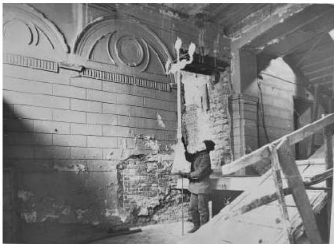
106. Особняк В.В. Долгоруковой (А.И. Шаховского). Торшер вестибюля (макет). Вид со стороны входа. 1988г. ЦГАНТД СПб. Ф. Р-488. Оп. 314. Д. 60. Л. 30.
