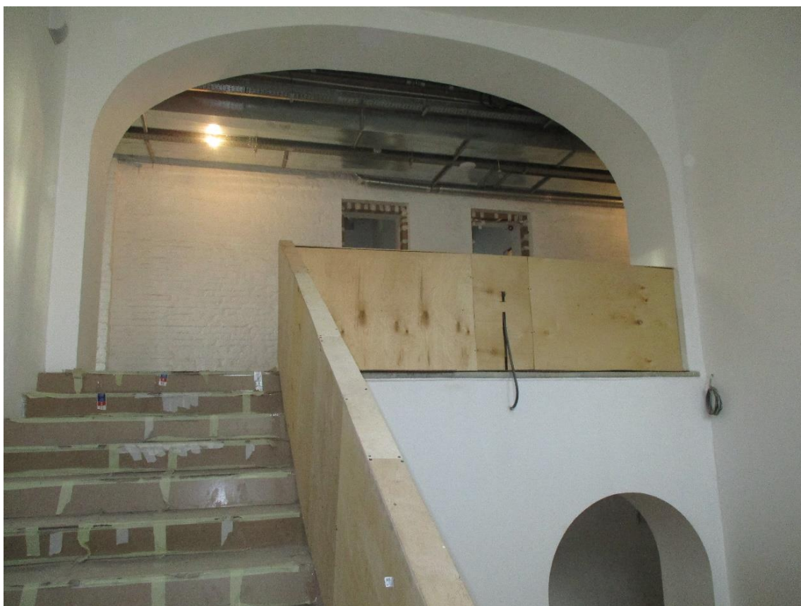
Фото 15. Орлово-Новосильцевская богадельня, пр. Энгельса, д.1, стр.2. Лестничная клетка в осях 7-8/Г-Е. Общий вид на арочный проем 2-го этажа. (7-8/Г). 29.06.2020 г.
