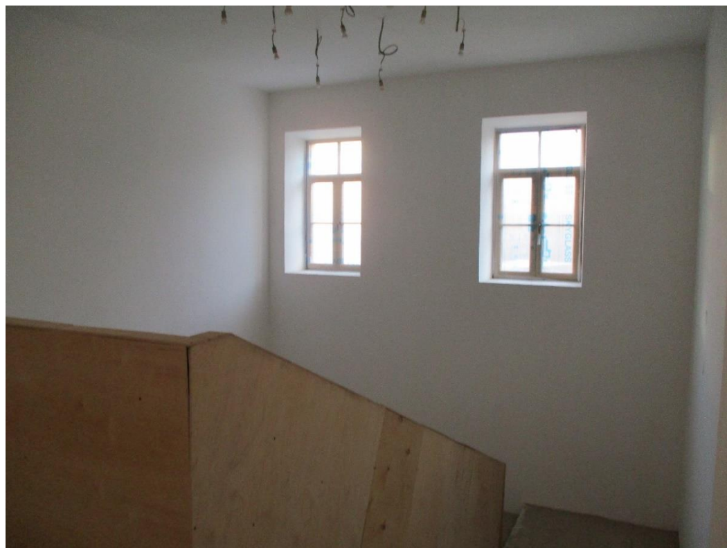
Фото 19. Орлово-Новосильцевская богадельня, пр. Энгельса, д.1, стр.2. Лестничная клетка в осях 7-8/Г-Е. Вид со 2-го этажа, стена в осях 7-8/Е. 29.06.2020 г.
