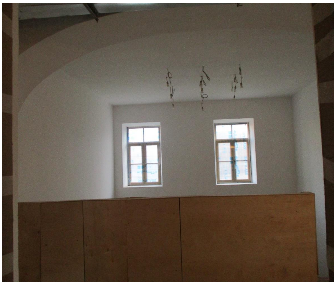
Фото 21. Орлово-Новосильцевская богадельня, пр. Энгельса, д.1, стр.2. Лестничная клетка в осях 7-8/Г-Е. Вид со 2-го этажа, стена в осях 7-8/Е. 29.06.2020 г.
