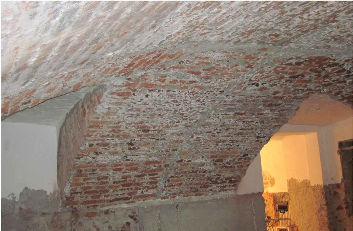
Фото 30. Орлово-Новсылцевская богадельня, пр. Энгельса, д.1, стр.2. Подвал в осях 7-8/Г-Е. Вид на стену по оси «8». 30.06.2020г.
