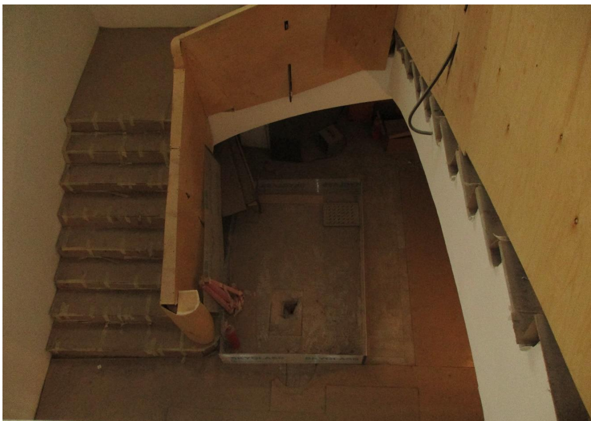
Фото 12. Орлово-Новосильцевская богадельня, пр. Энгельса, д.1, стр.2. Лестничная клетка в осях 7-8/Г-Е. Вид со 2-го этажа. 29.06.2020 г.
