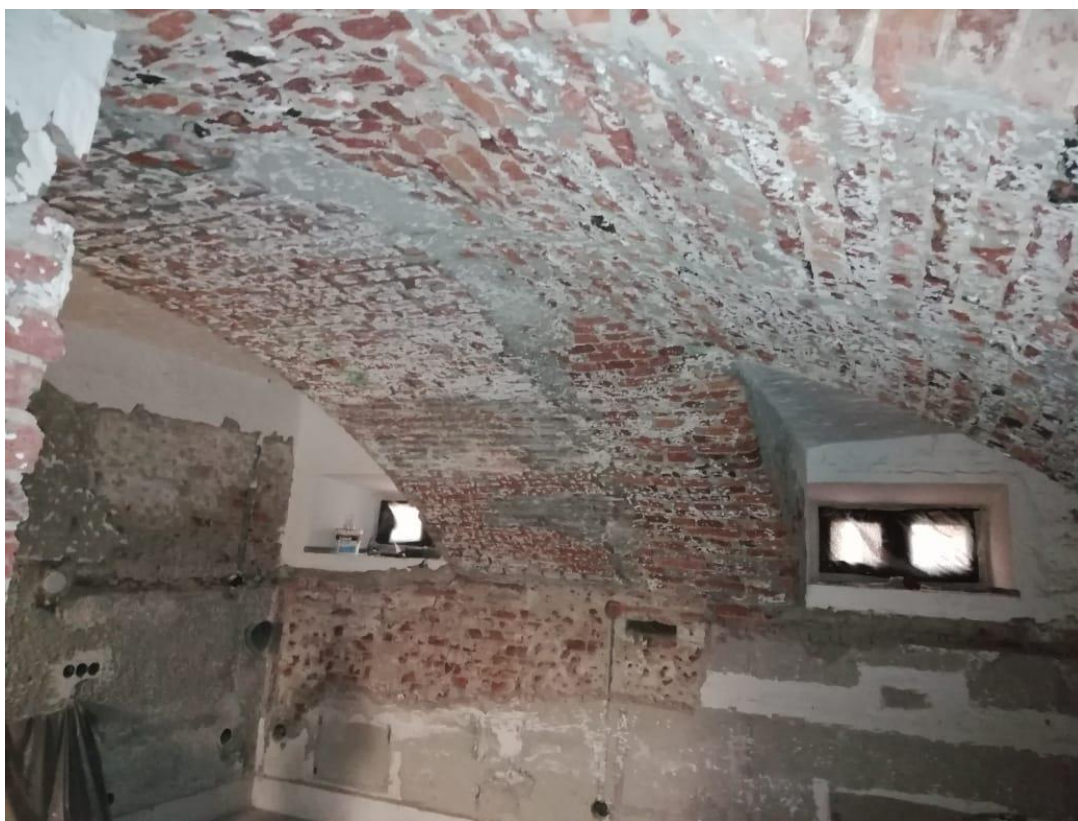
Фото 24. Орлово-Новосильцевская богадельня, пр. Энгельса, д.1, стр.2. Общий вид перекрытия подвала в осях 7-8/Г-Е. Главная арка опирается на стены в осях Е и Г, часть полуарки опирается на стену по оси 8 и на главную стену. 30.06.2020г.
