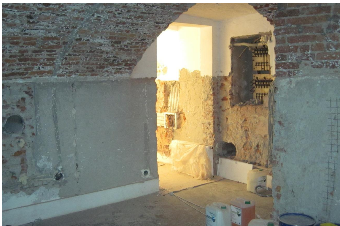
Фото 28. Орлово-Новсылцевская богадельня, пр. Энгельса, д.1, стр.2. Подвал в осях 7-8/Г-Е. Вид перекрытия в зоне пересечения стен по осям «8» и «Г». 30.06.2020г.
