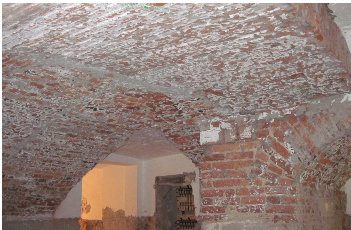
Фото 29. Орлово-Новсылцевская богадельня, пр. Энгельса, д.1, стр.2. Подвал в осях 7-8/Г-Е. Пересечение главной арки в осях Г÷Е и полуарки в осях 7-8. 30.06.2020г.
