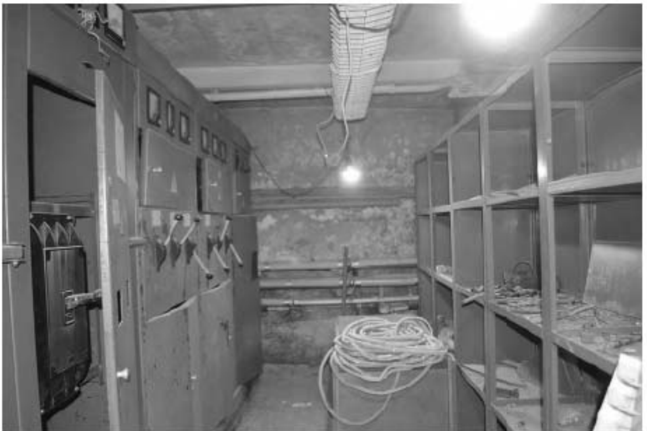
Фото 61. ОКН федерального значения «Корпус семинарский с южными воротами главного двора» (г. Санкт-Петербург, набережная реки Монастырки, дом 1, лит. Г). Подвал. Помещение в осях В-Г/9-10. Съёмка 08.11.2021 г.
