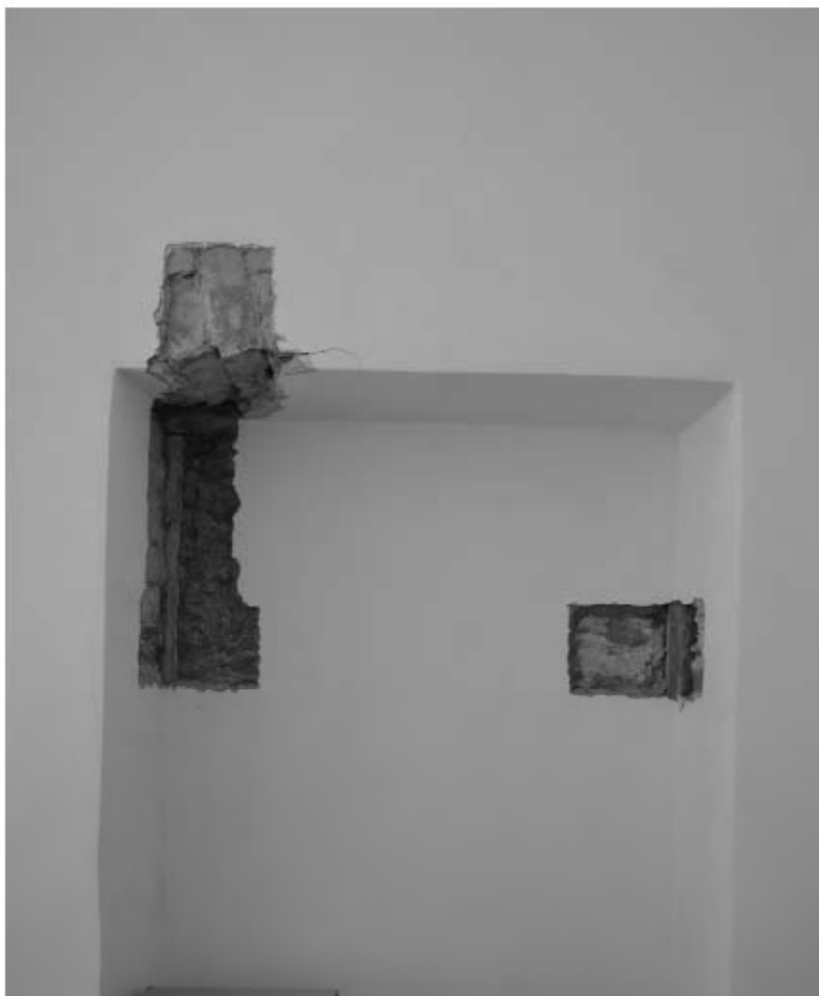
Фото 14. ОКН федерального значения «Корпус семинарский с южными воротами главного двора» (г. Санкт-Петербург, набережная реки Молятырки, дом 1, лит. Г). Первый этаж. Галерея первого этажа. Фрагмент. Съёмка 08.11.2021 г.
