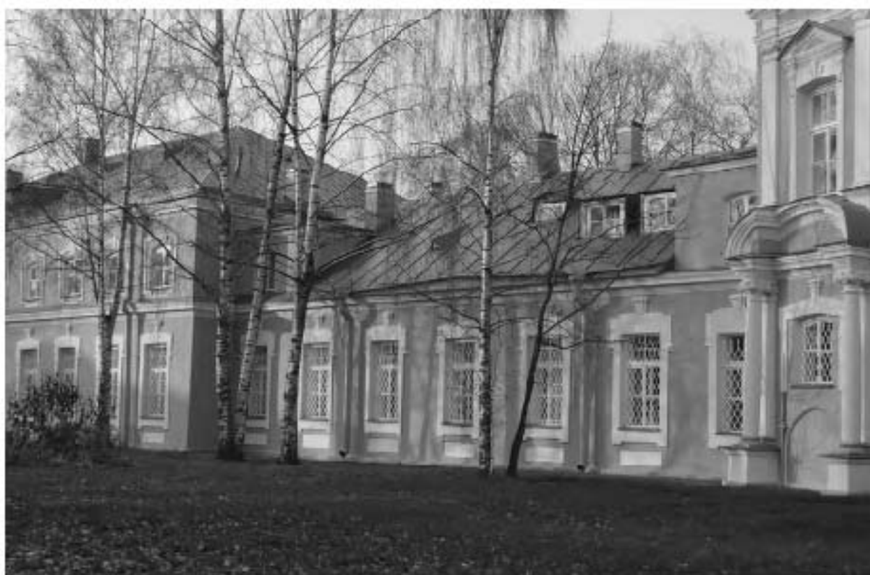
Фото 03. ОКН федерального значения «Корпус семинарский с южными воротами главного двора» (г. Санкт-Петербург, набережная реки Монастырки, дом 1, лит. Г). Юго-восточный фасад. Крыша. Фрагмент. Съёмка 08.11.2021 г.
