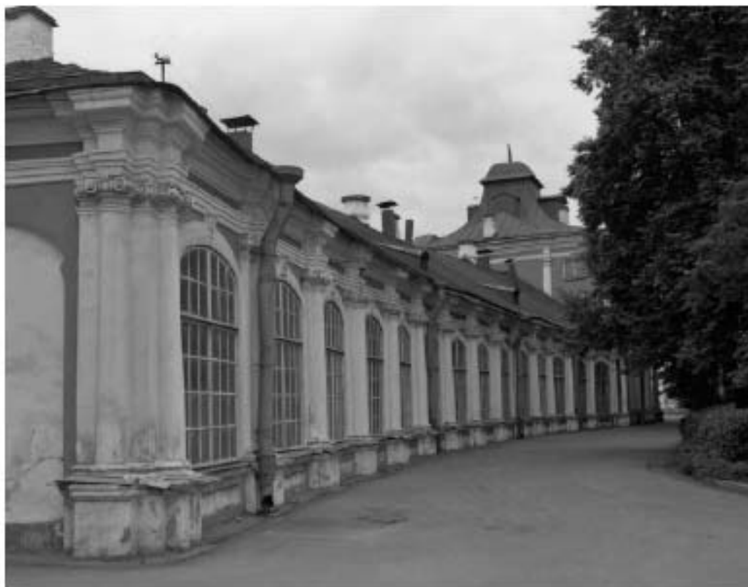
Илл. 25. Семинарский корпус. Вид со двора Лавры от Феодоровской церкви. 1994 г. // Немецкий центр документации по истории искусств (Электронный ресурс) https://www.bildindex.de/document/obj20342372
