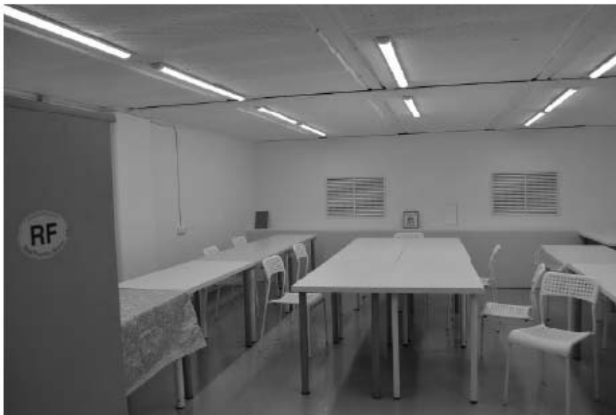
Фото 66. ОКН федерального значения «Корпус семинарский с южными воротами главного двора» (г. Санкт-Петербург, набережная реки Монастырки, дом 1, лит. Г). Подвал. Помещение в осях Б-Г/18-22. Съёмка 08.11.2021 г.
