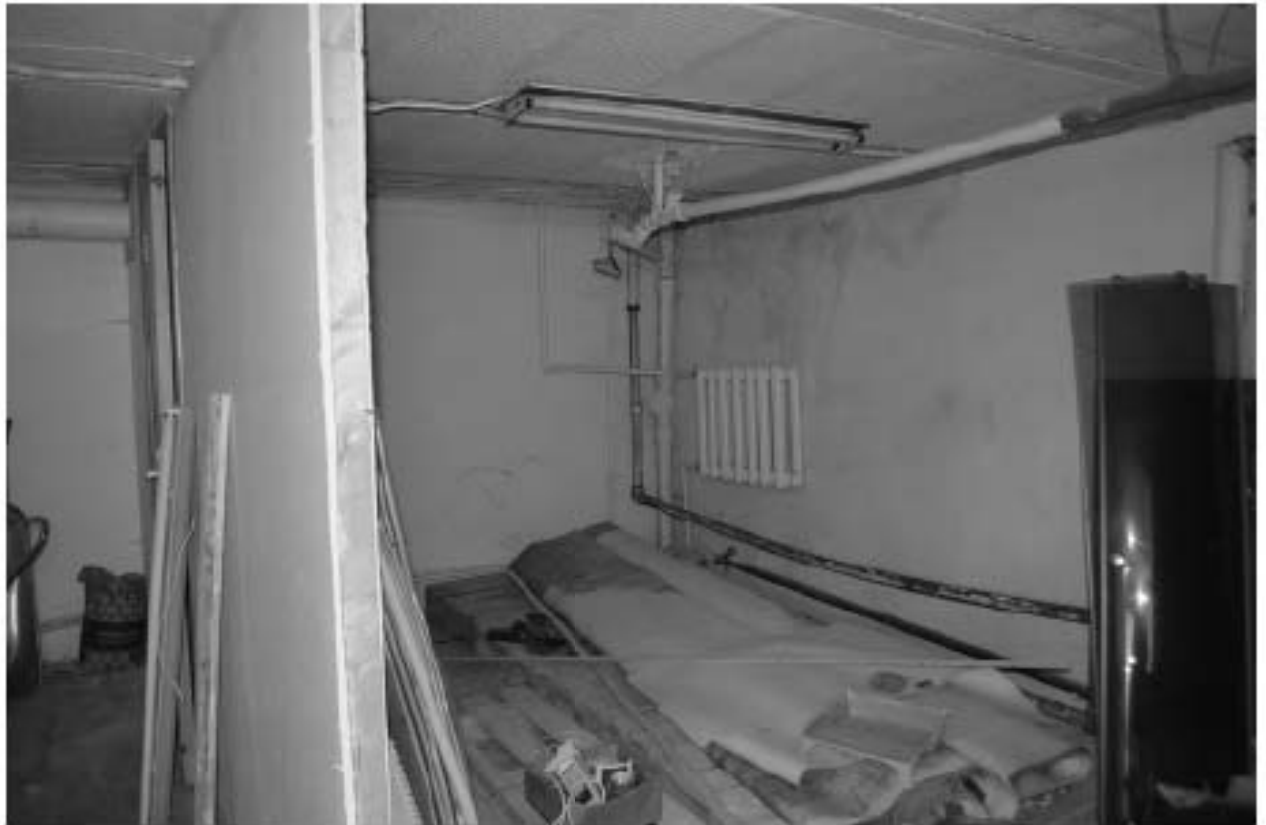
Фото 65. ОКН федерального значения «Корпус семинарский с южными воротами главного двора» (г. Санкт-Петербург, набережная реки Монастырки, дом 1, лит. Г). Подвал. Помещение в осях Б-Г/18-22. Съёмка 08.11.2021 г.
