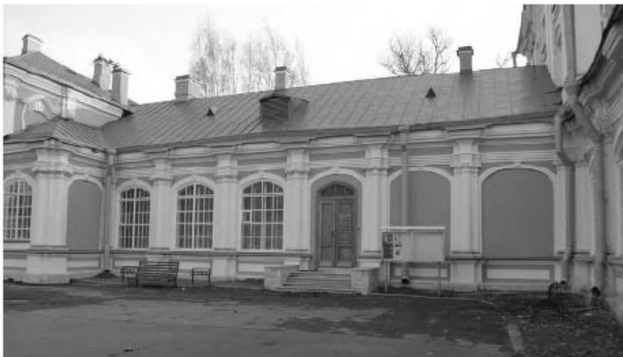
Фото 08. ОКН федерального значения «Корпус семинарский с южными воротами главного двора» (г. Санкт-Петербург, набережная реки Могаытырки, дом 1, лит. Г). Северо-западный фасад. Крыша. Фрагмент. Съёмка 08.11.2021 г.
