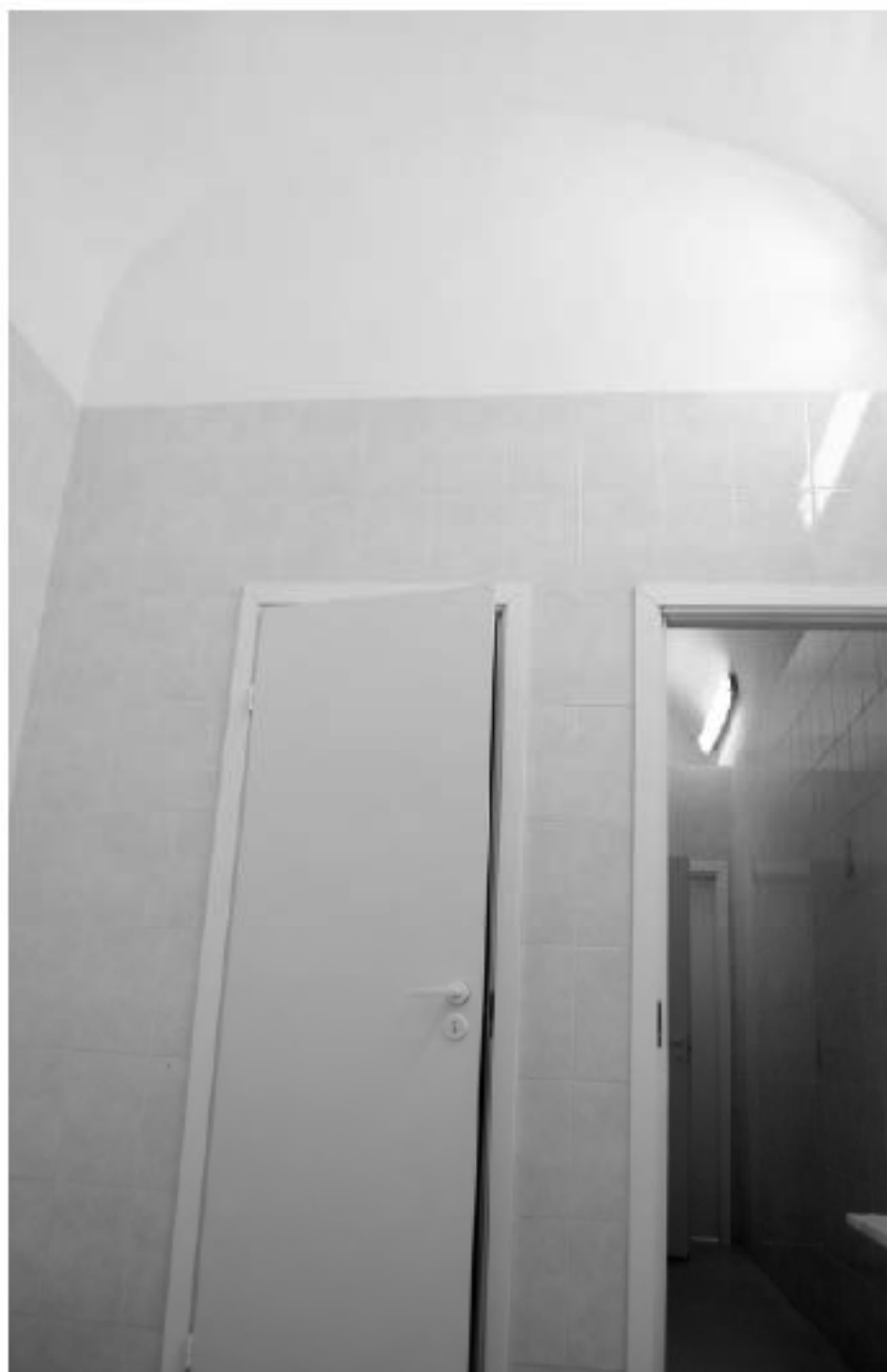
Фото 25. ОКН федерального значения «Корпус семинарский с южными воротами главного двора» (г. Санкт-Петербург, набережная реки Молятырки, дом 1, лит. Г). Первый этаж. Помещение 3-Н (37). Фрагмент расчисток. Съёмка 08.11.2021 г.
