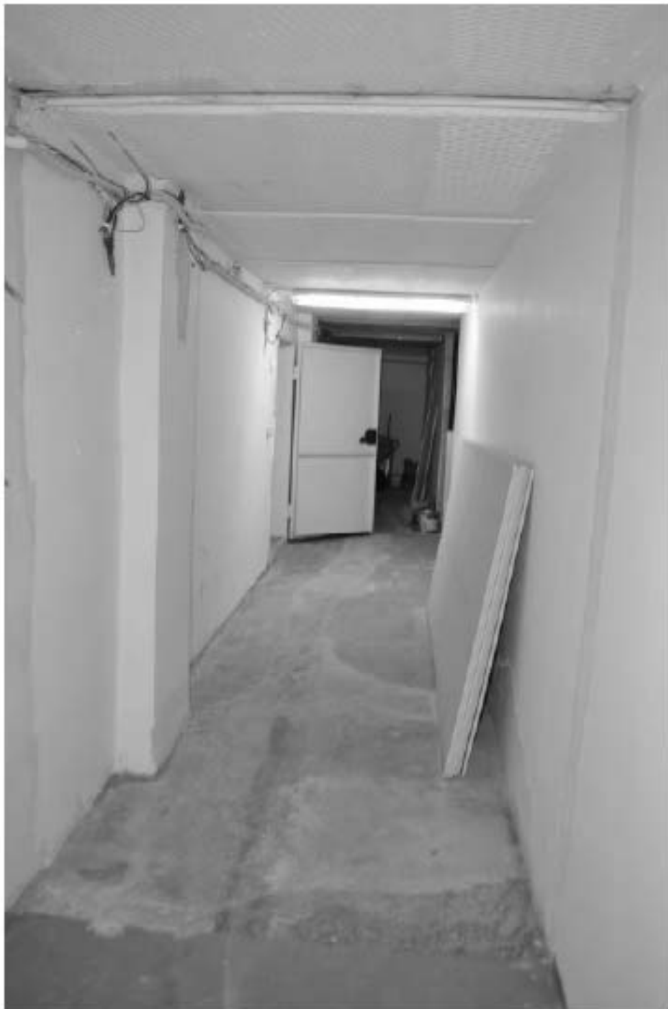
Фото 62. ОКН федерального значения «Корпус семинарский с южными воротами главного двора» (г. Санкт-Петербург, набережная реки Монастырки, дом 1, лит. Г). Подвал. Помещение в осях Б-Г/18-22. Съёмка 08.11.2021 г.
