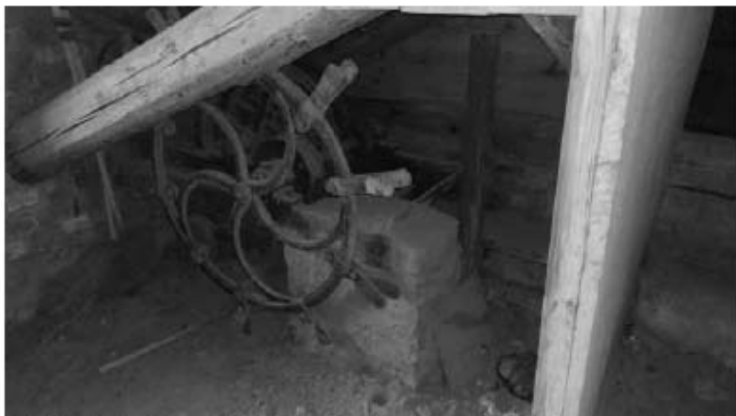
Фото 38. ОКН «Лечебница А.Л. Эбермана». Главное здание по адресу: СПб, г. Пушкин, Московское шоссе, д. 7. Помещение мансарды. Лифтовой механизм. Дата съёмки: 20.08.2021.
