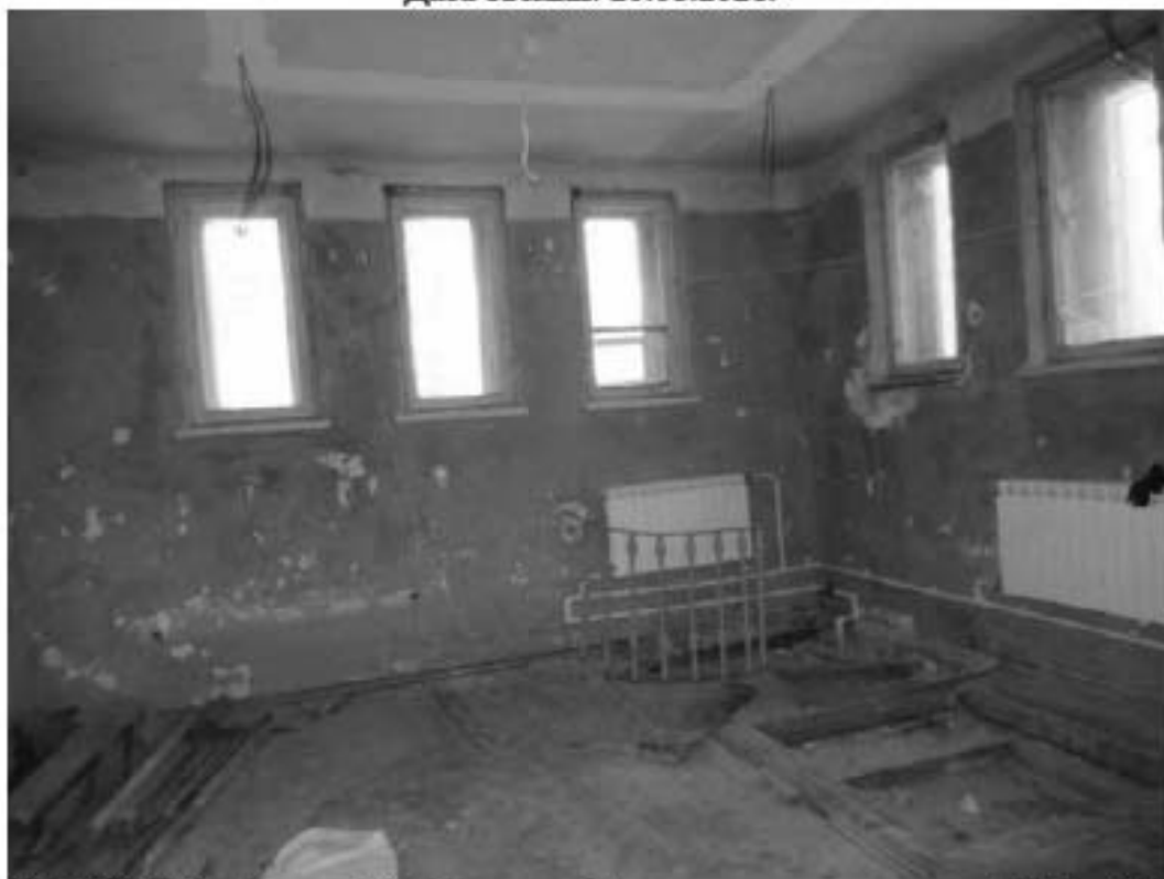
Фото 37. ОКН «Лечебница А.Л. Эбермана». Главное здание по адресу: СПб, г. Пушкин, Московское шоссе, д. 7. Помещение мансарды. Общий вид. Дата съёмки: 20.08.2021.
