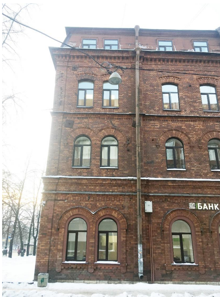
Фото 6. Фрагмент бокового фасада по Заставской улице по оси «8» в осях «А-Б». Поздние окрасочные пятна. Загрязнение цокольной части. Трещина в кладке на угловой лопатке в уровне 3-го этажа.
