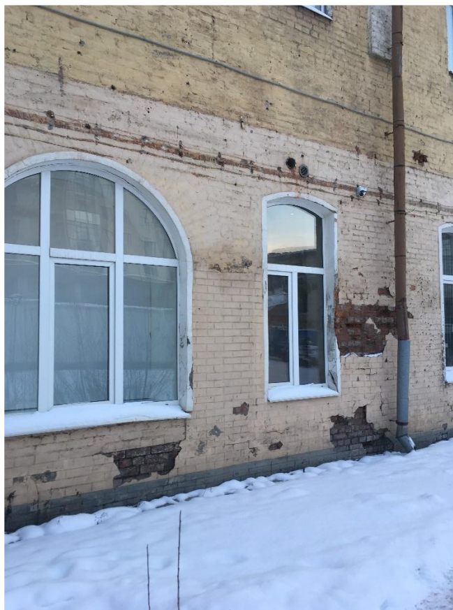
Фото 14. Фрагмент стены м/о «6-5» в уровне 1-го этажа по оси «Е». Биопоражения в цокольной части стены. Отсутствие цоколя. Следы крепления инженерных сетей.
