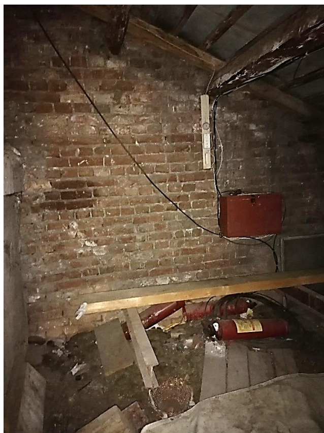
Илл.34. Торцевая стена на чердаке. №11. 05.07.2021г.
