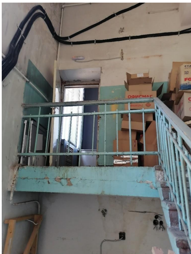
Илл.28. Лестничная клетка в части здания со стороны Кондратьевского проспекта. Верхняя площадка. 05.07.2021г.
