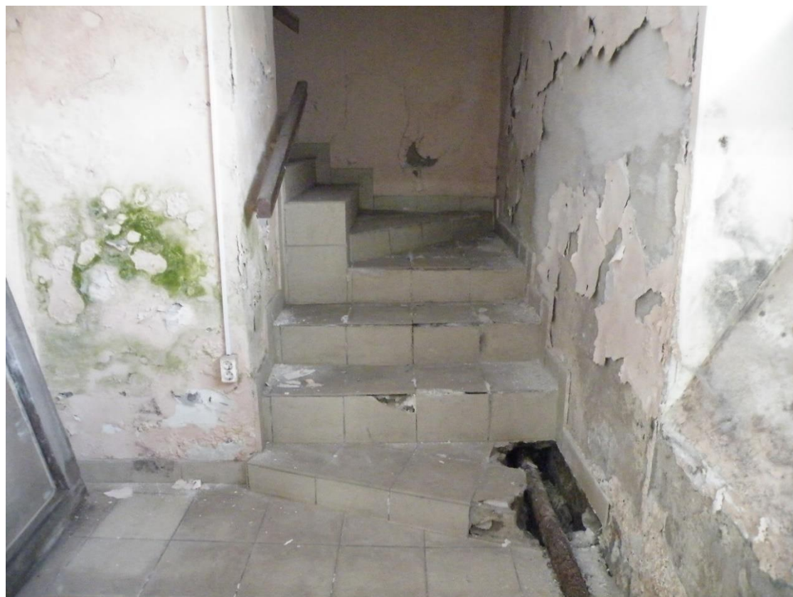
Илл.45. Подвал. Помещение №4 с лестницей в части здания со стороны Полюстровского проспекта. 05.07.2021г.
