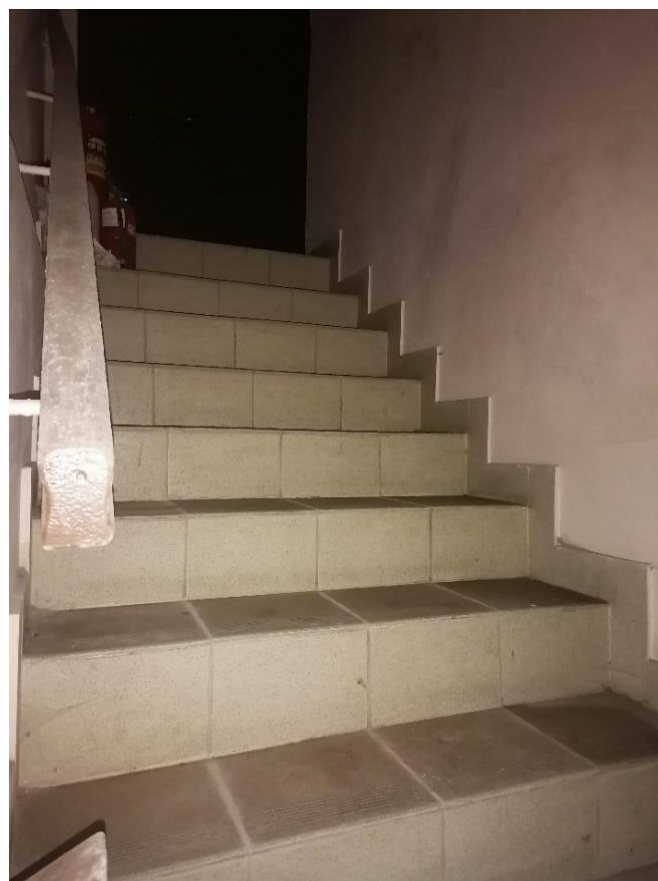
Илл.44. Подвал. Лестница из помещения №4 в части здания со стороны Полюстровского проспекта. 05.07.2021г.
