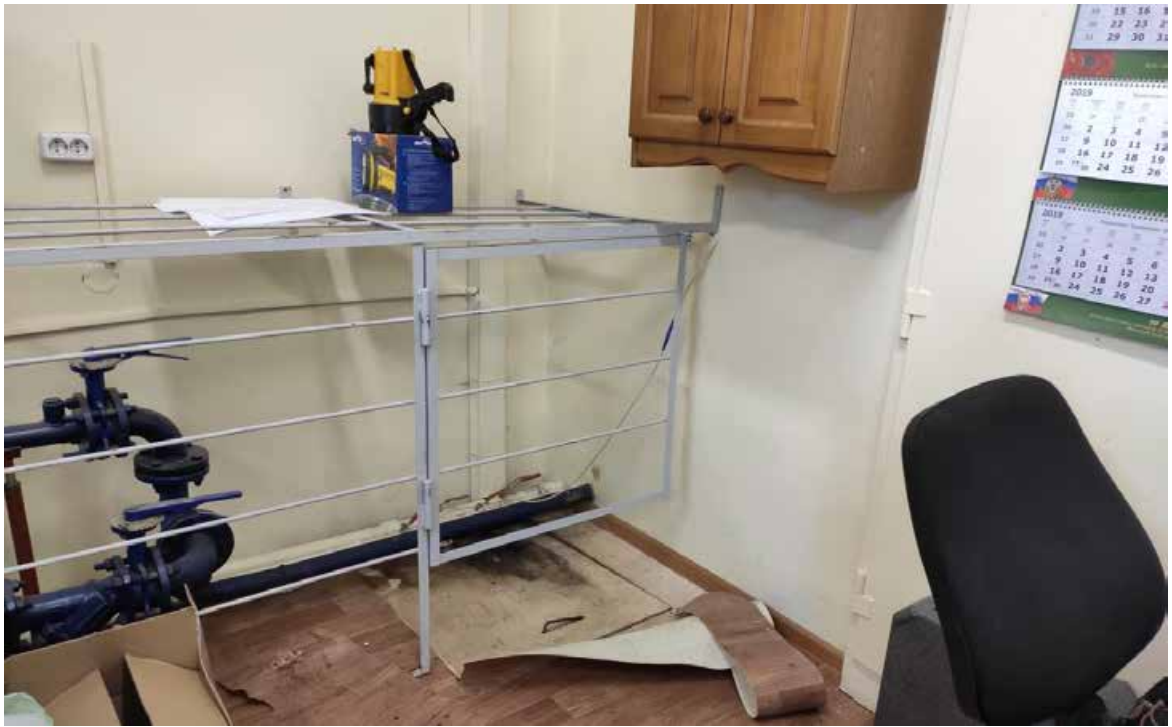
Фото 59. Вид на место существующего выхода сетей и зоны прокладки проектируемых сетей проводного радиовещания из подвала здания и прохождение их в существующем коробе по стенам до чердака (здание Правой Циркумференции).
