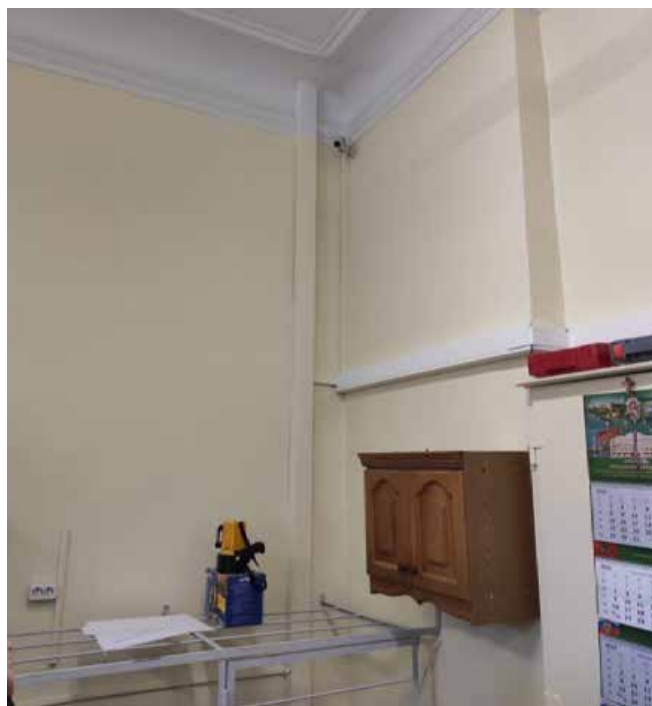
Фото 61. Вид на короб, идущий по стене здания, в котором проложены сети, проектируемая сеть радиовещания запроектирована в существующей канале.
