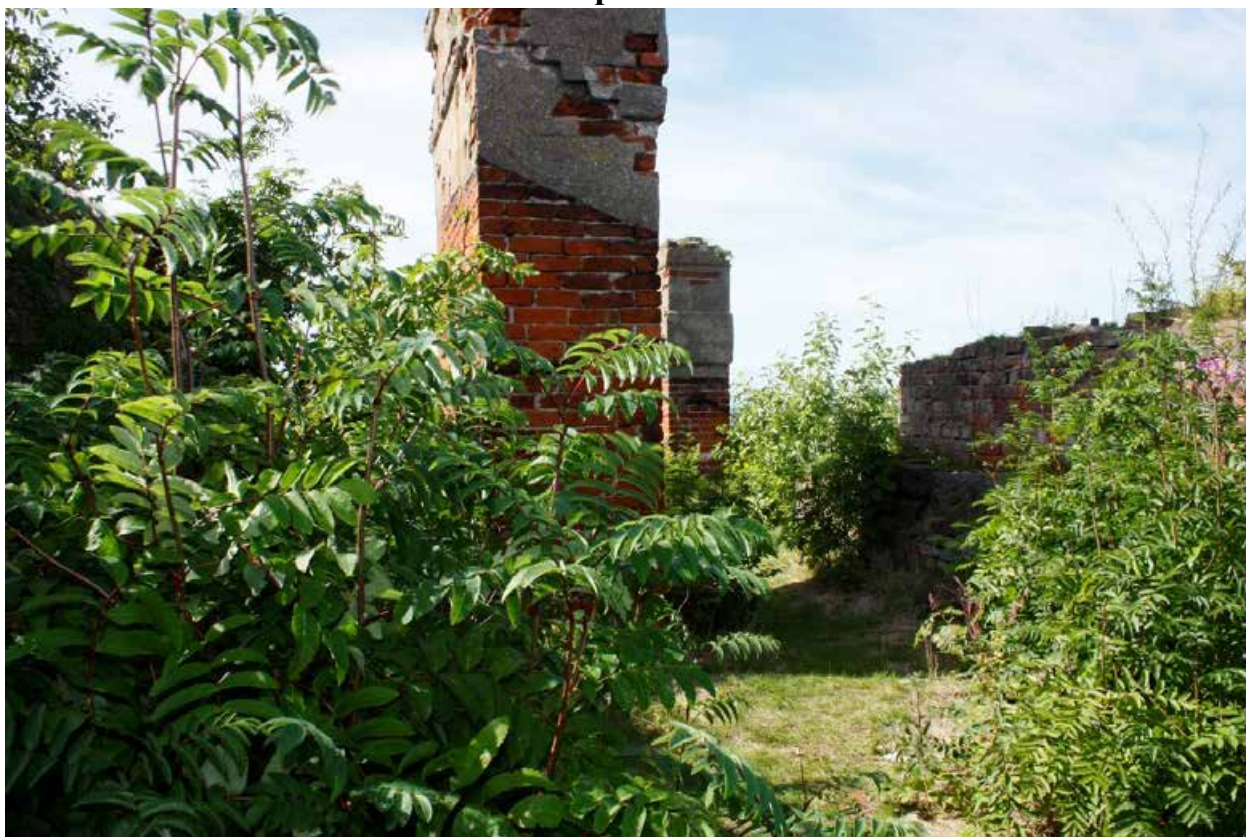
Фото 54. Перекрытие центральной части основного объема. Крыша утрачена. Вид с северо-востока
