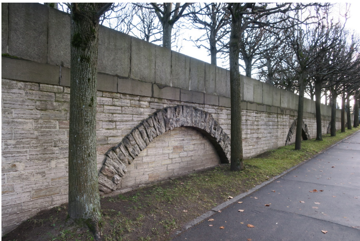
13. Западная подпорная стенка террасы художественно-обособленного участка «Вечный огонь» объекта культурного наследия федерального значения «Кладбище Пискаревское», расположенного по адресу: г. Санкт-Петербург, пр. Непокоренных, д. 72 литера А. Фрагмент. 15.10.2021
