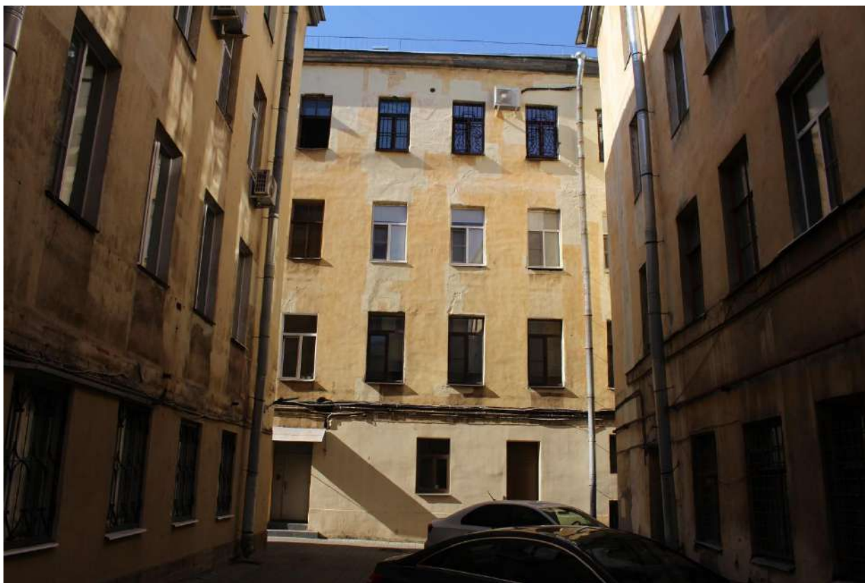
Фото 19. Вид на дворовые фасады объекта культурного наследия федерального значения «Дом, где жили: в 1877-1916 гг. - композитор Направник Э.Ф., в 1882-1908 гг. - композитор Стравинский И.Ф., в 1946-1982 гг. - геолог Наливкин Д.В.».
