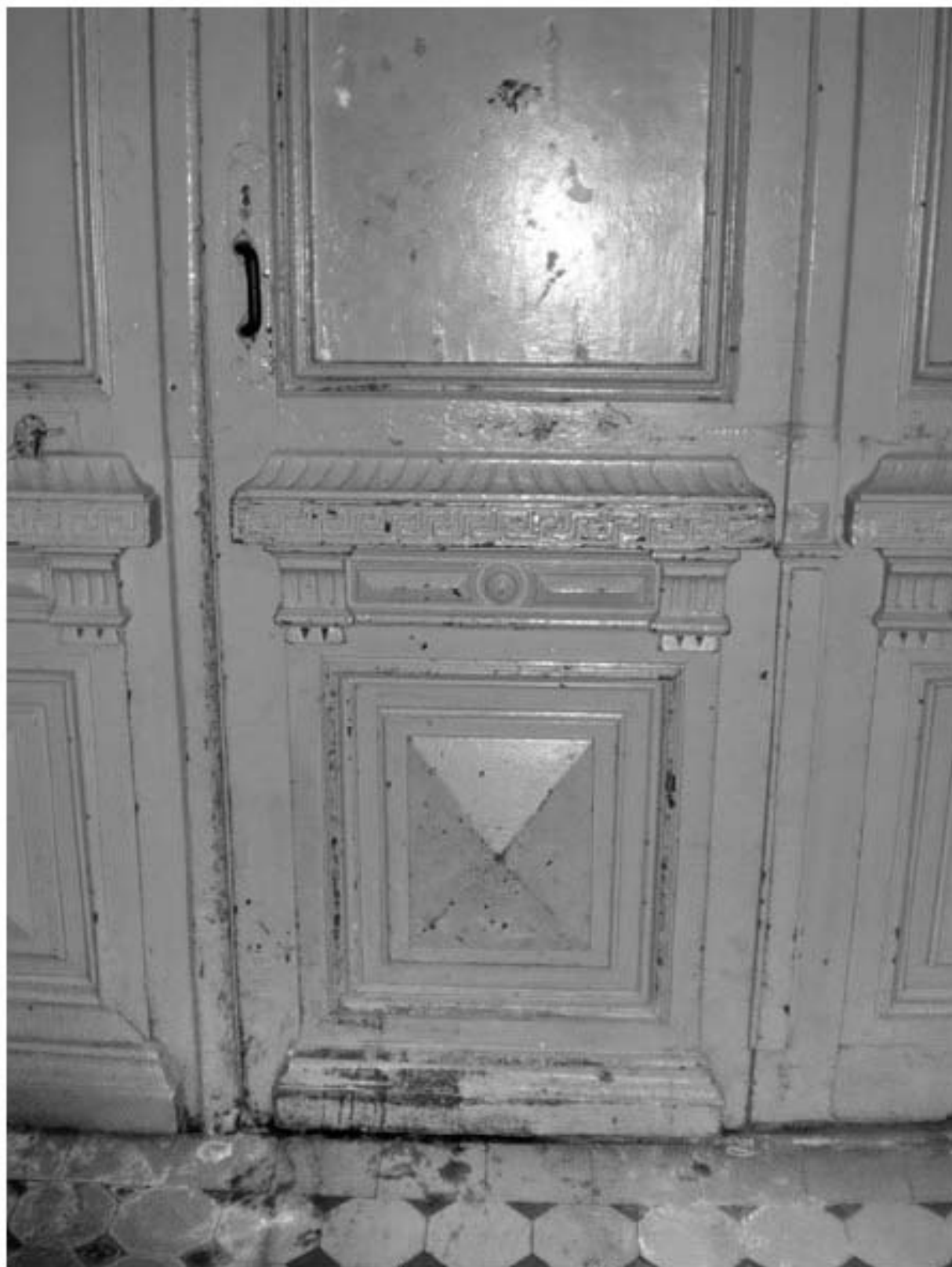
1. 2015 г. Состояние внутренних дверей подъезда № 2 (правый по Мелитопольскому пер.). Вид из тамбура.
