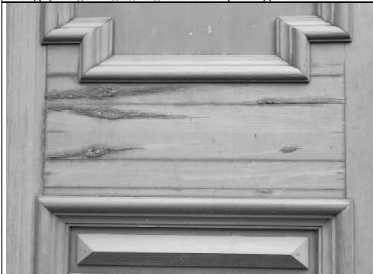
6. Состояние древесины. Дата съемки: 08.11.2025.
