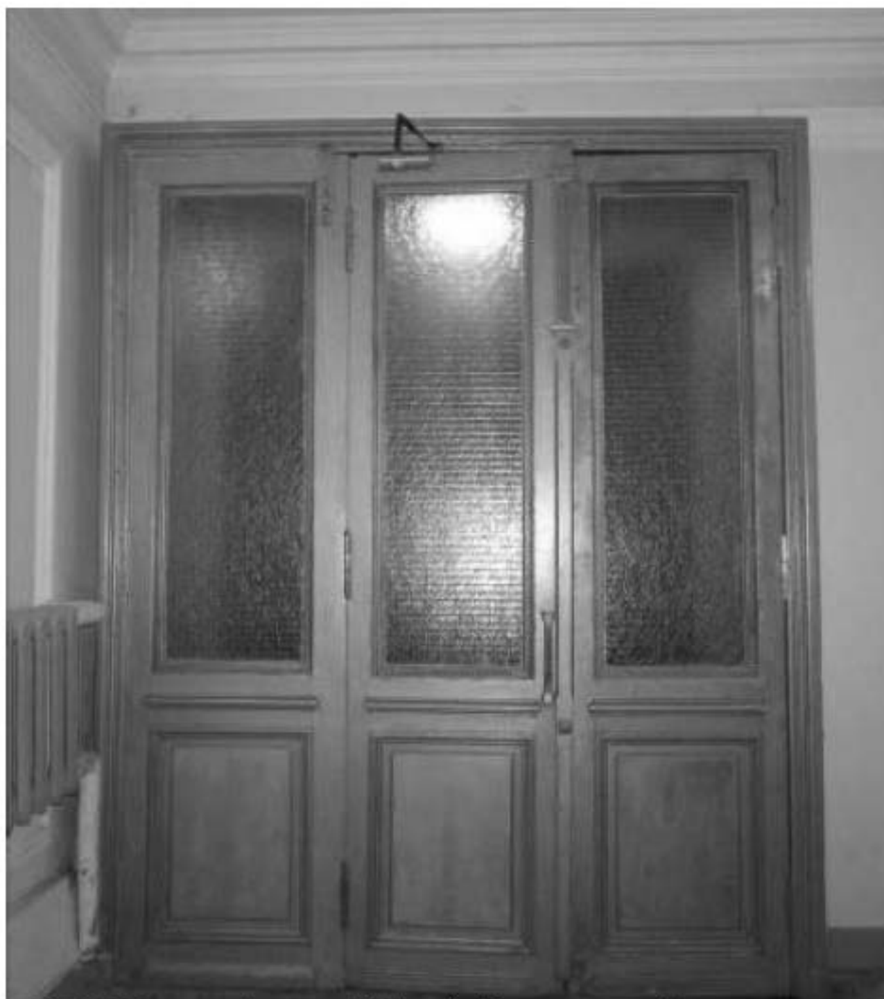
28. 2018 г. Состояние тамбура подъезда № 2 (правый по Мелитопольскому пер.). Вид из подъезда.
