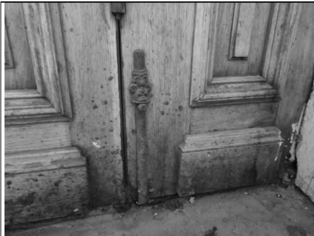
13. Шпингалет на внутренней стороне левой узкой створки. Дата съемки: 08.11.2025.
