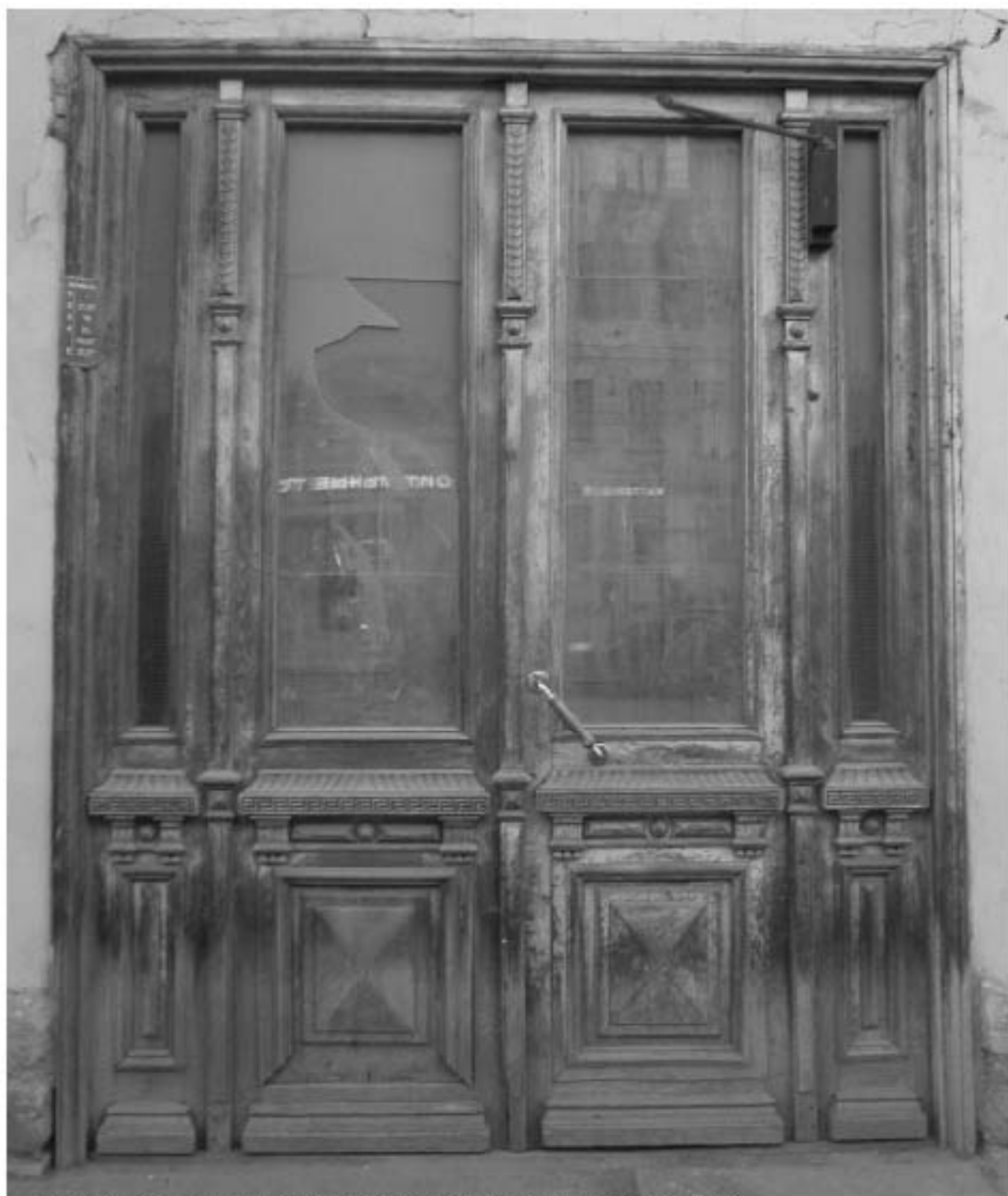
23. 2015 г. Состояние наружных дверей подъезда № 3 (левый по Кировной ул.).
