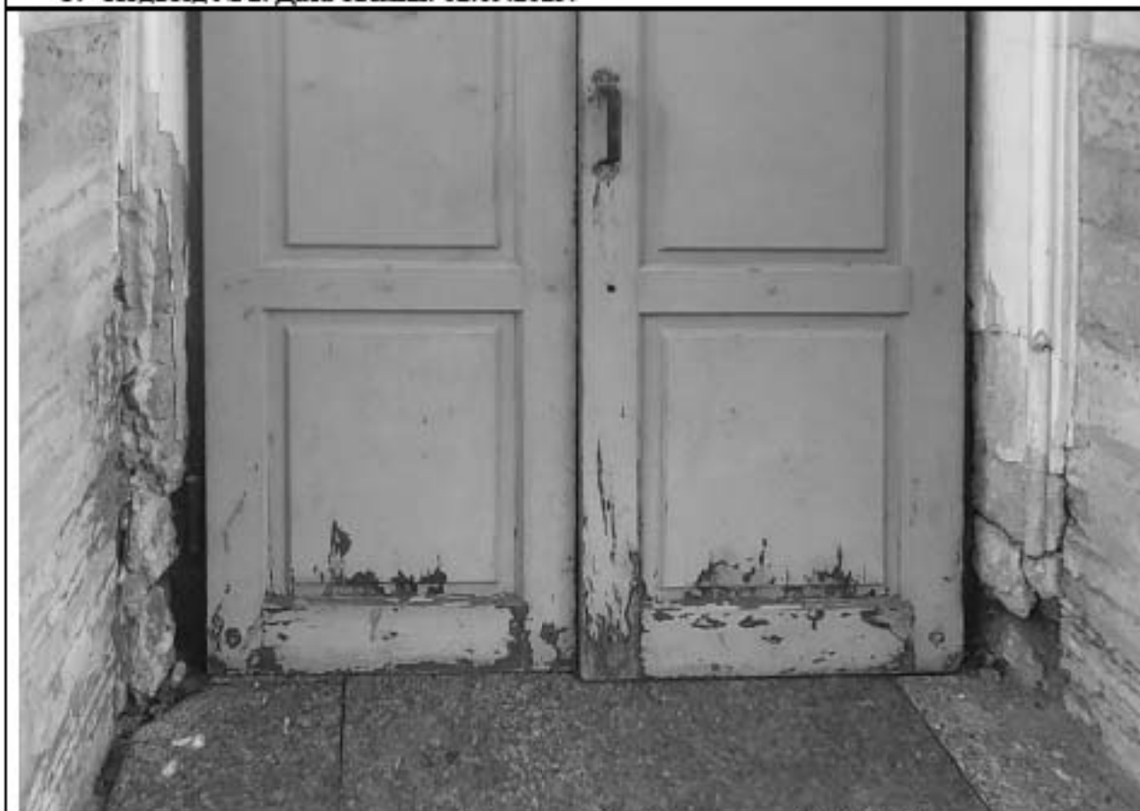
4. Утраты штукатурки откосов. Износ дверей. Дата съемки: 02.09.2025.
