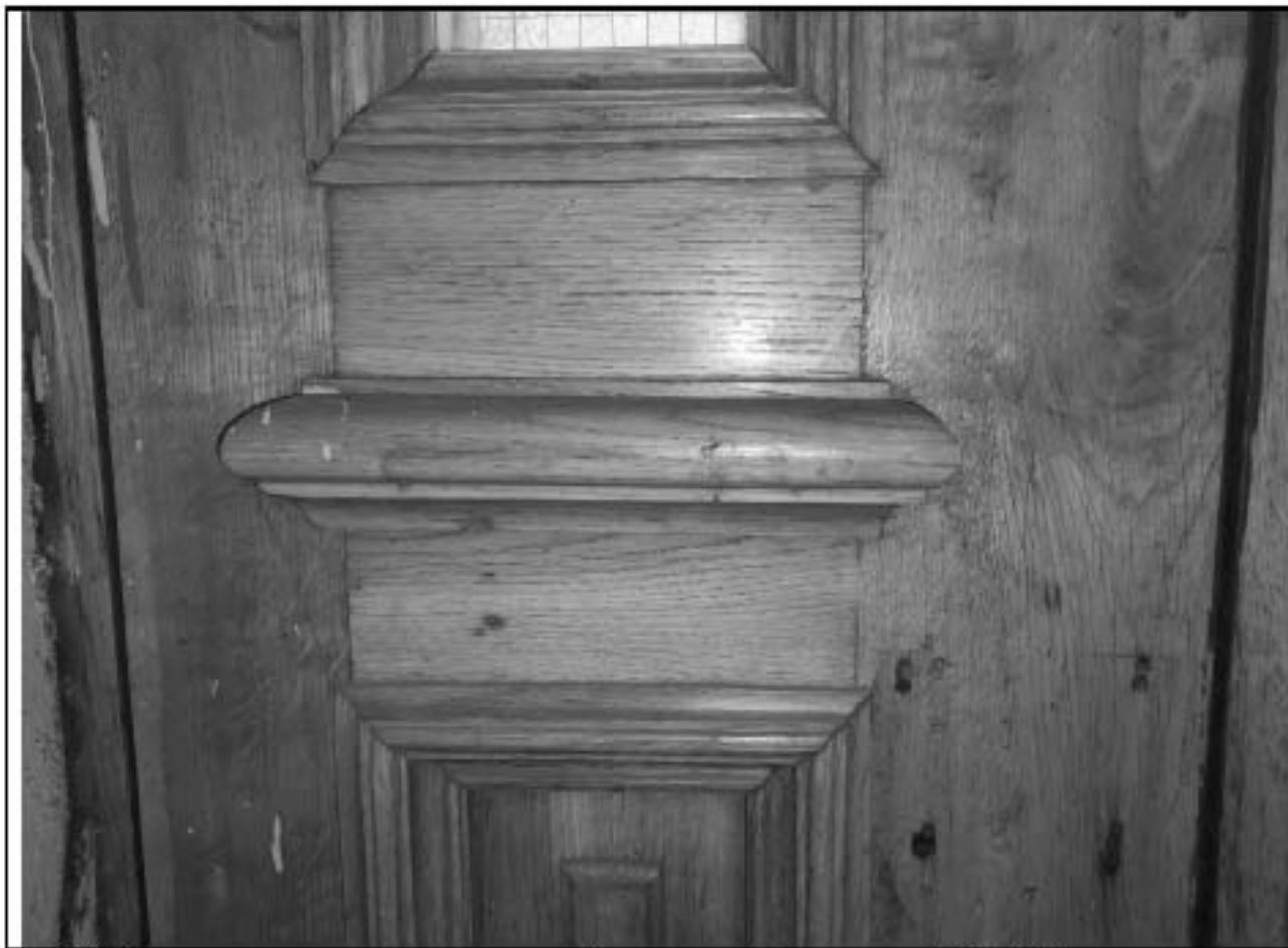
15. Состояние древесины с внутренней стороны. Дата съемки 08.11.2025.
