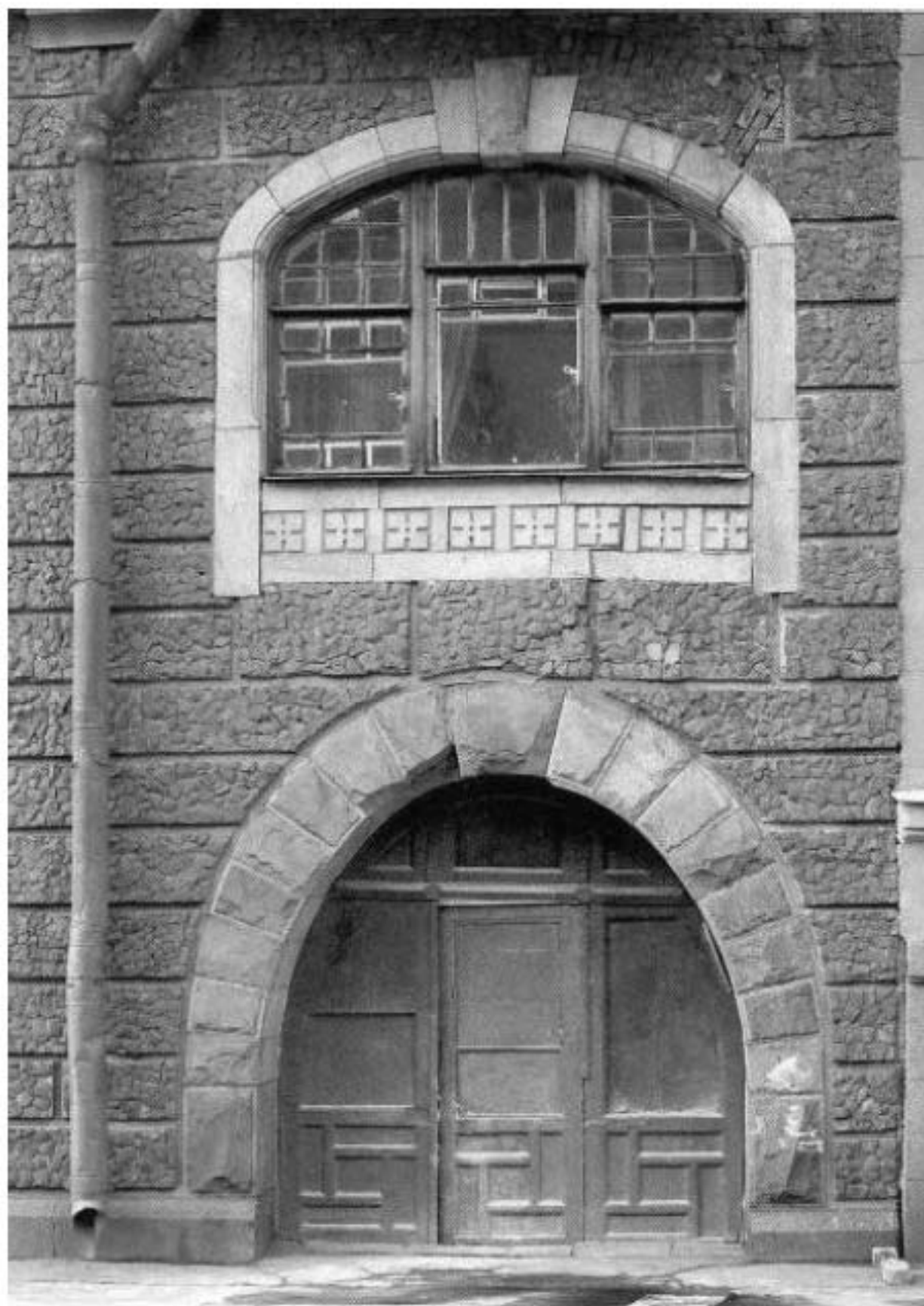
59. 1980-1990-е гг. Вид деревянных дверей подъезда № 2. Столярные заполнения изношены, остекление утрачено, резьба в филенках отсутствует, арка проема имеет трещину в зоне замкового камня.
