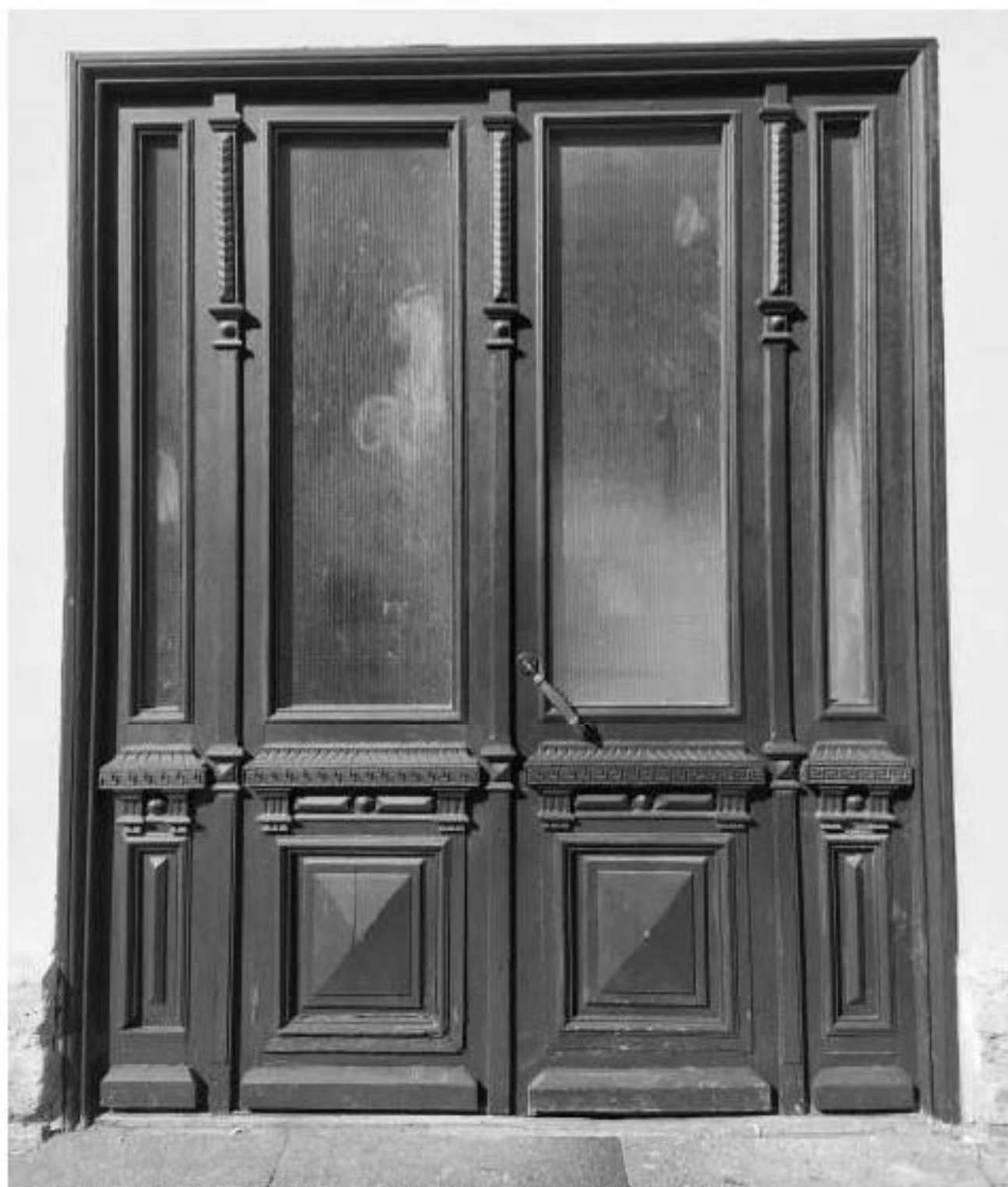
24. 2019 г. Состояние наружных дверей подъезда № 3 (левый по Кировной ул.).
