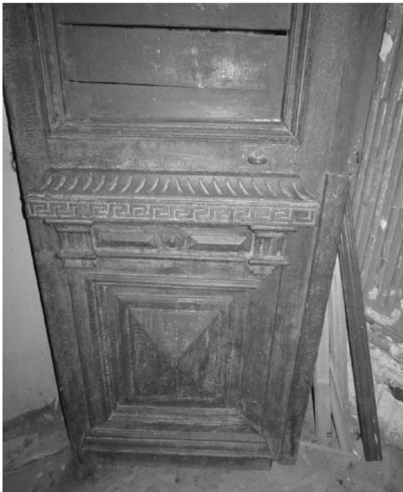
26. 2015 г. Состояние внутренних дверей подъезда № 3 (левый по Кировской ул.). Вид левой створки со стороны тамбура. На 2025 г. створки утрачены, тамбур сохраняется.
