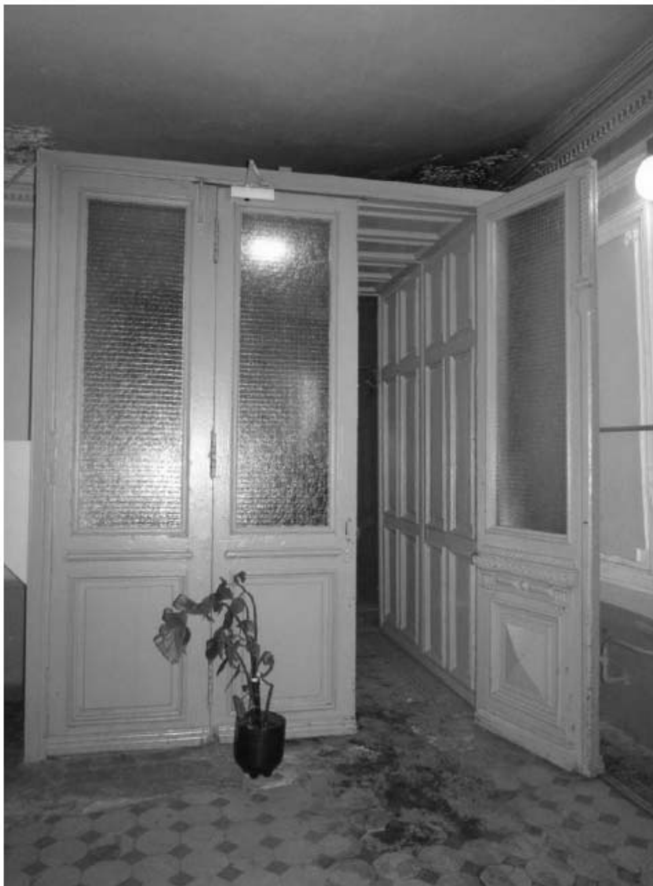
27. 2018 г. Состояние тамбура подъезда № 1 (левый по Мелитопольскому пер.). Вид из подъезда.
