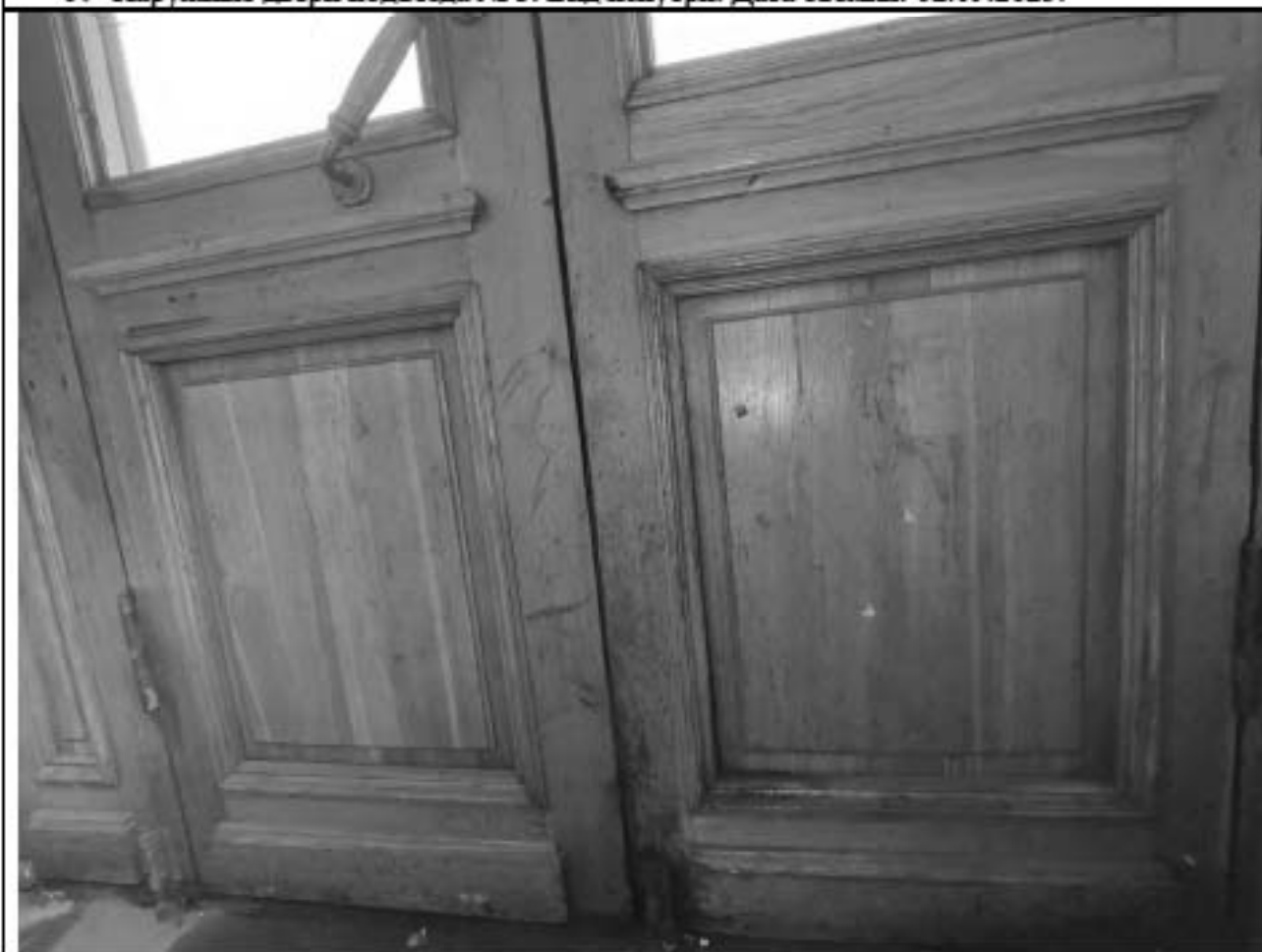
10. Наружные двери подъезда № 3. Вид филенок изнутри. Дата съемки: 08.11.2025.
