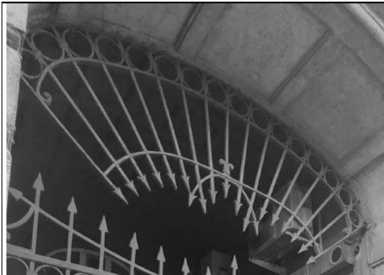
14. Историческое решетчатое заполнение в верхней части арочного проезда. Деформация пик в средней части. Дата съемки: 02.09.2025.
