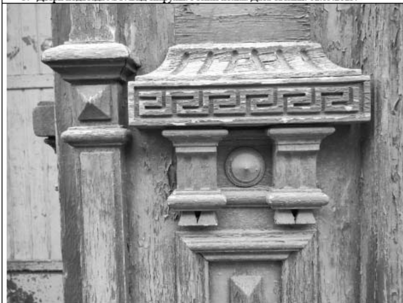
6. Двери подъезда № 3. Вид снаружи. Резная полка. Дата съемки: 08.11.2025.
