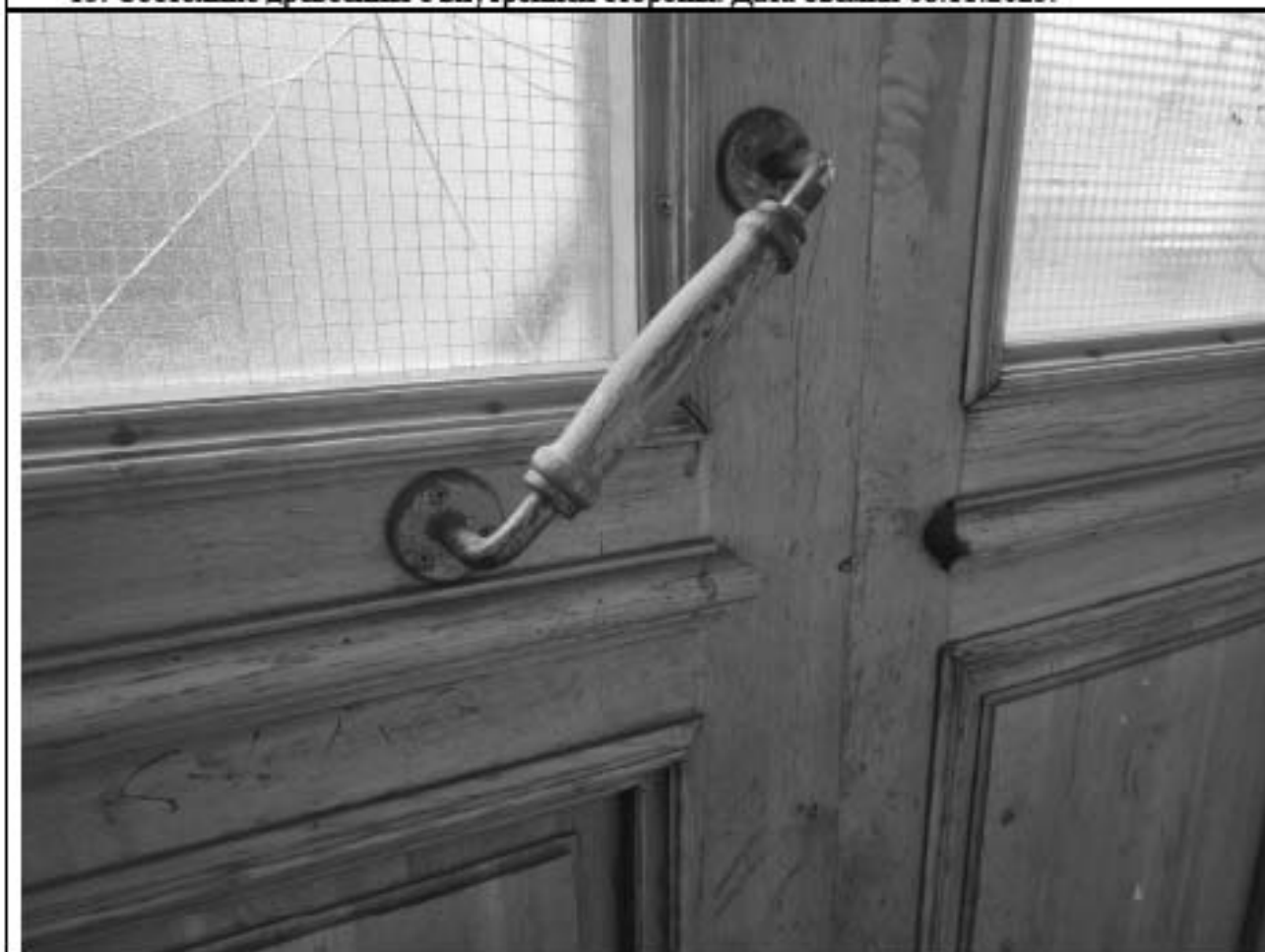
16. Современная ручка. Трещины на стекле. Коррозия и утраты саморезов на штапиках. Дата съемки: 08.11.2025.
