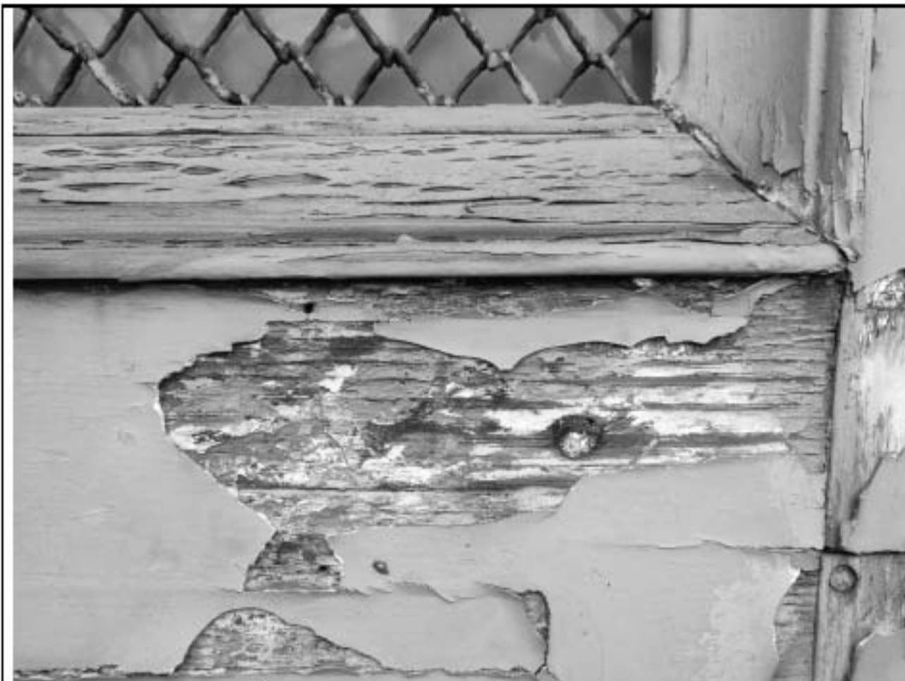
7. Состояние лицевой поверхности, многослойное окрашивание в разные цвета. Утраты красочного слоя. Деструкция шпаклевки в швах. Поздний штапик остекленной филленки. Дата съемки: 08.11.2025.
