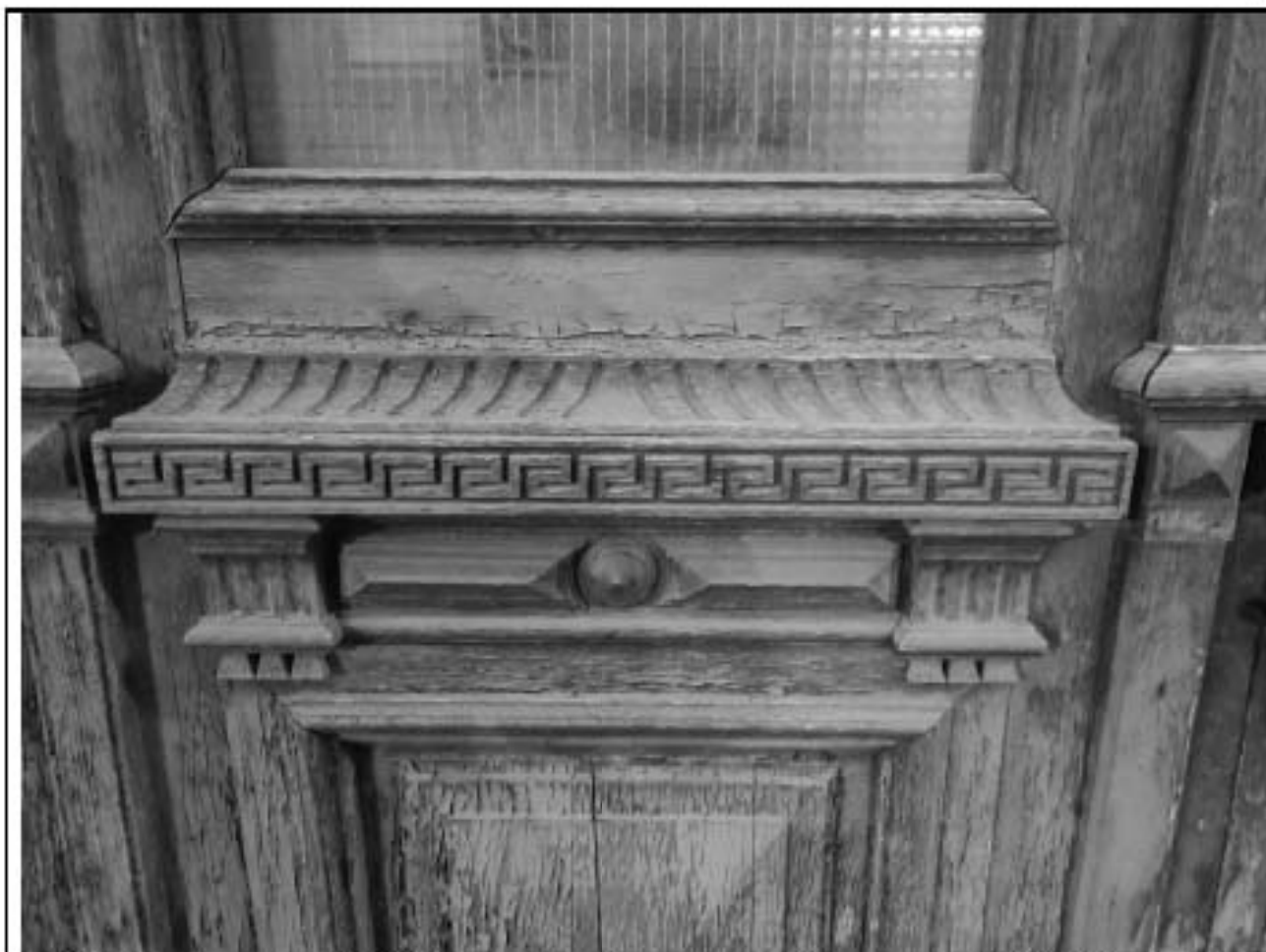
5. Двери подъезда № 3. Вид снаружи. Резная полка. Дата съемки: 02.09.2025.
