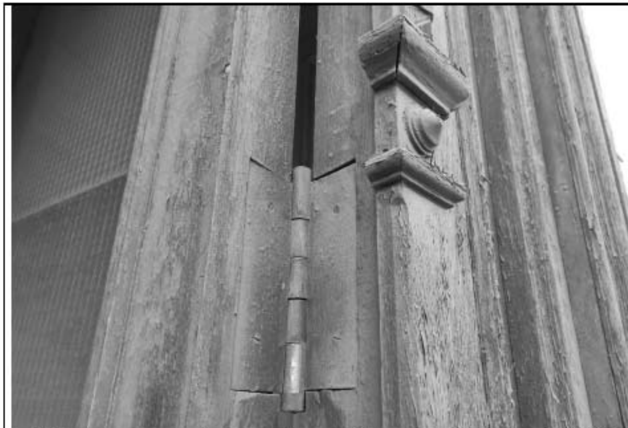
17. Верхняя петля правой центральной створки. Вид снаружи. Дата съемки: 08.11.2025.
