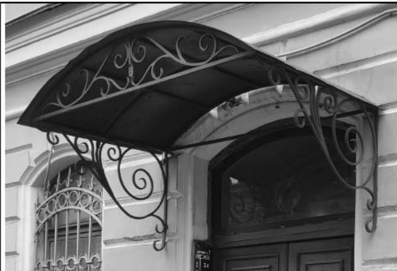
7. Подъезд № 2. Вид козырька справа. Дата съемки: 04.09.2025.
