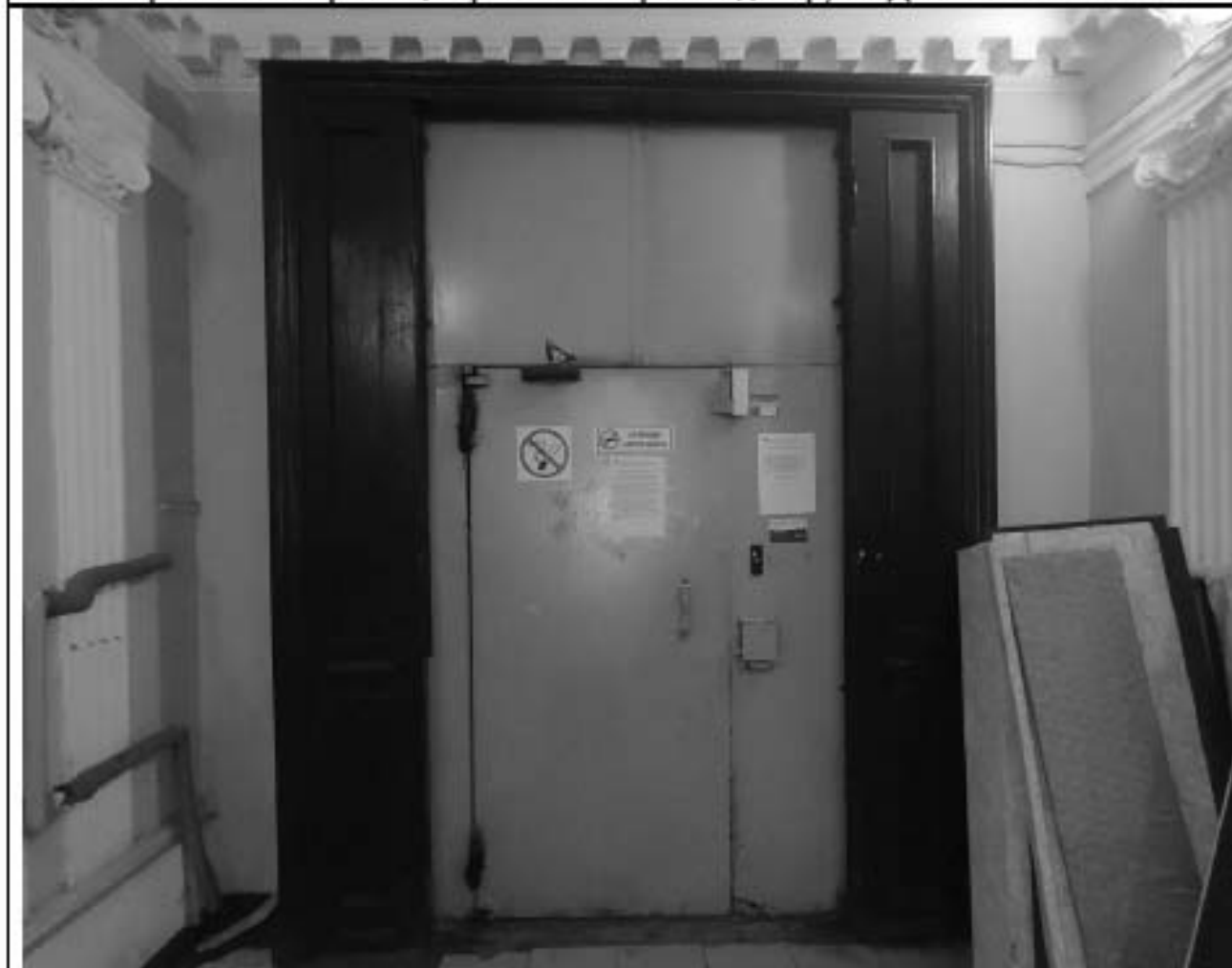
18. Подъезд № 3. Вид тамбура изнутри. Внутренние двери утрачены. Дата съемки: 02.09.2025.
