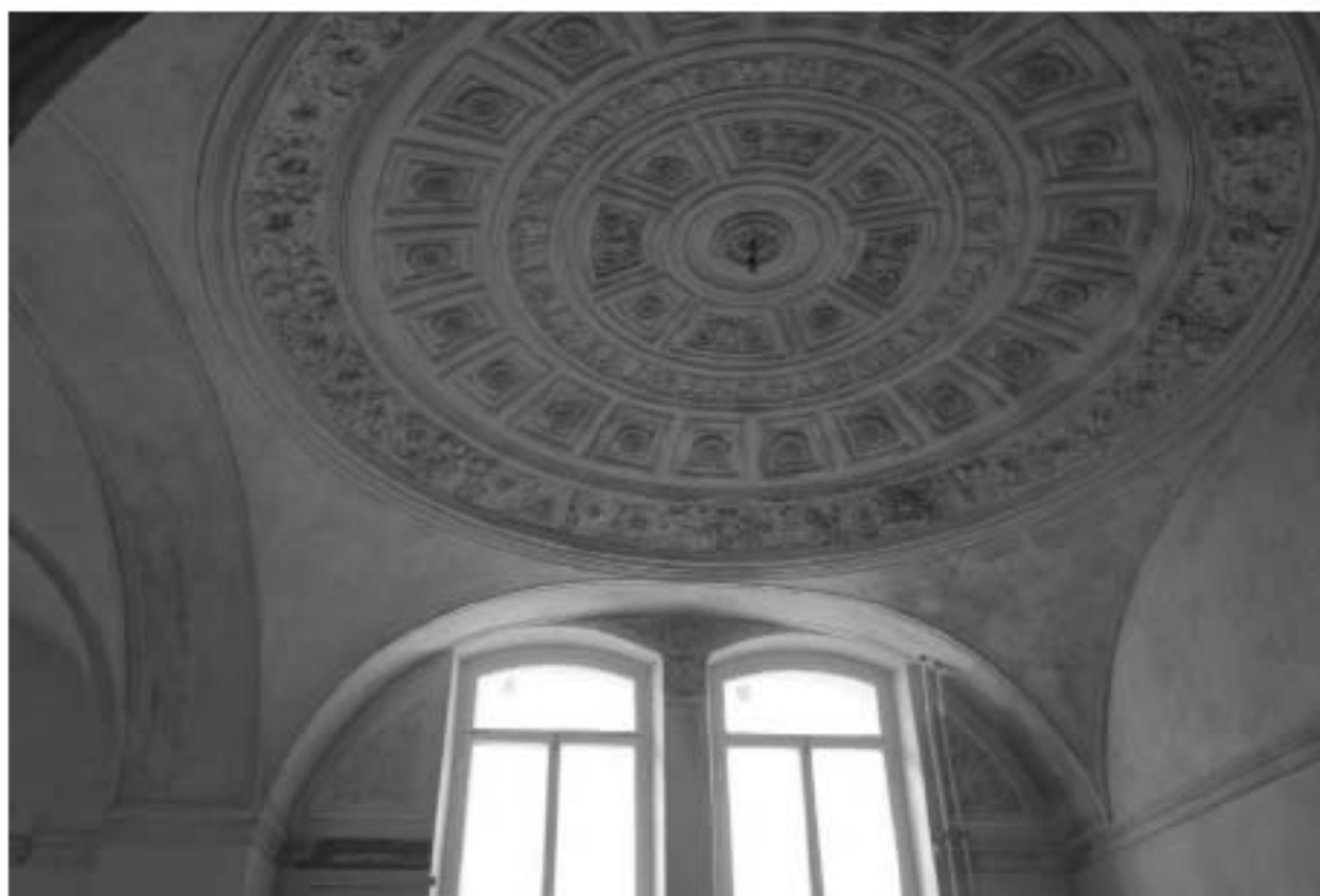
25. Объект культурного наследия федерального значения «Дом Брюллова А.П. (Сюзора П.Ю.)» по адресу: Санкт-Петербург, Кадетская линия В.О., дом 21, литера А.
