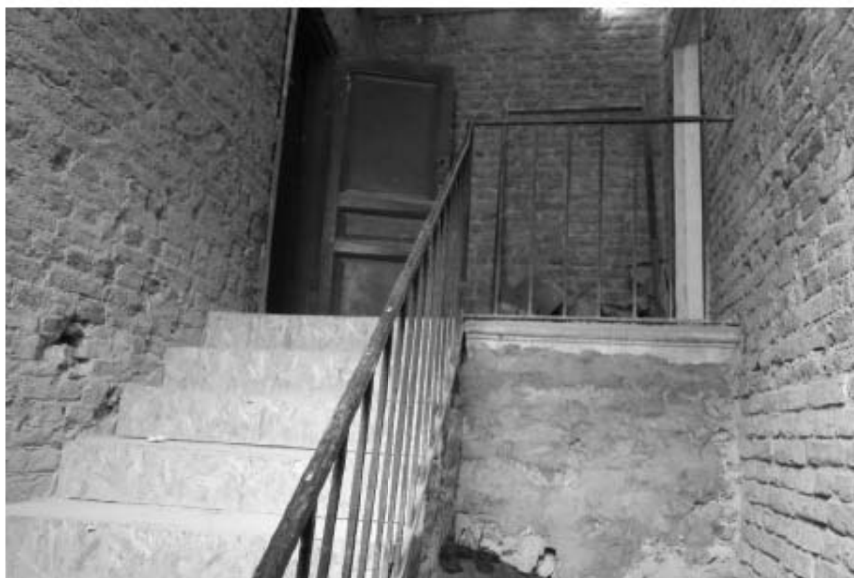
50. Объект культурного наследия федерального значения «Дом Брюллова А.П. (Сюзора П.Ю.)» по адресу: Санкт-Петербург, Кадетская линия В.О., дом 21, литера А.
