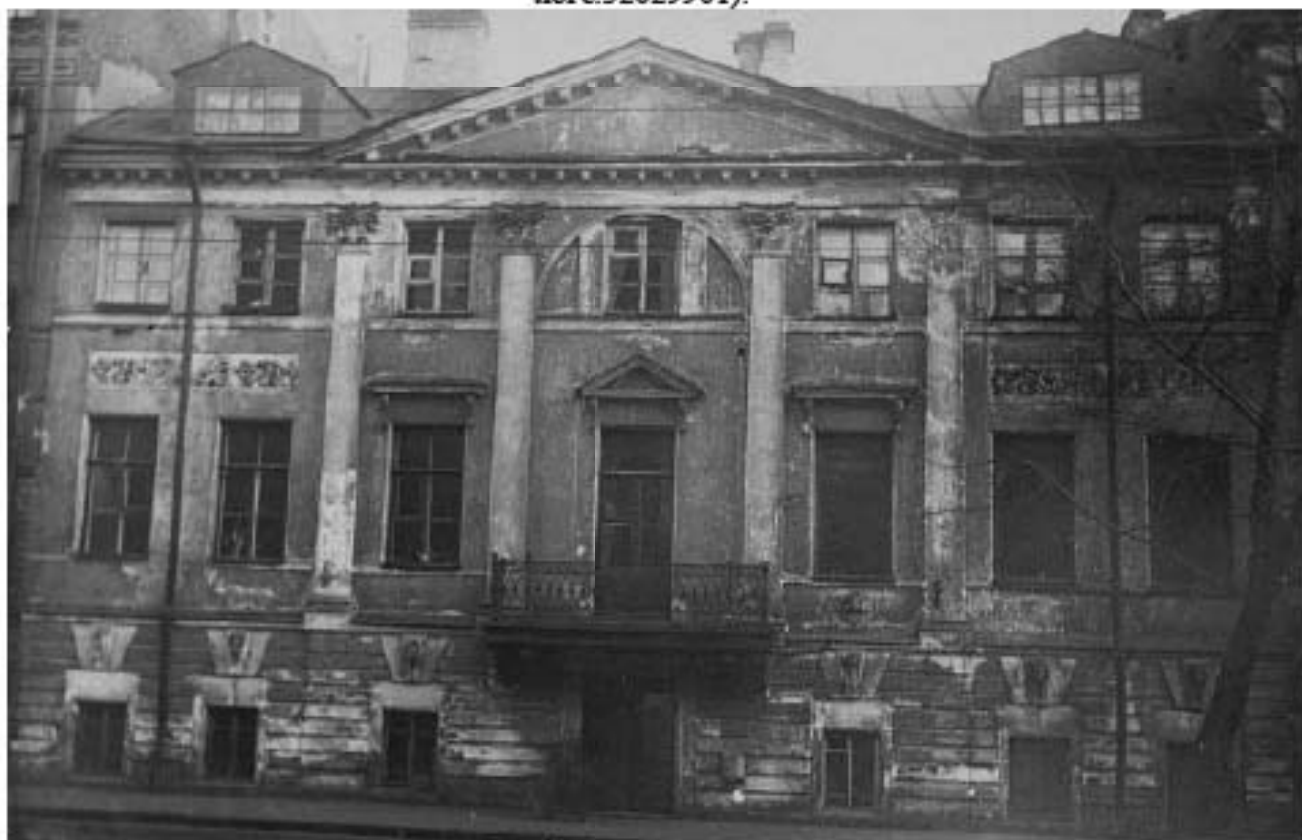
Илл. 58. Дом Брюллова. Уличный фасад. Период создания: 1938 г. // https://goskatalog.ru/portal/#/collections?id=37749452 (номер в Госкаталоге: 37537365)
