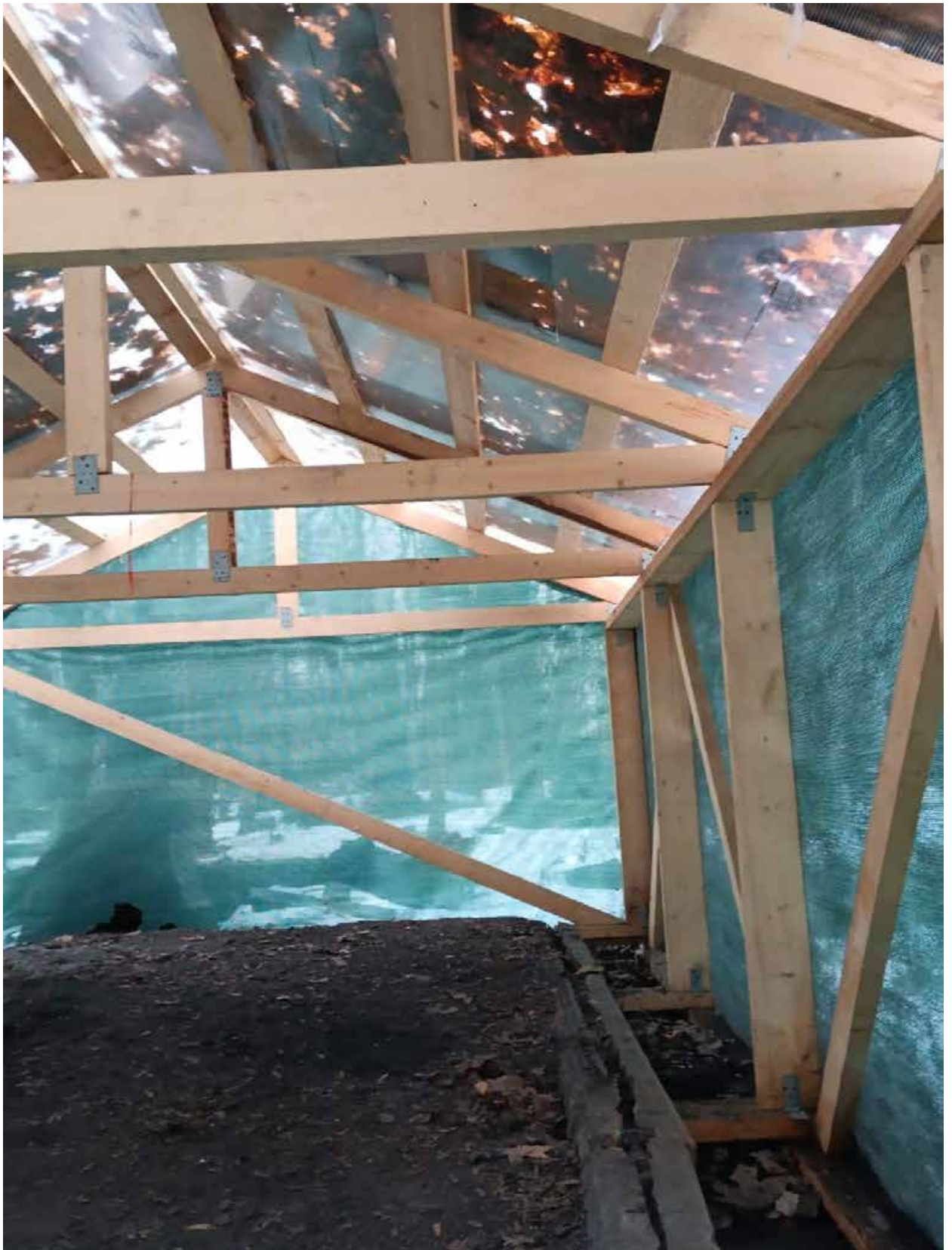
Фото 5. Объект культурного наследия регионального значения «Смоленское лютеранское кладбище». Могила генерал-майора А. фон Бекмана (1807-1833), предмет охраны объекта культурного наследия. Фрагмент временного защитного ограждения в виде деревянного каркаса, обшитого защитными материалами. Конструкции беседки, крыши, мощения демонтированы, находятся в мастерской для проведения реставрационных работ.
