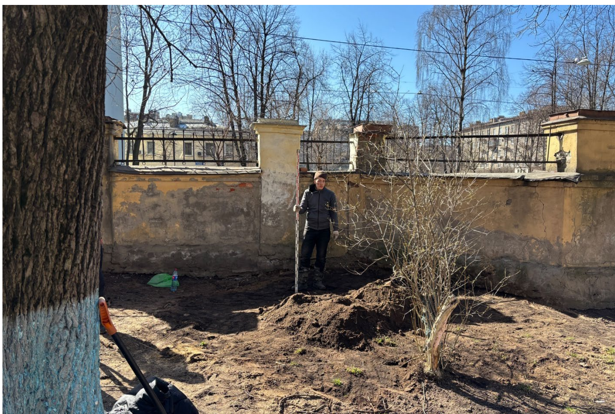
Рис. 62. ОАН «Участок культурного слоя Санкт-Петербурга XVIII –начала XIX в., по адресу: Санкт- Петербург, 14-я линия В.О., дом 57-61». Шурф №2. Общий вид после рекультивации. Вид с востока
