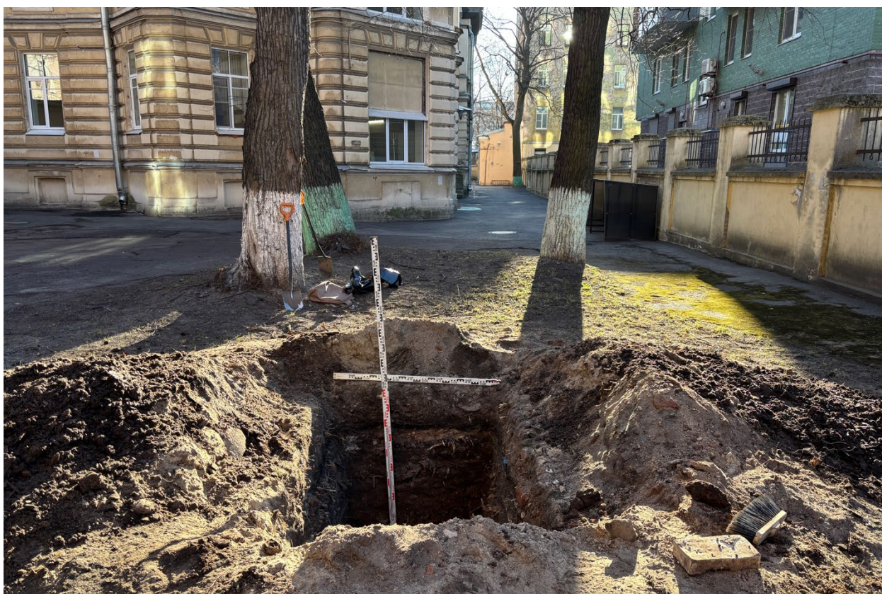
Рис. 64. ОАН «Участок культурного слоя Санкт-Петербурга XVIII –начала XIX в., по адресу: Санкт- Петербург, 14-я линия В.О., дом 57-61». Шурф №3. Вид выкопанного шурфа. Вид с востока
