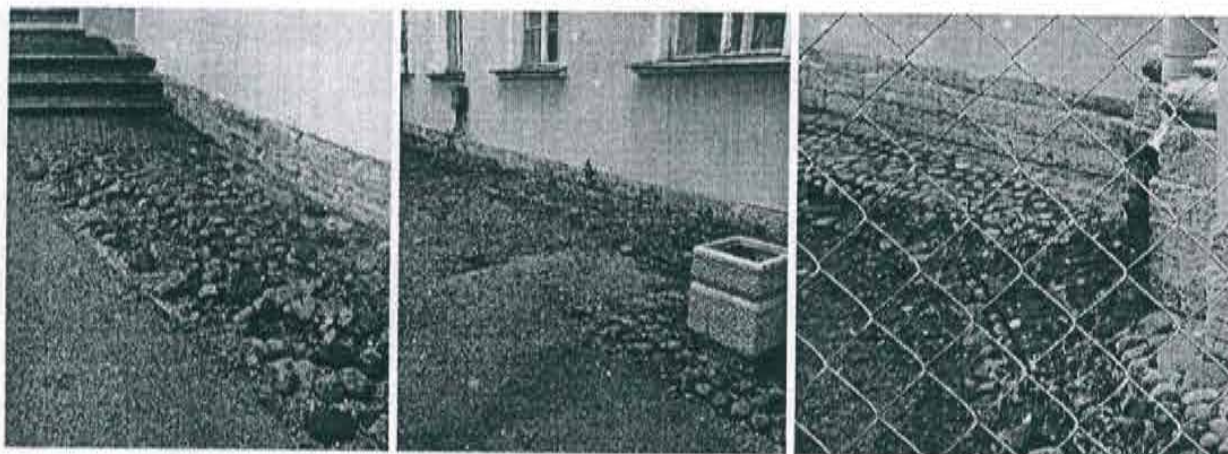
Фото 33, 34, 35. Состояние отмостки со стороны южных фасадов объекта культурного наследия
