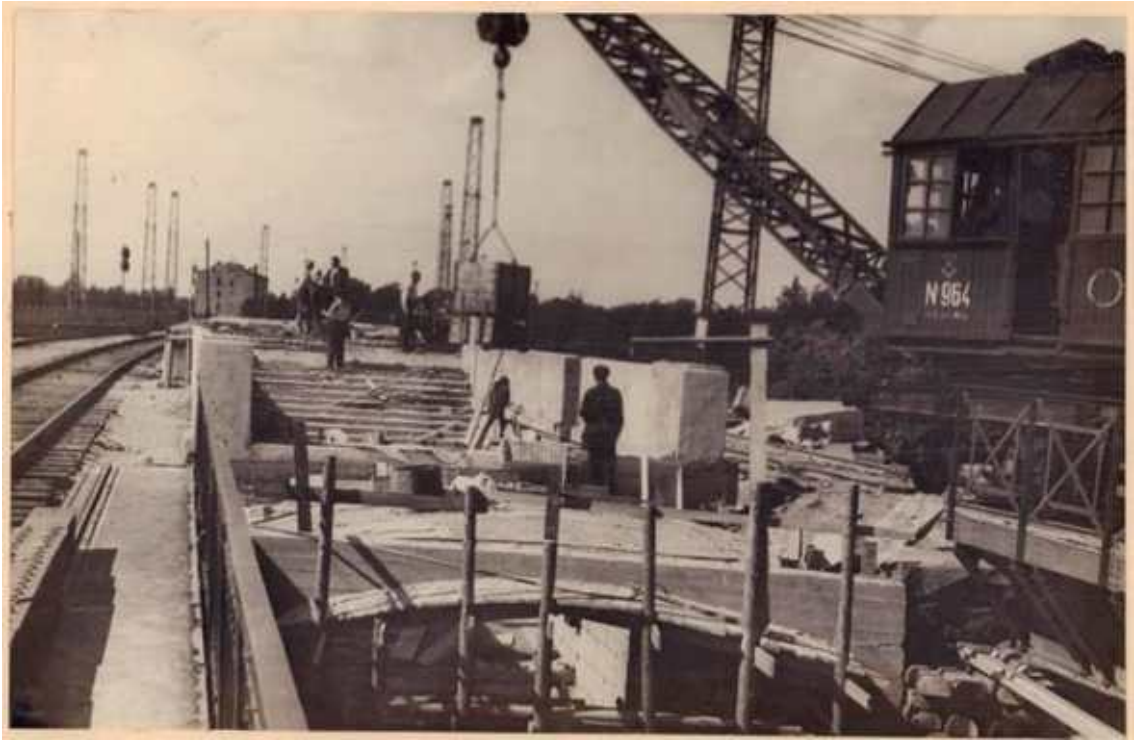
27. Станция Ланская. Строительство высокой пассажирской платформы №1 перед запуском движения электропоездов на участке Ленинград-Зеленогорск в 1951 году. // URL: https://terijoki.spb.ru/%2F/photos/picture.php?/105351/category/2082 (дата обращения: 10.02.2026).
