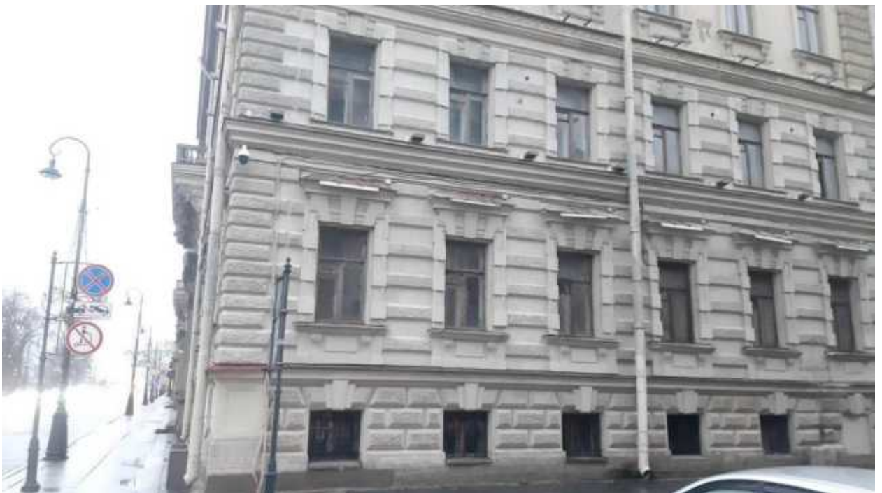
54. «Здания Государственного Дворянского земельного банка» (Адмиралтейская наб., д. 12-14, лит. А). Лицевой фасад по Черноморскому пер. (фрагмент). Фото мест установки оборудования и прокладки кабельных трасс. Штиглиц М.С. 22.12.2025.
