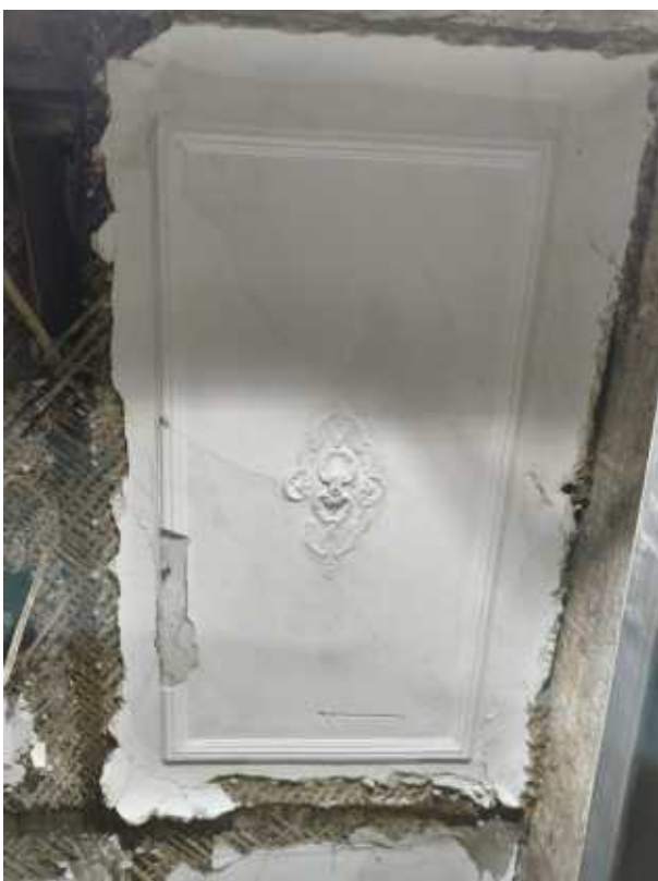
20. «Дом Е.С. и М.Б. Трофимовых», ул. Бронницкая, д. 1-3, лит. А. Второй этаж. Фрагмент. Фото 24.10.2025г.
