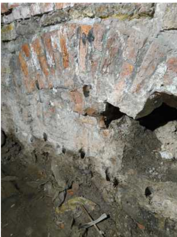
8. «Дом Е.С. и М.Б. Трофимовых», ул. Бронницкая, д. 1-3, лит. А. Цокольный этаж. Фрагмент. Фото 24.10.2025г.
