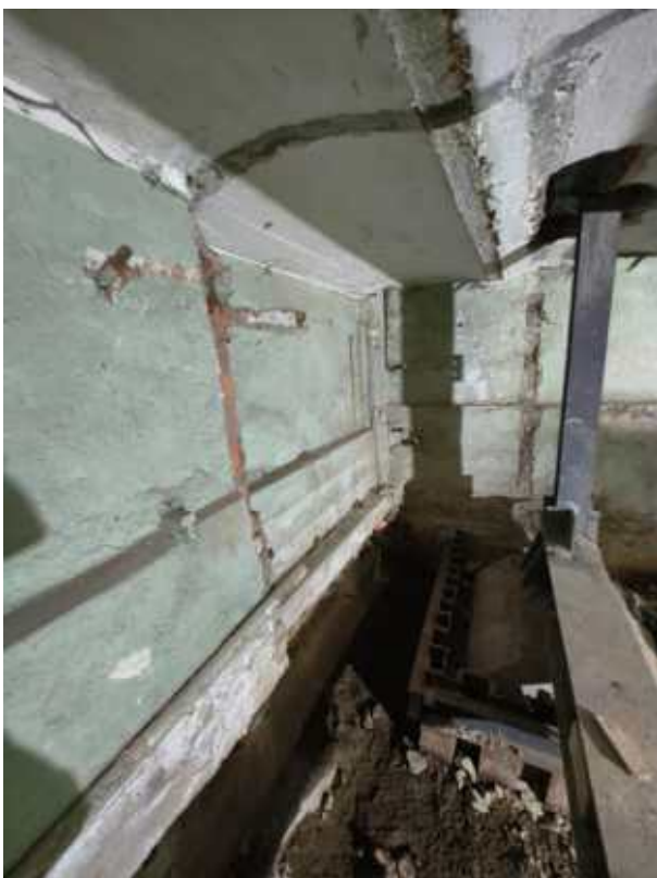
7. «Дом Е.С. и М.Б. Трофимовых», ул. Бронницкая, д. 1-3, лит. А. Цокольный этаж. Фрагмент. Фото 24.10.2025г.
