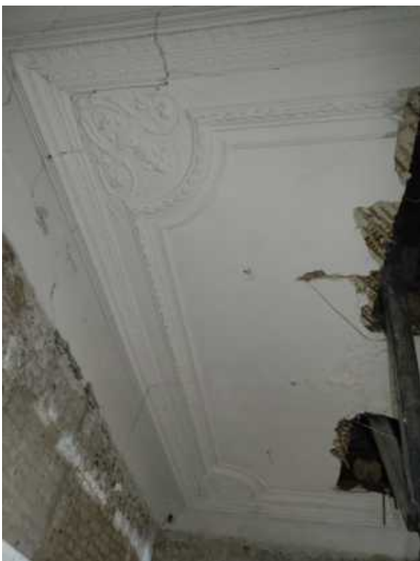
21. «Дом Е.С. и М.Б. Трофимовых», ул. Бронницкая, д. 1-3, лит. А. Второй этаж. Фрагмент. Фото 24.10.2025г.
