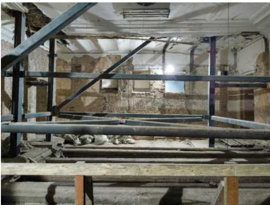
17. «Дом Е.С. и М.Б. Трофимовых», ул. Бронницкая, д. 1-3, лит. А. Второй этаж. Фрагмент. Фото 24.10.2025г.
