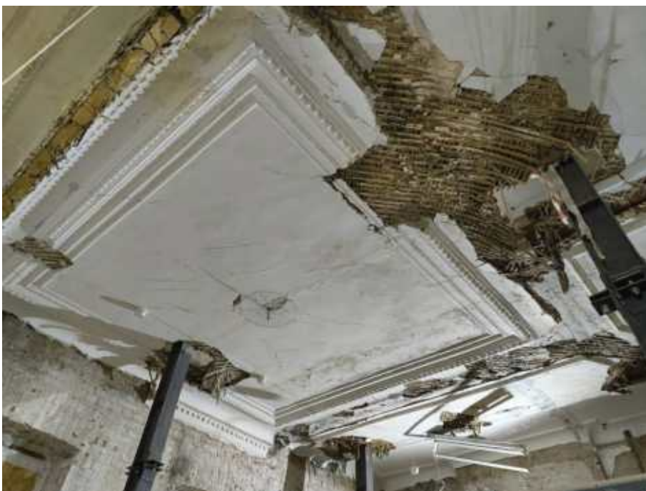
19. «Дом Е.С. и М.Б. Трофимовых», ул. Бронницкая, д. 1-3, лит. А. Второй этаж. Фрагмент. Фото 24.10.2025г.
