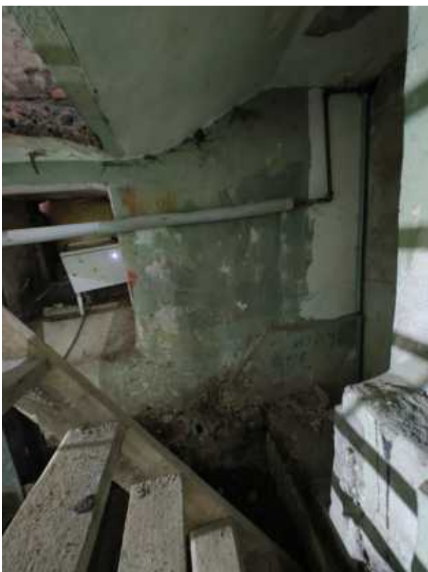
9. «Дом Е.С. и М.Б. Трофимовых», ул. Бронницкая, д. 1-3, лит. А. Цокольный этаж. Фрагмент. Фото 24.10.2025г.
