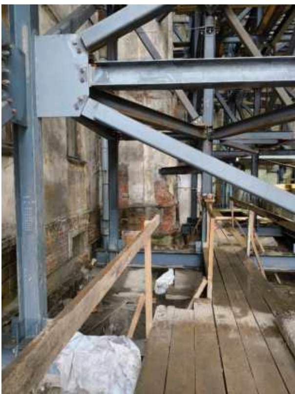
6. «Дом Е.С. и М.Б. Трофимовых», ул. Бронницкая, д. 1-3, лит. А. Цокольный этаж. Фрагмент. Фото 24.10.2025г.
