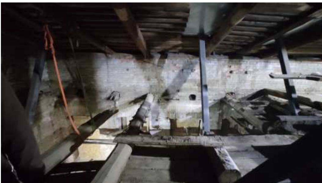
29. «Дом Е.С. и М.Б. Трофимовых», ул. Бронницкая, д. 1-3, лит. А. Чердак. Фрагмент. Фото 24.10.2025г.
