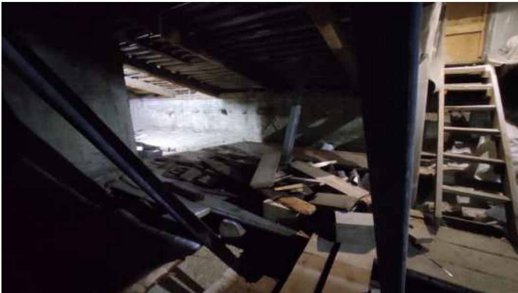
27. «Дом Е.С. и М.Б. Трофимовых», ул. Бронницкая, д. 1-3, лит. А. Чердак. Фрагмент. Фото 24.10.2025г.
