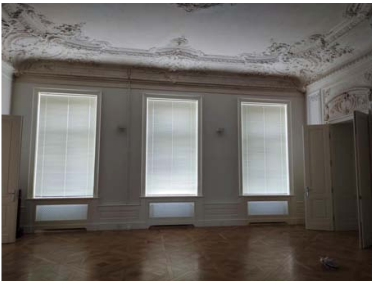
33. ОКН регионального значения «Жилой дом страхового общества “Россия” с садом и оградами» (г. Санкт-Петербург, Моховая ул., 27-29). Квартира № 37.
