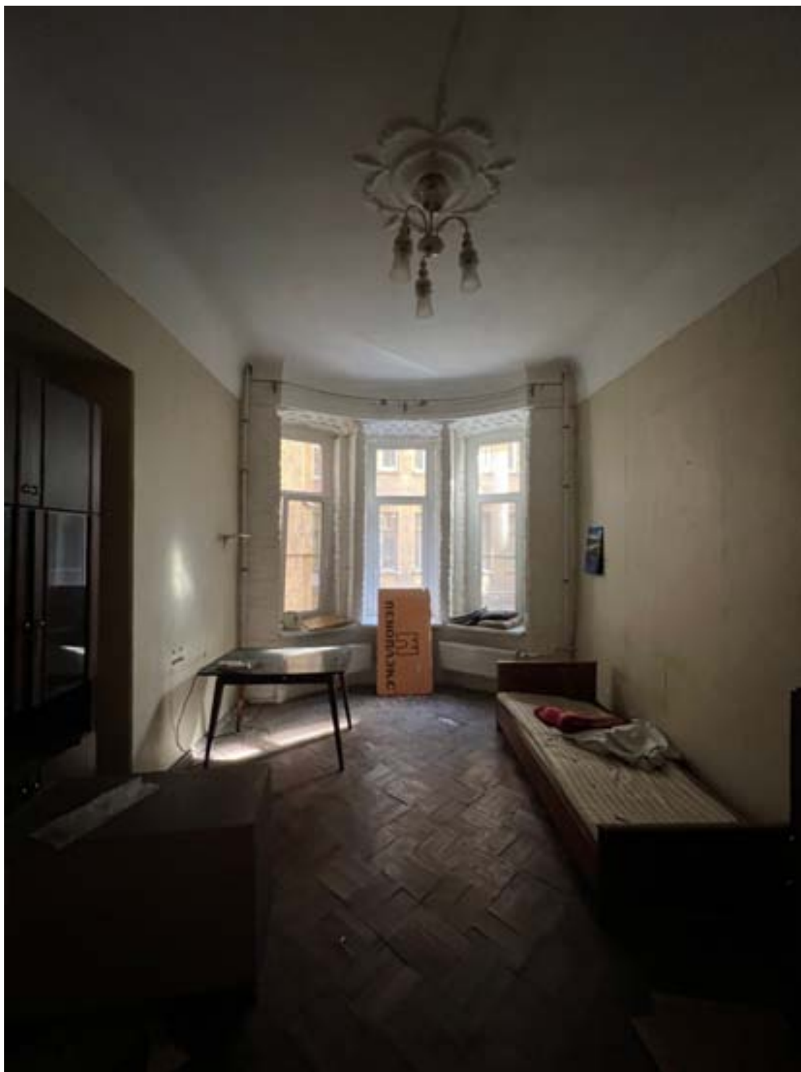
24. «Дом И.М. Екимова». Санкт-Петербург, ул.Кирочная, д.6, литера А. Фрагмент помещения кв.№3 (6-Н) Фото: 19.01.2026.
