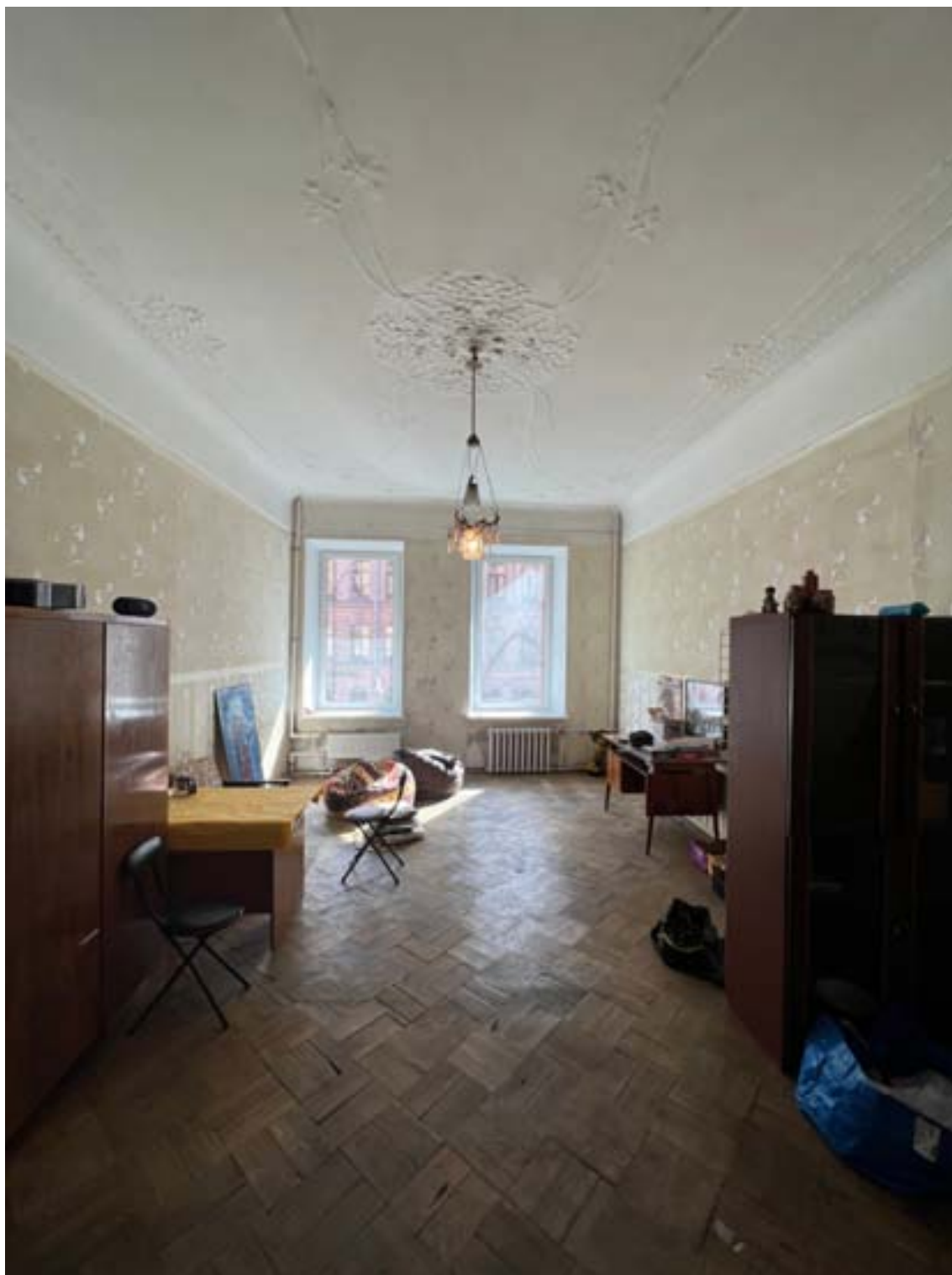
15. «Дом И.М. Екимова». Санкт-Петербург, ул.Кирочная, д.6, литера А. Фрагмент помещения кв.№3 (15-Н) Фото: 19.01.2026.
