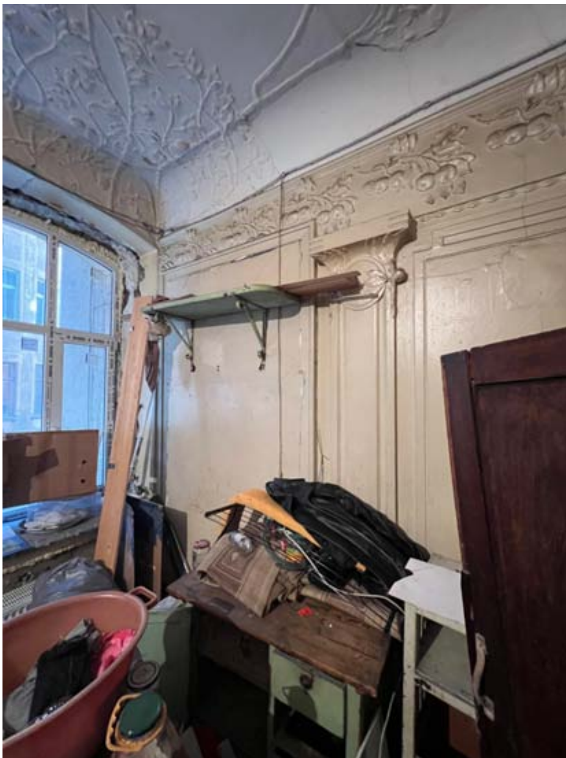
23. «Дом И.М. Екимова». Санкт-Петербург, ул.Кирочная, д.6, литера А. Фрагмент помещения кв.№3 (4-Н) Фото: 19.01.2026.
