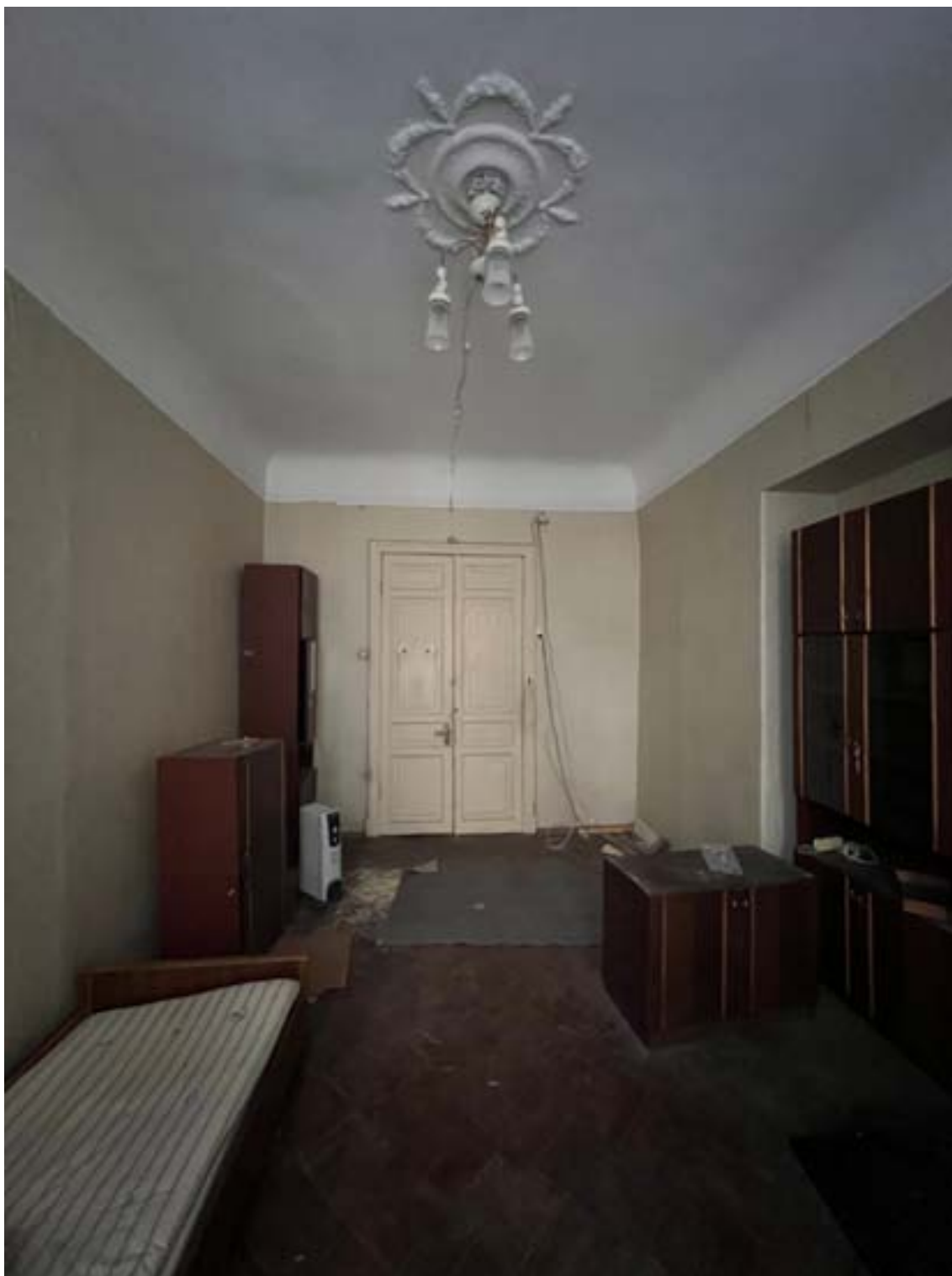
25. «Дом И.М. Екимова». Санкт-Петербург, ул.Кирочная, д.6, литера А. Фрагмент помещения кв.№3 (6-Н) Фото: 19.01.2026.
