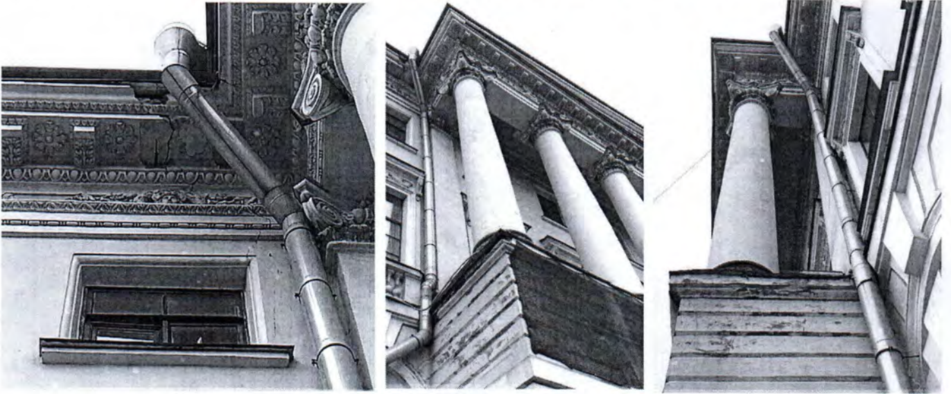
23-27. Дефекты восточного лицевого фасада по Марсовому полю (17.11.2021).
