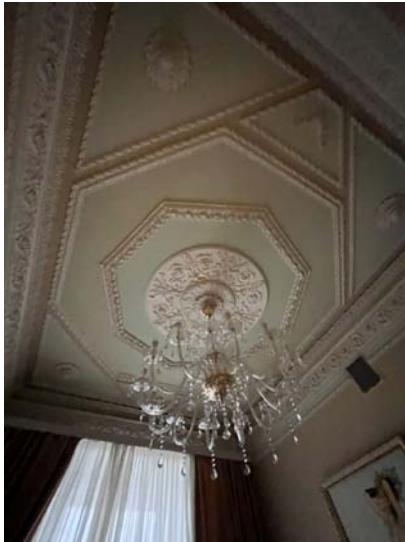
Фото №24. Квартира №263, пом. 16 (потолок).
