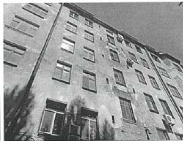
Фото 58. Фрагмент дворового фасада внешнего контура. Балконы в уровне 4 и 6 этажей черной лестничной клетки (где расположены квартиры №№ 156, 157) отсутствуют. Выполнена закладка нижней части указанных проемов блоками из газобетона. Взамен балконных дверей установлены окна
