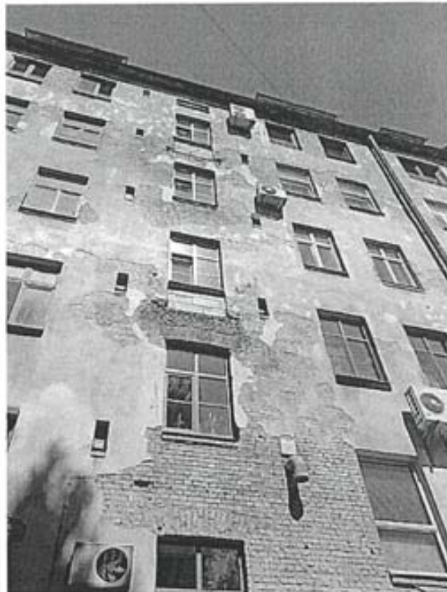
Фото 56. Фрагмент дворового фасада. Балконы в уровне 4 и 6 этажей черной лестничной клетки (где расположены квартиры №№ 156, 157) отсутствуют. Выполнена закладка нижней части указанных проемов блоками из газобетона. Взамен балконных дверей установлены окна.
