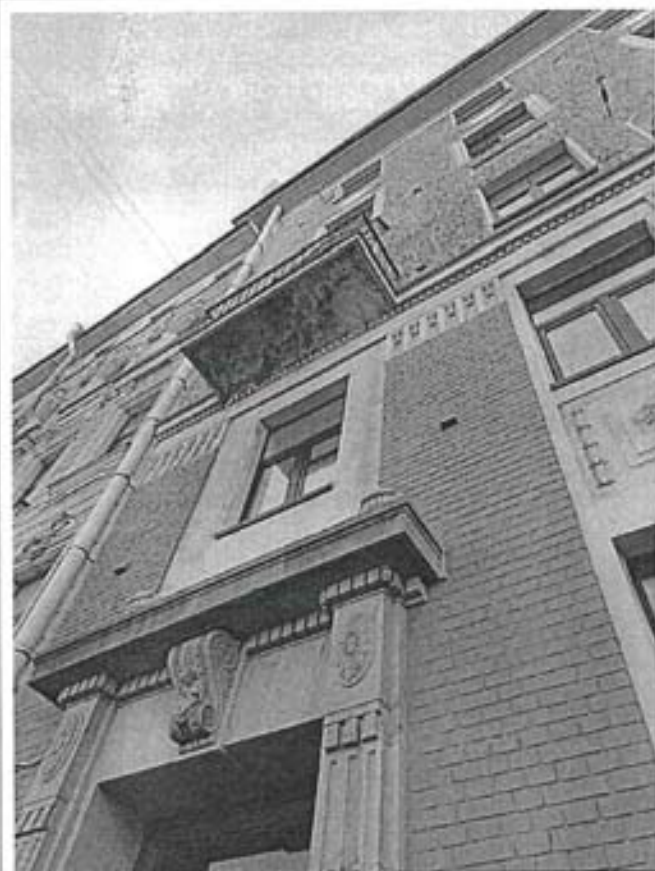
Фото 3. Фрагмент лицевого фасада по наб. реки Фонтанки. Под балконными плитами имеются следы увлажнения карниза и утраты на локальных участках зубчиков междуэтажного карниза.
