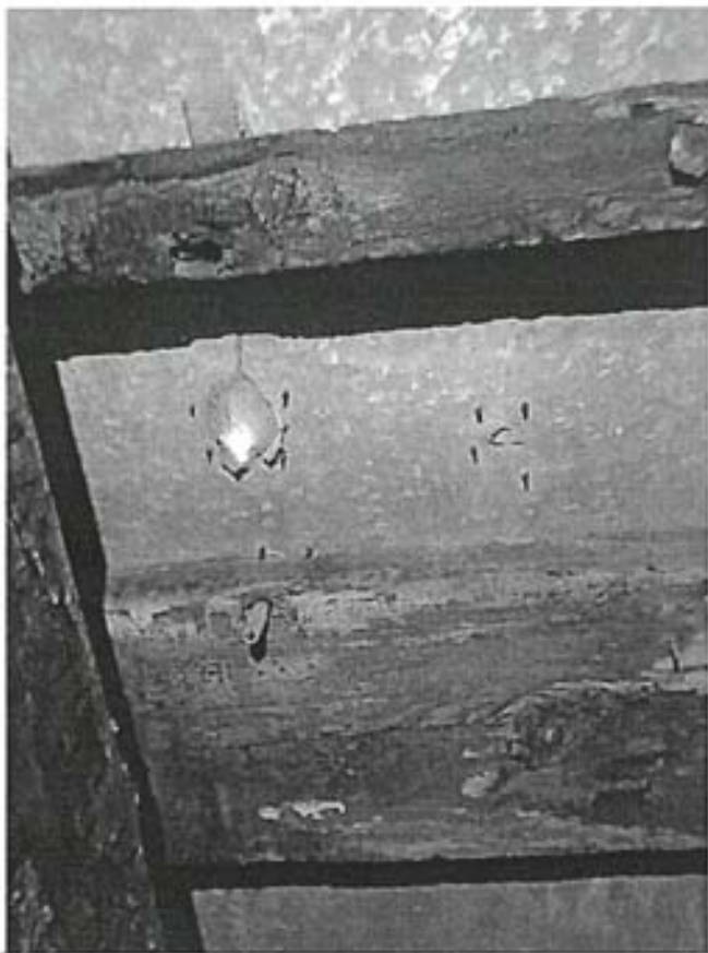
Фото 67. Фрагмент кровли, имеются сквозные отверстия, следы пожара.
