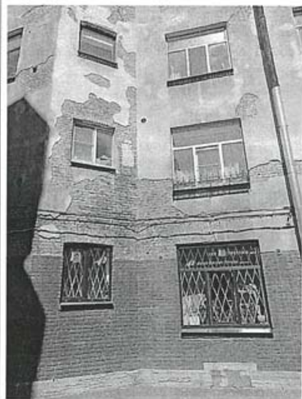
Фото 61. Фрагмент дворового фасада внешнего контура. Ненадлежащее состояние штукатурной отделки фасадов.
