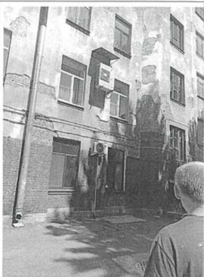
Фото 60. Фрагмент дворового фасада внешнего контура. Ненадлежащее состояние штукатурной отделки фасадов.
