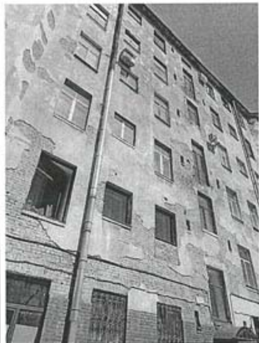
Фото 106. Фрагмент дворового фасада внешнего контура здания. В квартире № 255 выполнена закладка кирпичом нижней части оконного проема
