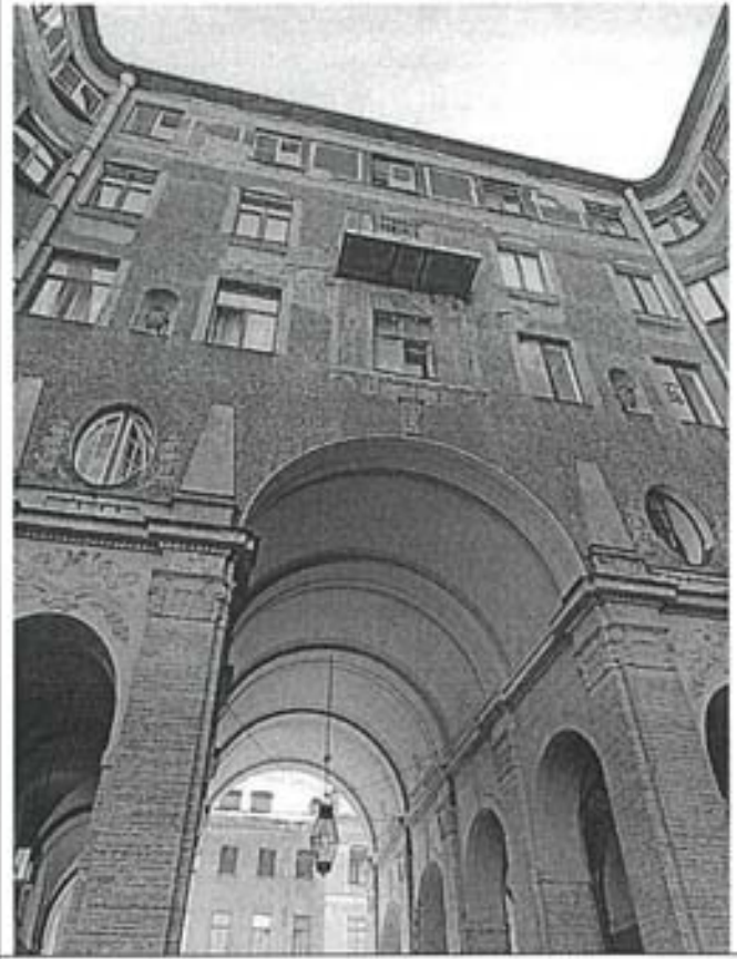
Фото 18. Дворовые фасады внутреннего двора. Ненадлежащее состояние штукатурной отделки фасадов.
