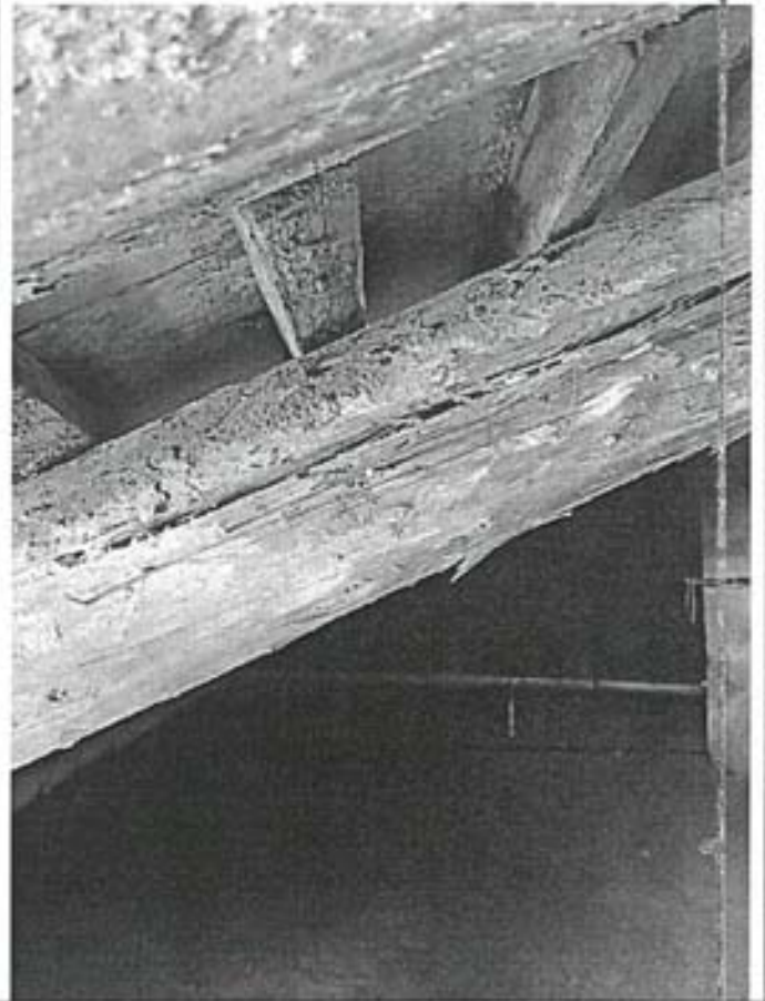
Фото 76. Фрагмент крыши. Наблюдаются трещины стропильных ног.
