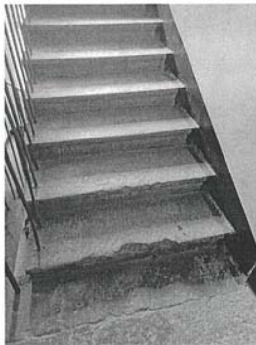
Фото 114. Помещение черной лестницы, на первом этаже которой расположены квартира № 120-128; сколы ступеней лестничного марша
