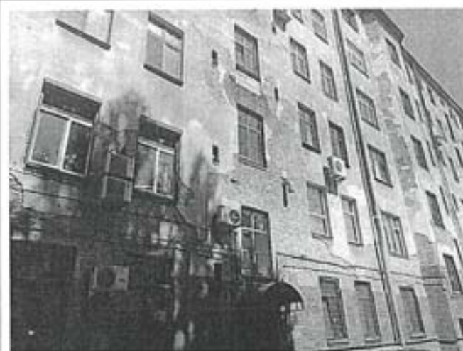
Фото 57. Фрагмент дворового фасада внешнего контура. Балконы в уровне 4 и 6 этажей черной лестничной клетки (где расположены квартиры № 156, 157) отсутствуют. Выполнена закладка нижней части указанных проемов блоками из газобетона. Взамен балконных дверей установлены окна
