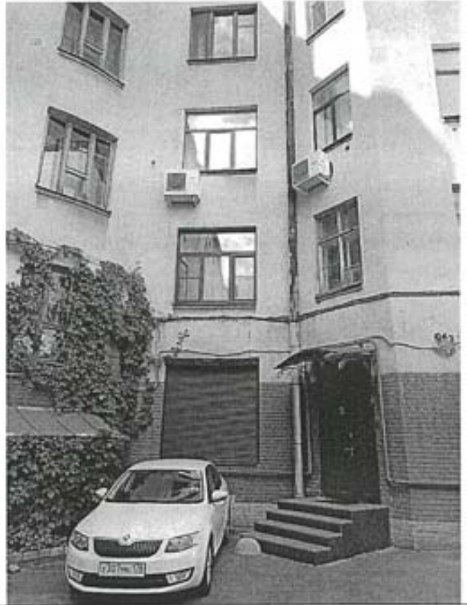
Фото 104. Фрагмент квартиры № 108 (1 этаж). Устройство входа на месте оконного проема и рольставней на окнах
