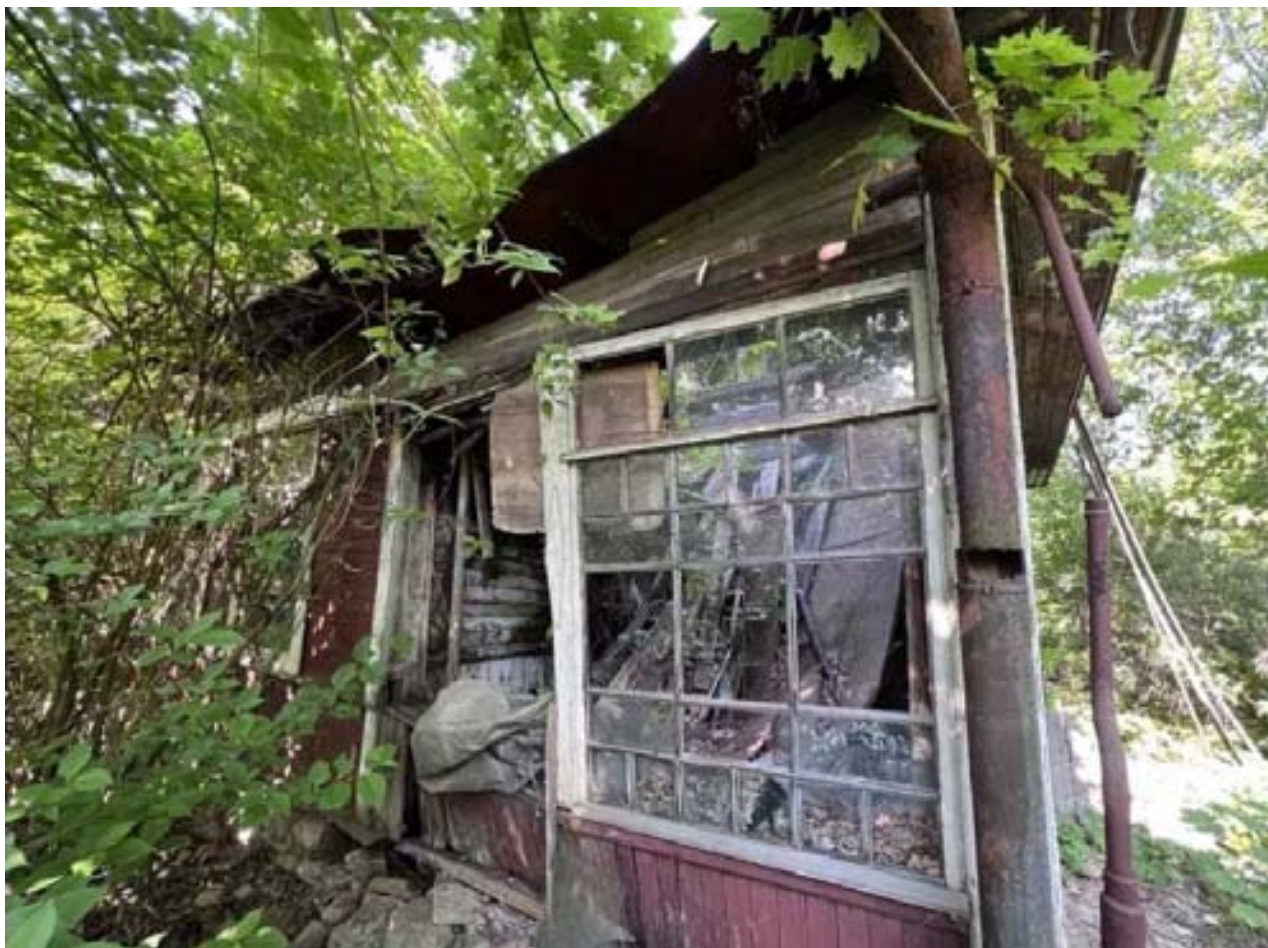
Илл. 20. Жилой дом по адресу: Пушкинская ул., 25 А. Вид остекленной веранды. Июнь 2023 г. Из материалов обследования технического состояния «Санкт-Петербургской научно-технической организации «Наука – Производству».
