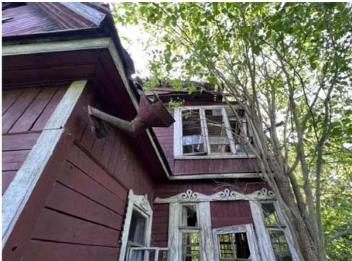
Илл. 19. Жилой дом по адресу: Пушкинская ул., 25 А. Вид остекленной веранды. Июнь 2023 г. Из материалов обследования технического состояния «Санкт-Петербургской научно-технической организации «Наука – Производству».
