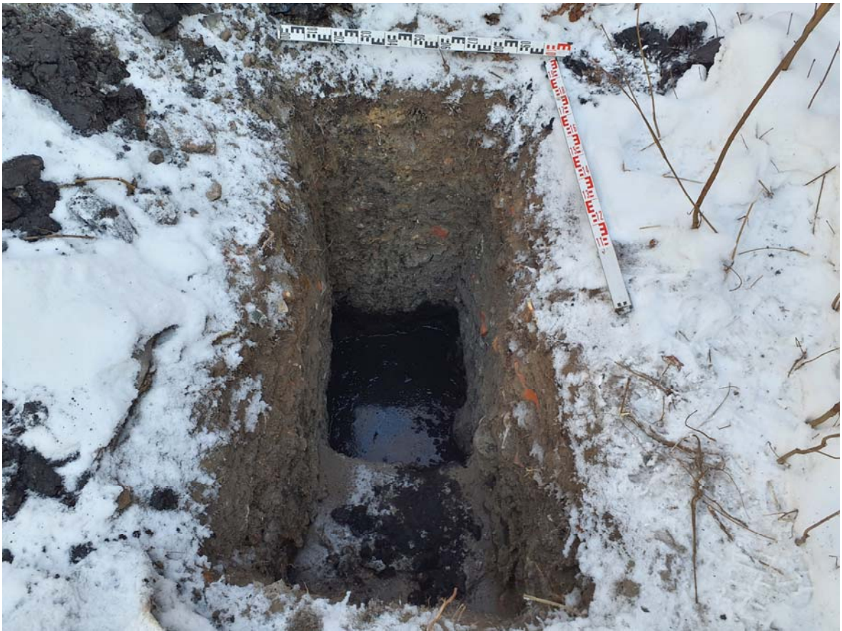
Рис. 37. Санкт-Петербург, ул. Матроса Железняка – 2026. Шурф 1. Выборка до уровня грунтовых вод. Вид с юга
