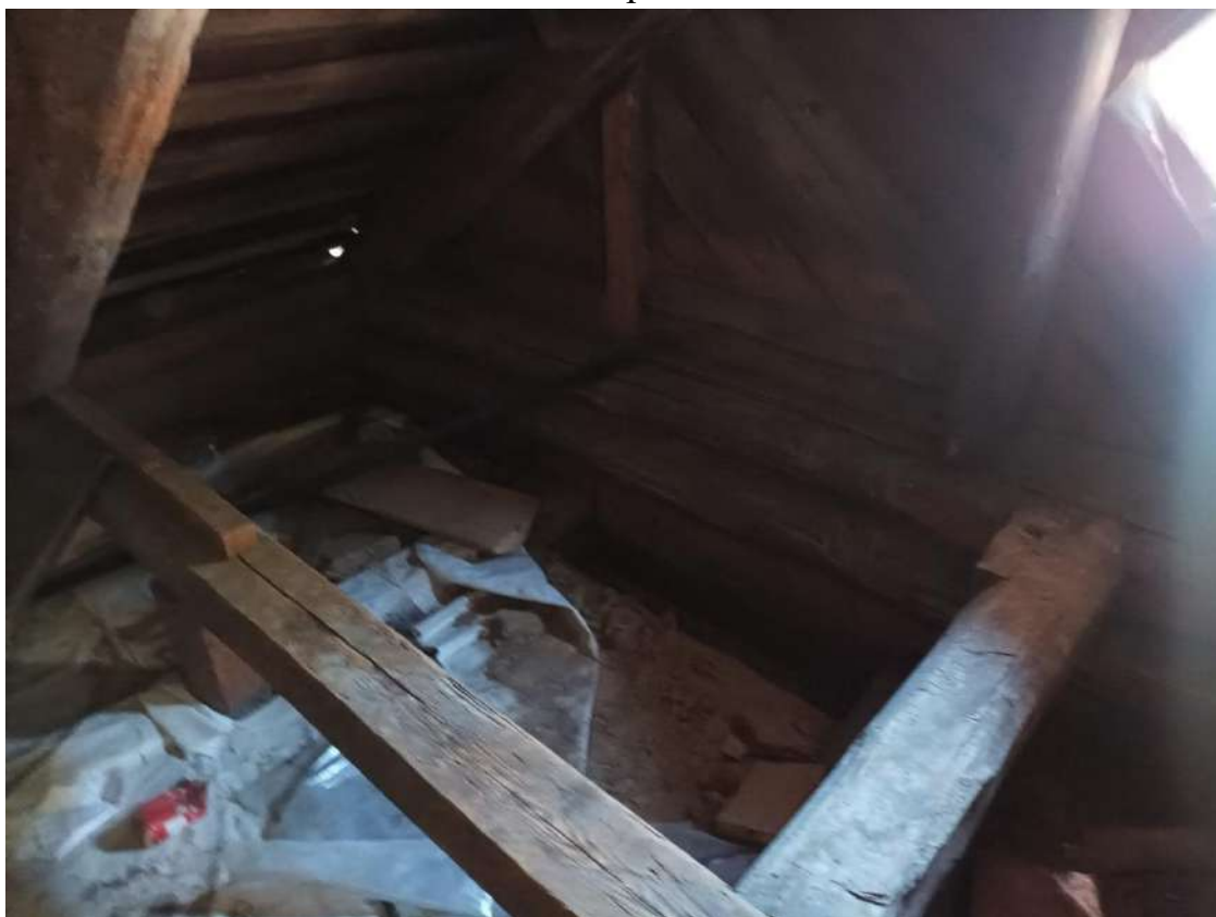
Фото 50. Объект культурного наследия регионального значения «Дача Е. Н. Макаровой (семьи академика А. Е. Фаворского)». Внутренние помещения мансарды.
