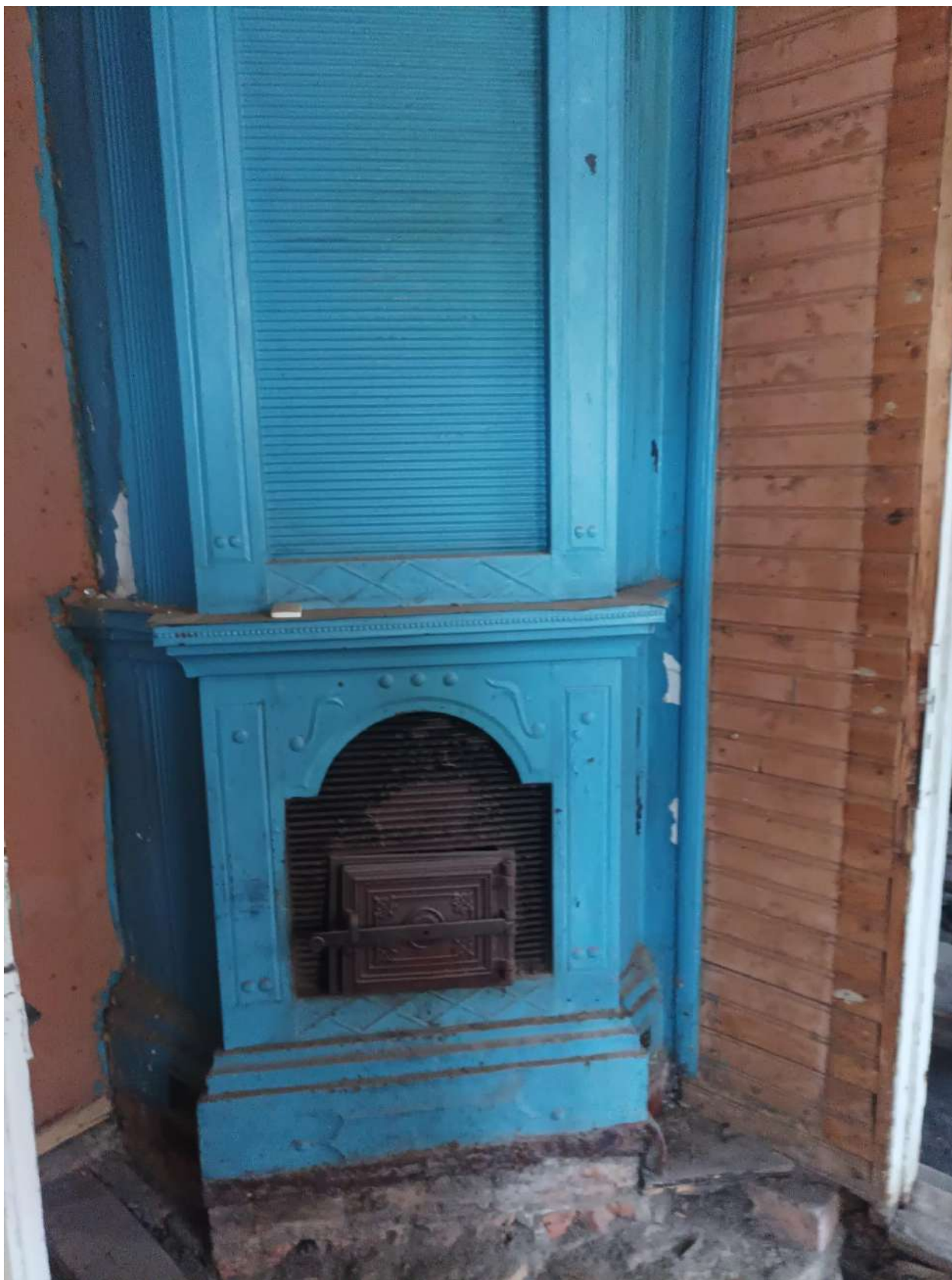
Фото 32. Объект культурного наследия регионального значения «Дача Е. Н. Макаровой (семьи академика А. Е. Фаворского)». Внутренние помещения 1-го этажа.
