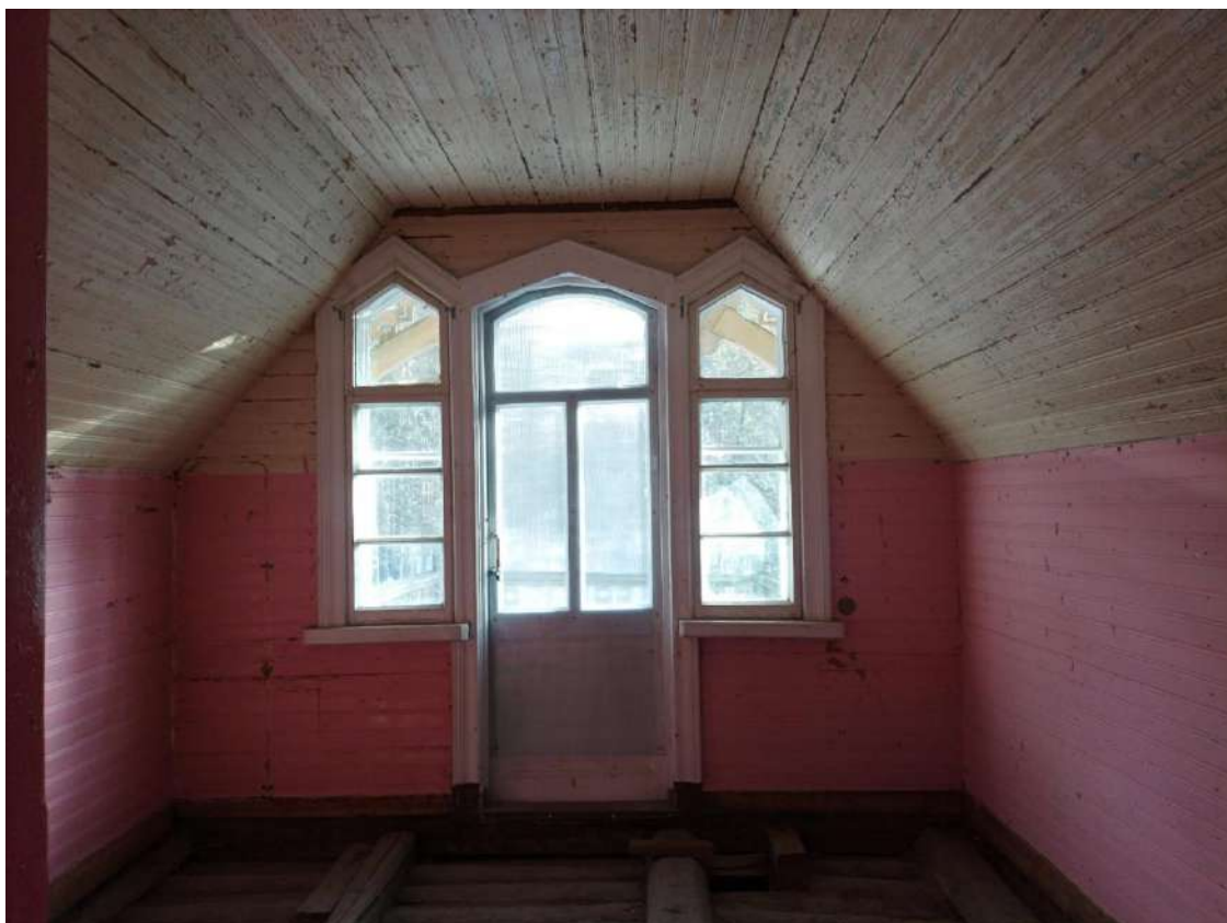
Фото 44. Объект культурного наследия регионального значения «Дача Е. Н. Макаровой (семьи академика А. Е. Фаворского)». Внутренние помещения мансарды.
