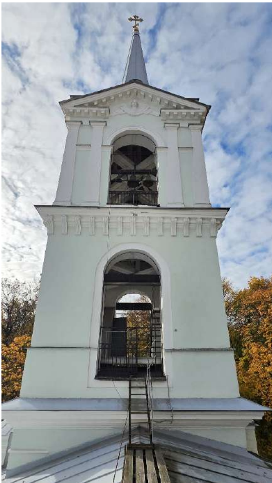
44. ОКНФЗ «Церковь Смоленская». Вид на колокольню с крыши церкви. Объемно-пространственное решение: двухъярусная колокольня с открытыми ярусами звона. Дата съемки 19.10.2025г.
