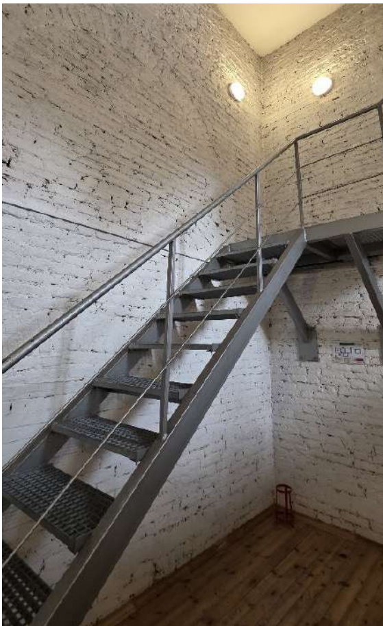
45. ОКНФЗ «Церковь Смоленская». Интерьер второго яруса колокольни: кирпичные внутренние капитальные стены. Дата съемки 19.10.2025г.
