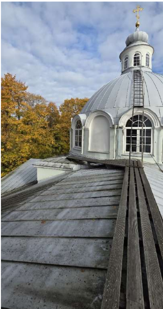
42. ОКНФЗ «Церковь Смоленская». Фрагмент крыши церкви: материал покрытия – листовый металл. Дата съемки 19.10.2025г.
