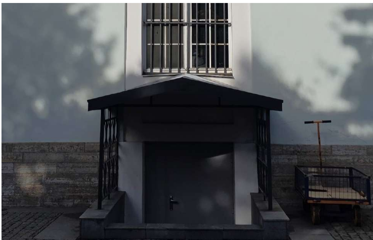
12. ОКНФЗ «Церковь Смоленская». Вход в подвал со стороны южного фасада церкви. Дата съемки 19.10.2025г.
