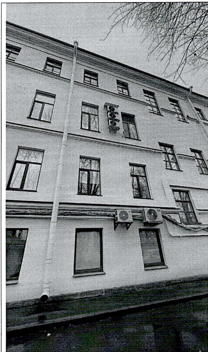
7. Фрагмент дворового фасада. Наружные блоки системы кондиционирования - 1 этаж помещение 21-Н в количестве 2 штук, 3 этаж помещение 52-Н в количестве 3 штук
