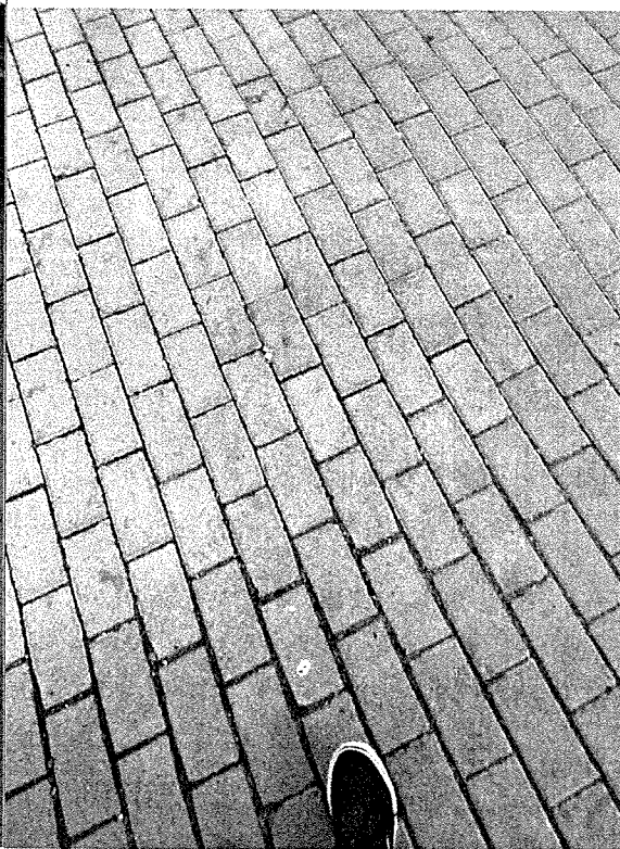
Фрагмент тротуарной плитки на территории объекта
