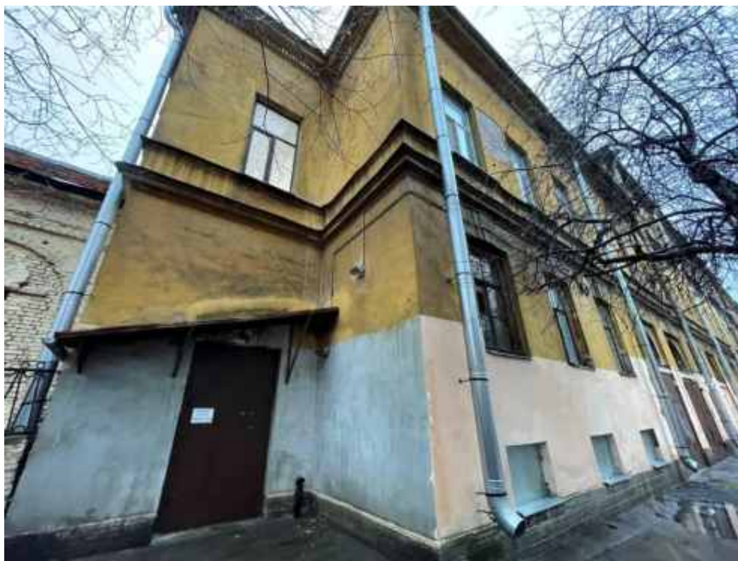
Фото 2. Фрагмент дворового фасада объекта культурного наследия федерального значения «Академия», входящего в состав объекта культурного наследия федерального значения «Российская Академия»
