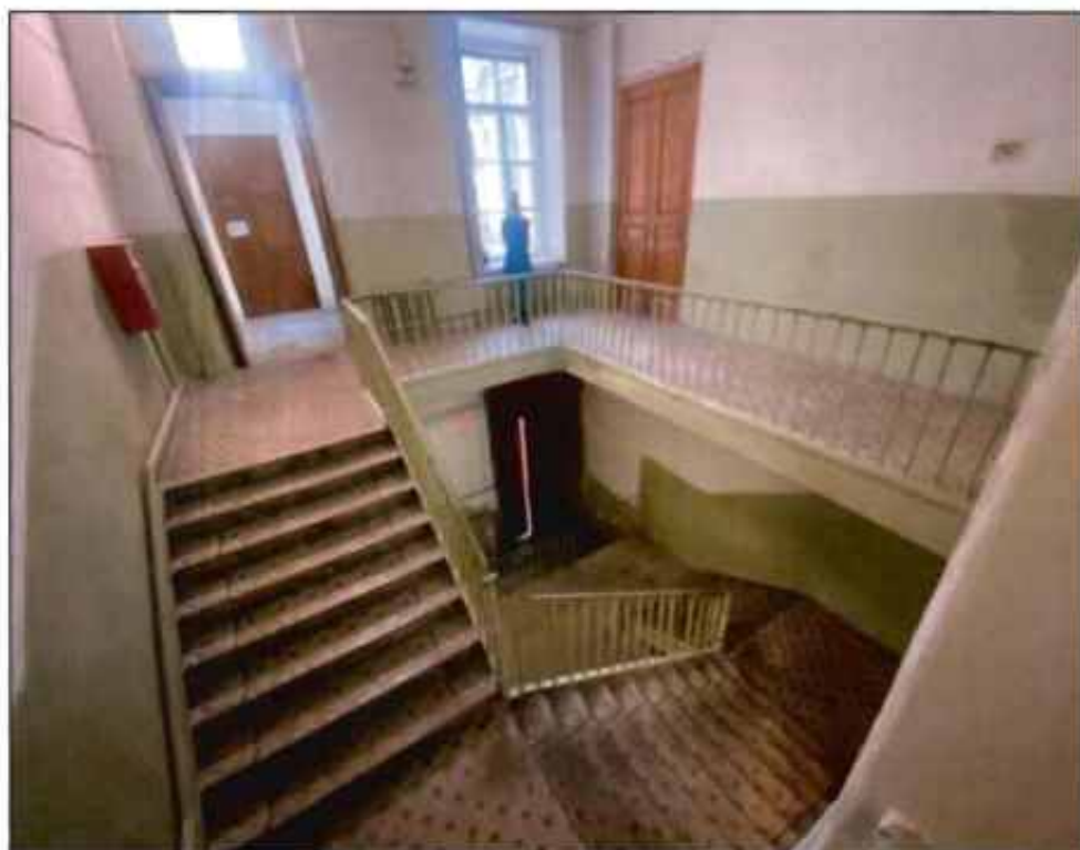
12. Металлическая трехмаршевая лестница по косоурам южного флигеля (пом. 25-Н (107)) Фото от 16.05.2022 г.
