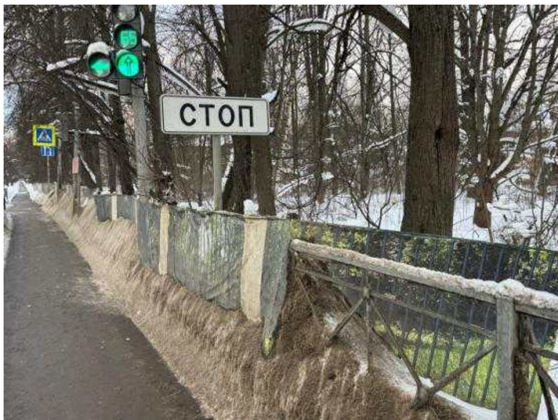
49. Ограда с западной стороны выявленного объекта культурного наследия «Офицерское собрание лейб-гвардии 1-го Стрелкового полка (с садом)». Вид с юга от ручья. 29.01.2026 г.
