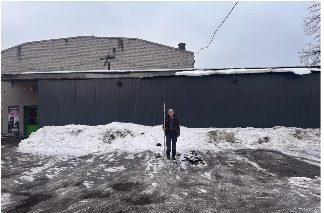
Рис. 30. СПб-2026. Выборгский район. Шурф №2. Общий вид до начала работ. Вид с севера.
