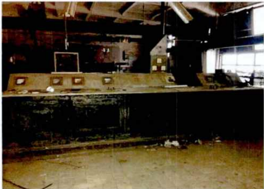
Фото 12. Пульт управления в бывш. турбинном зале.
