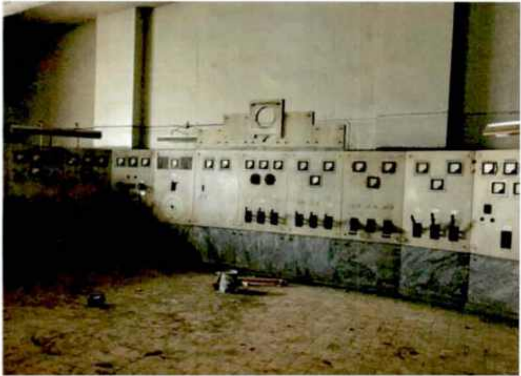
Фото 13. Шкафу с приборами в бывш. турбинном зале.
