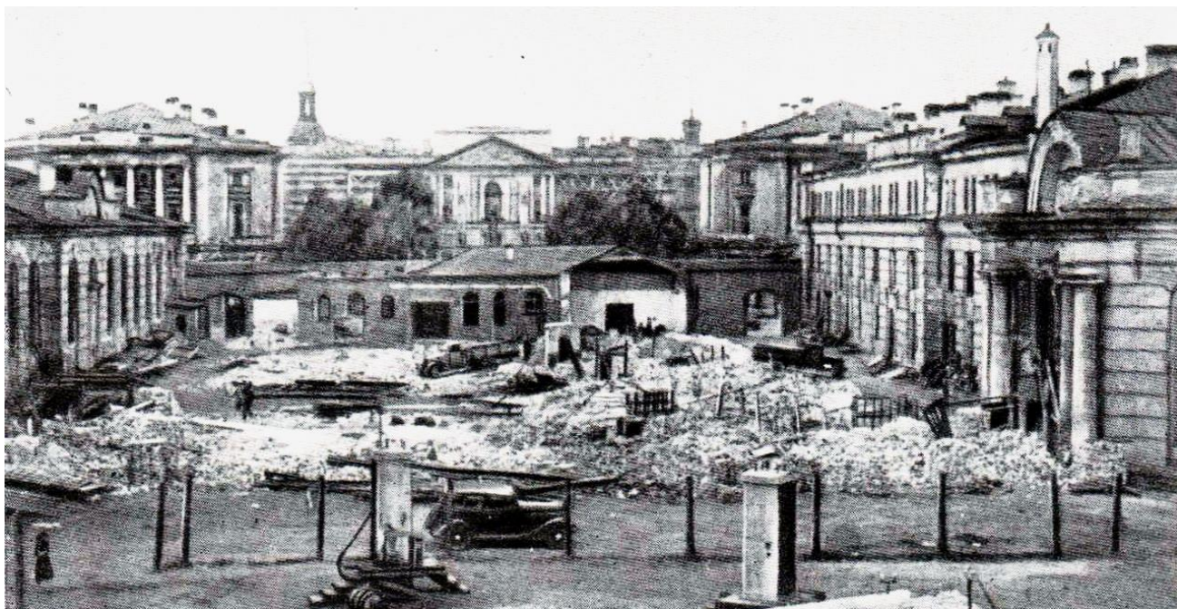
Илл. 10. СПб, Михайловский (Инженерный) замок в центре и Манеж (слева), Конюшни (справа) в процессе слома на кирпич связующий «коридорный» корпус между Манежем и Конюшнями. Виден (еще почти цел) такой же корпус по Инженерной ул. Вид с юга, фото 1948-49.
