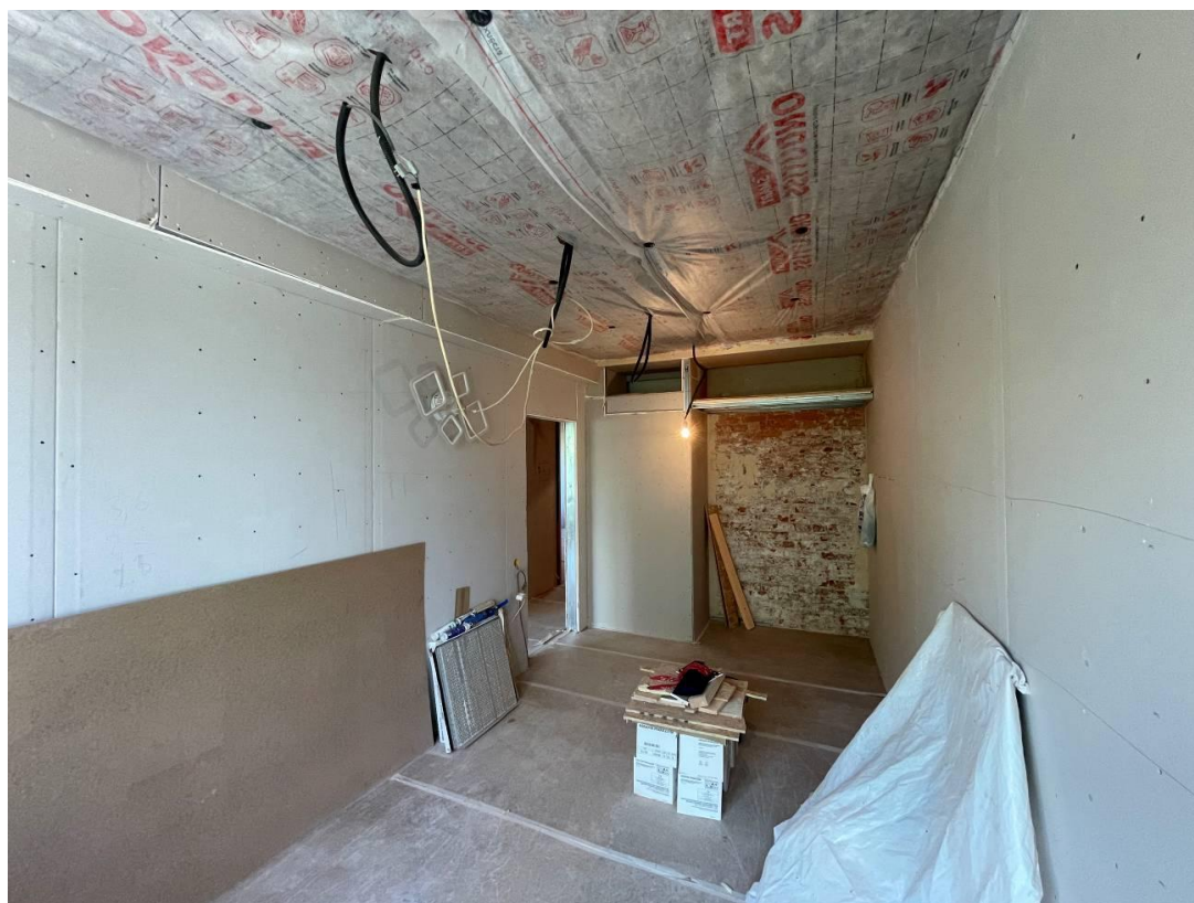
Фото 8. Интерьер квартиры № 335 объекта культурного наследия регионального значения «Жилой корпус», входящего в состав объекта культурного наследия регионального значения «Городок текстильщиков (жилой комплекс)»
