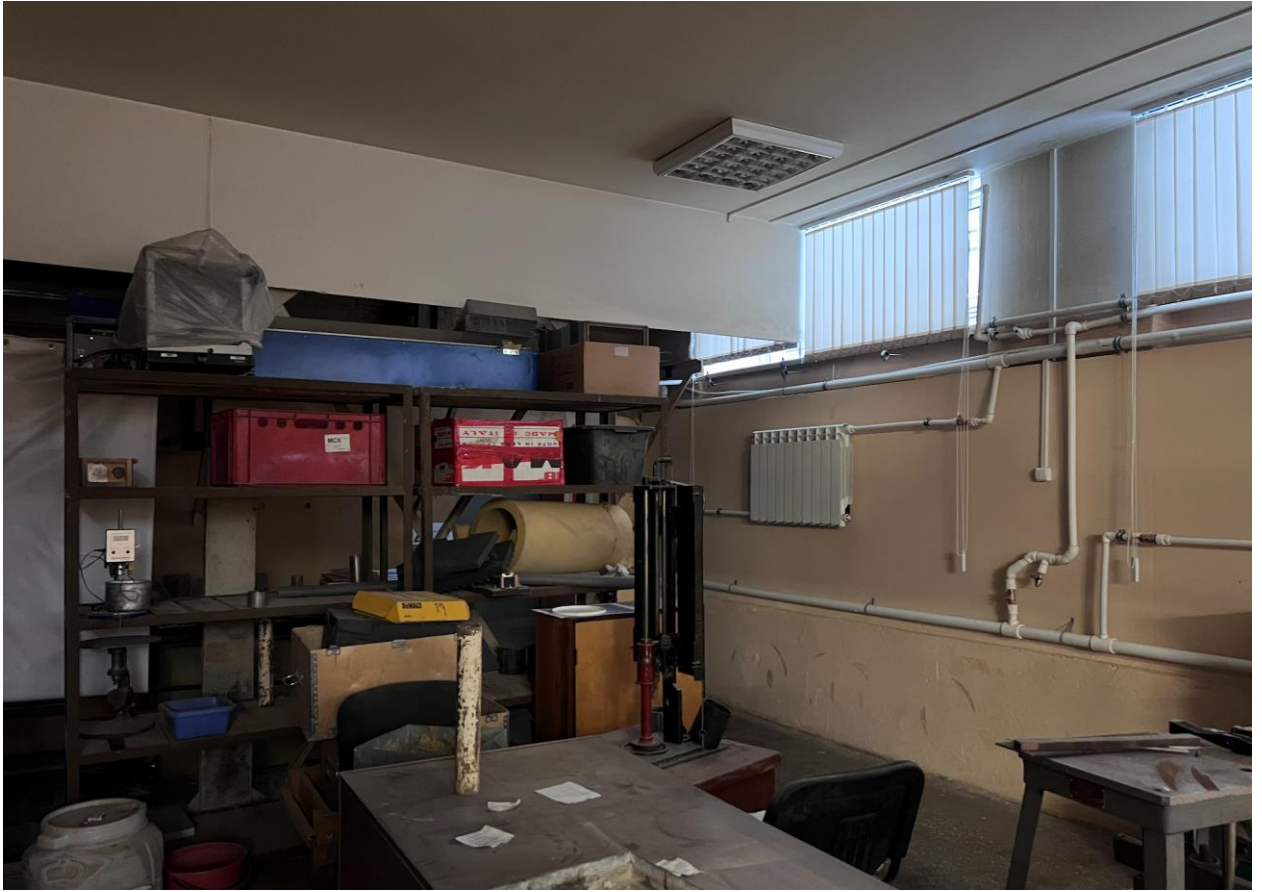
Фото 11. Объект культурного наследия регионального значения «Гидротехнический институт им. Б.Е. Веденеева (лицевой корпус с примыкающими дворовыми флигелями)», расположенный по адресу: Санкт-Петербург, Гжатская д. 21, лит. А. Помещение 143. Съёмка 01.04.2026 г.
