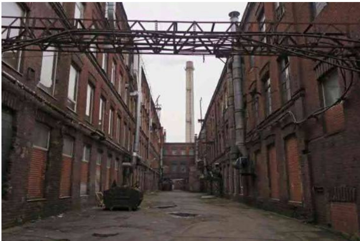
Илл. 54. Разрушенное состояние корпусов в 2020-е годы. Переход-галерея корпуса 5. https://fishki.net/4453304-что-случилось-с-legendarnym-krasnym-treugolnikom-i-pochem.html
