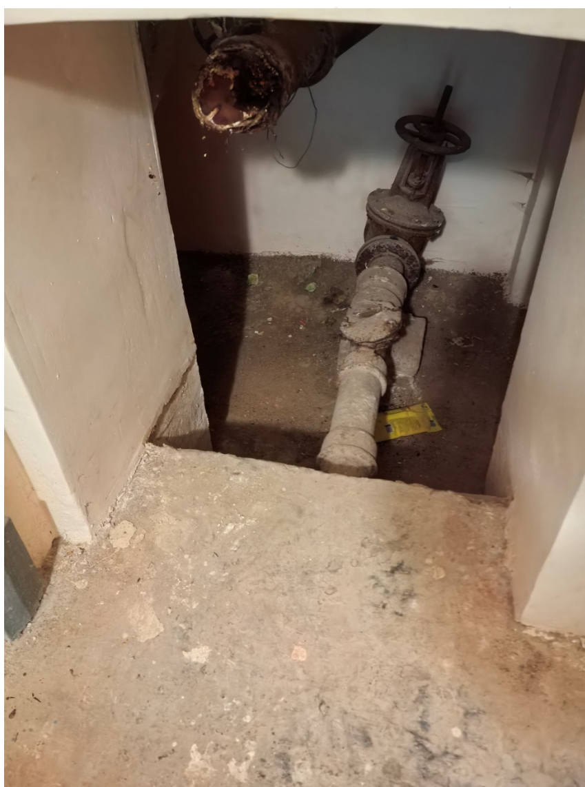
9. Объект культурного наследия федерального значения «Общество кредитное городское Санкт-Петербургское с дворовым флигелем», по адресу: Санкт-Петербург, пл. Островского, д. 7, лит. А (Островского пл., 7). Помещение санузла. Дата съемки: 20.03.2026г.
