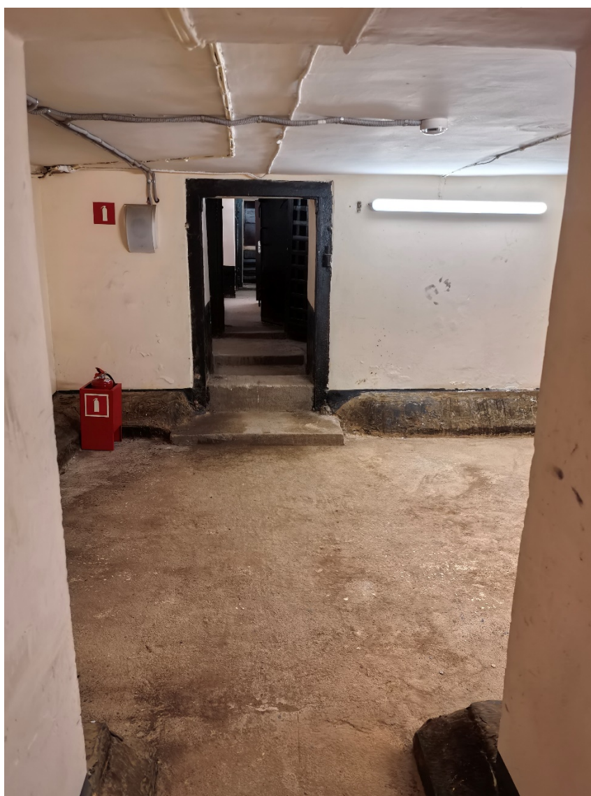
12. Объект культурного наследия федерального значения «Общество кредитное городское Санкт-Петербургское с дворовым флигелем», по адресу: Санкт-Петербург, пл. Островского, д. 7, лит. А (Островского пл., 7). Помещение подвала. Дата съемки: 20.03.2026г.
