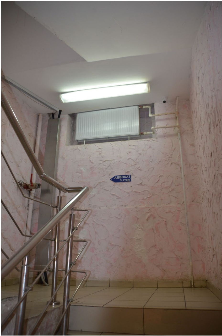
14. Выявленный объект культурного наследия «Жилой дом», расположенный по адресу: Санкт-Петербург, г. Ломоносов, Кронштадтская ул., 1, литера А. Лестничная площадка между 1-м и 2-м этажами.
