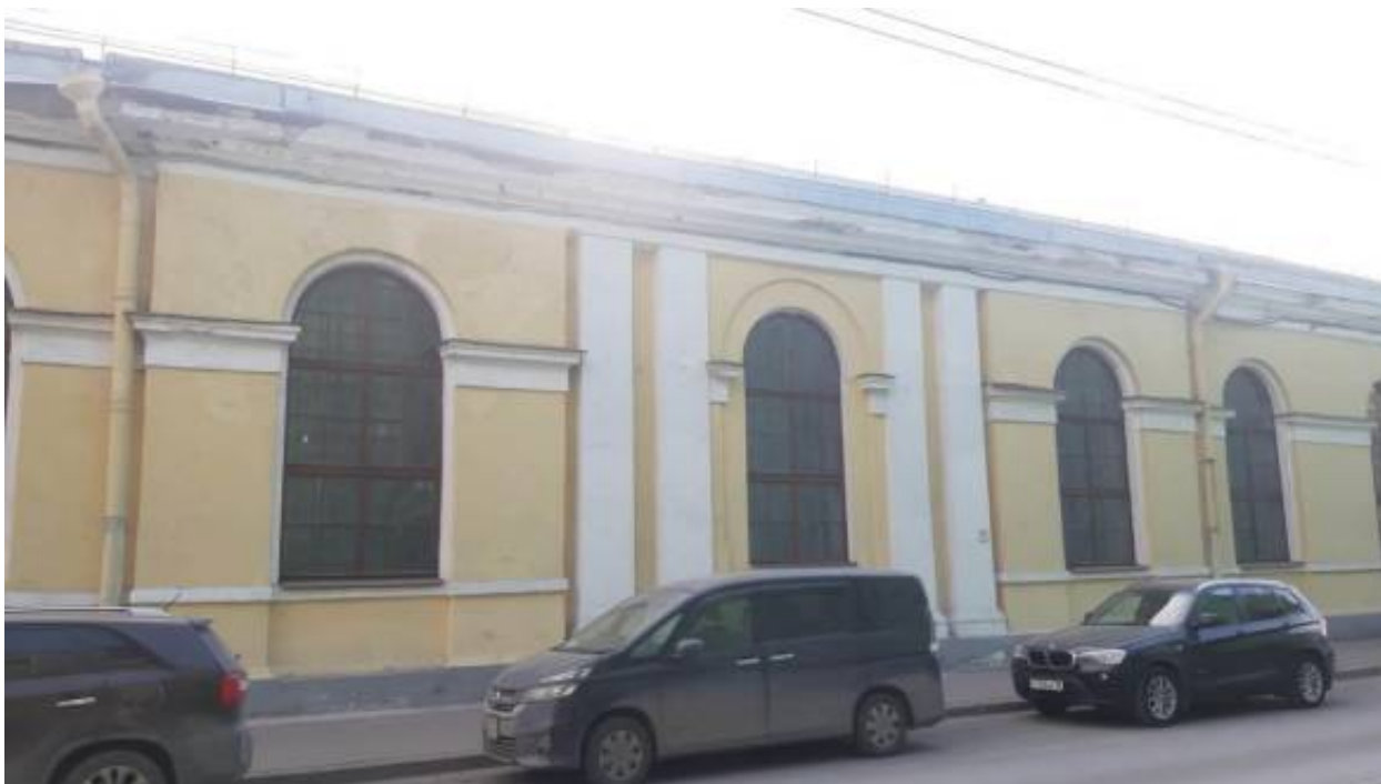
17. «Манеж» (в составе «Корпус Кадетский Второй») (Ждановская ул., д. 13, лит. А). Лицевой фасад по Красного Курсанта ул. (фрагмент). Фото мест установки оборудования и прокладки кабельных трасс. Штиглиц М.С. 02.04.2026 г.
