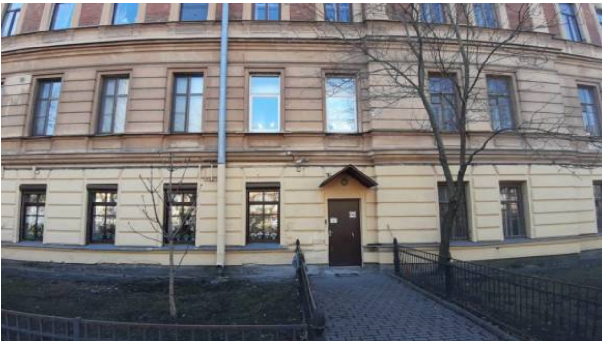
7. «Дом дешевых квартир Императорского человеколюбивого общества» (Большая Зеленина ул., д. 13, лит. А). Лицевой фасад из Ораниенбаумского сада (фрагмент). Фото мест установки оборудования и прокладки кабельных трасс. Штиглиц М.С. 02.04.2026 г.
