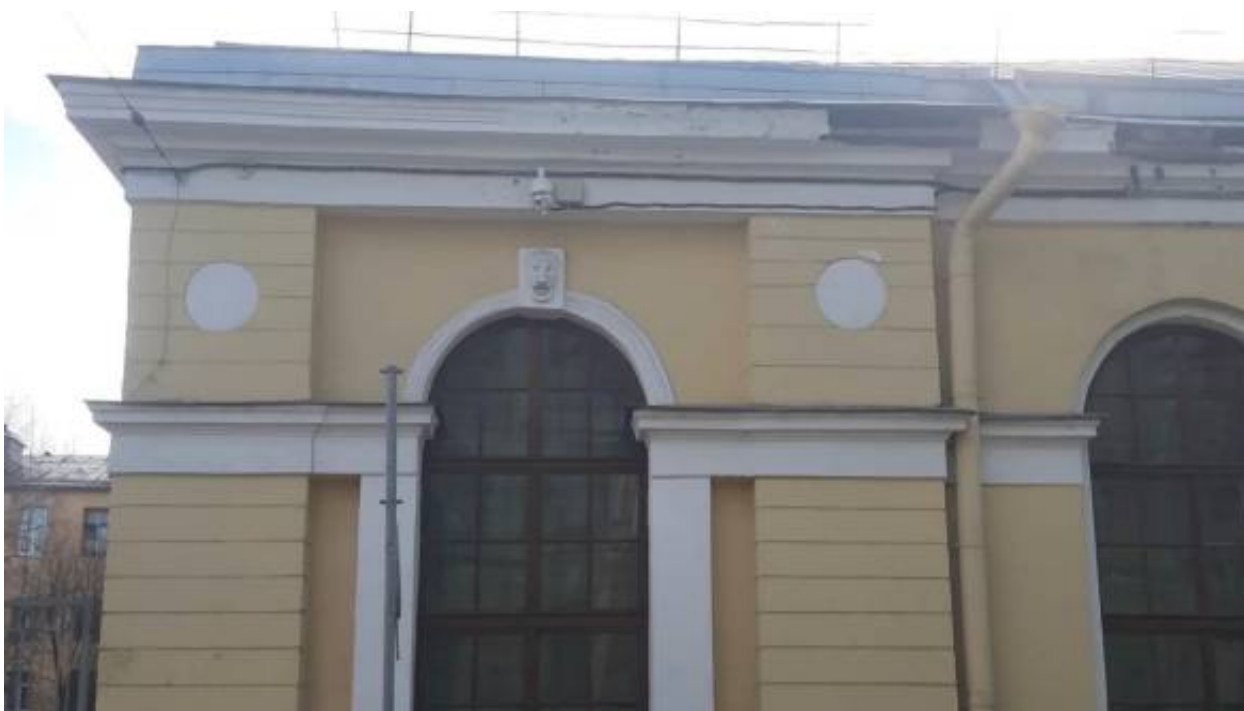
16. «Манеж» (в составе «Корпус Кадетский Второй») (Ждановская ул., д. 13, лит. А). Лицевой фасад по Красного Курсанта ул. (фрагмент). Фото мест установки оборудования и прокладки кабельных трасс. Штиглиц М.С. 02.04.2026 г.
