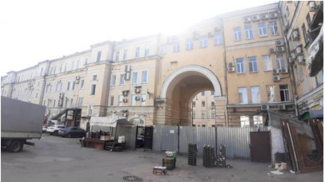
9. «Здания Общества торговцев рыбного рынка» (Московский пр., д. 10-12, лит. А). Дворовый фасад. Фото мест установки оборудования и прокладки кабельных трасс. Штиглиц М.С. 06.05.2026 г.
