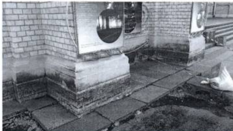
Фото 4. Состояние цоколя северного фасада объект культурного наследия
