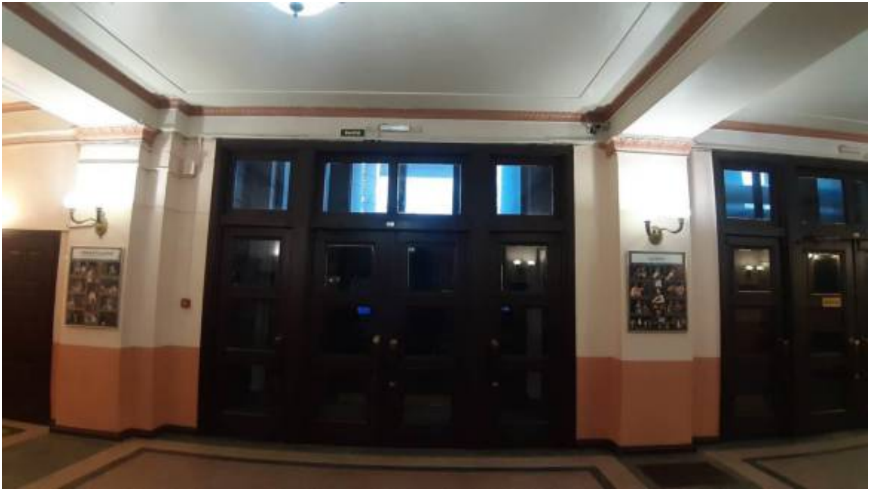
17. «Здание Театра им. Ленинского комсомола» (Александровский парк, д. 4, лит. Т). Интерьер. 1-й этаж. Фото мест установки оборудования и прокладки кабельных трасс. Штиглиц М.С. 17.12.2025.
