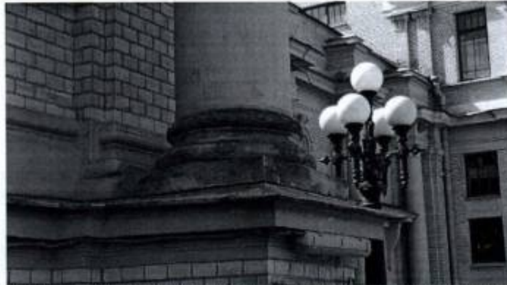
Фото 5. Состояние базы колонны со стороны ризалита северного фасада объекта культурного наследия
