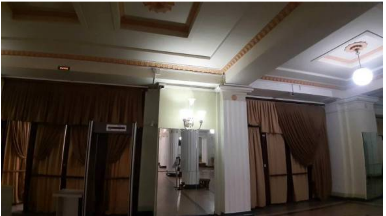
16. «Здание Театра им. Ленинского комсомола» (Александровский парк, д. 4, лит. Т). Интерьер. 1-й этаж. Фото мест установки оборудования и прокладки кабельных трасс. Штиглиц М.С. 17.12.2025.
