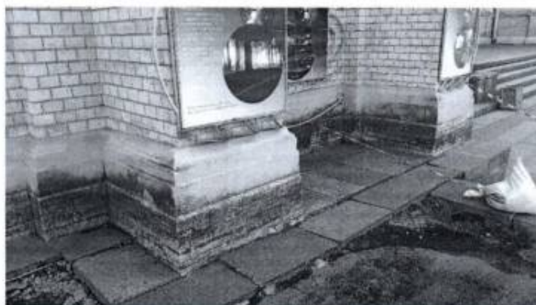
Фото 4. Состояние цоколя северного фасада объект культурного наследия
