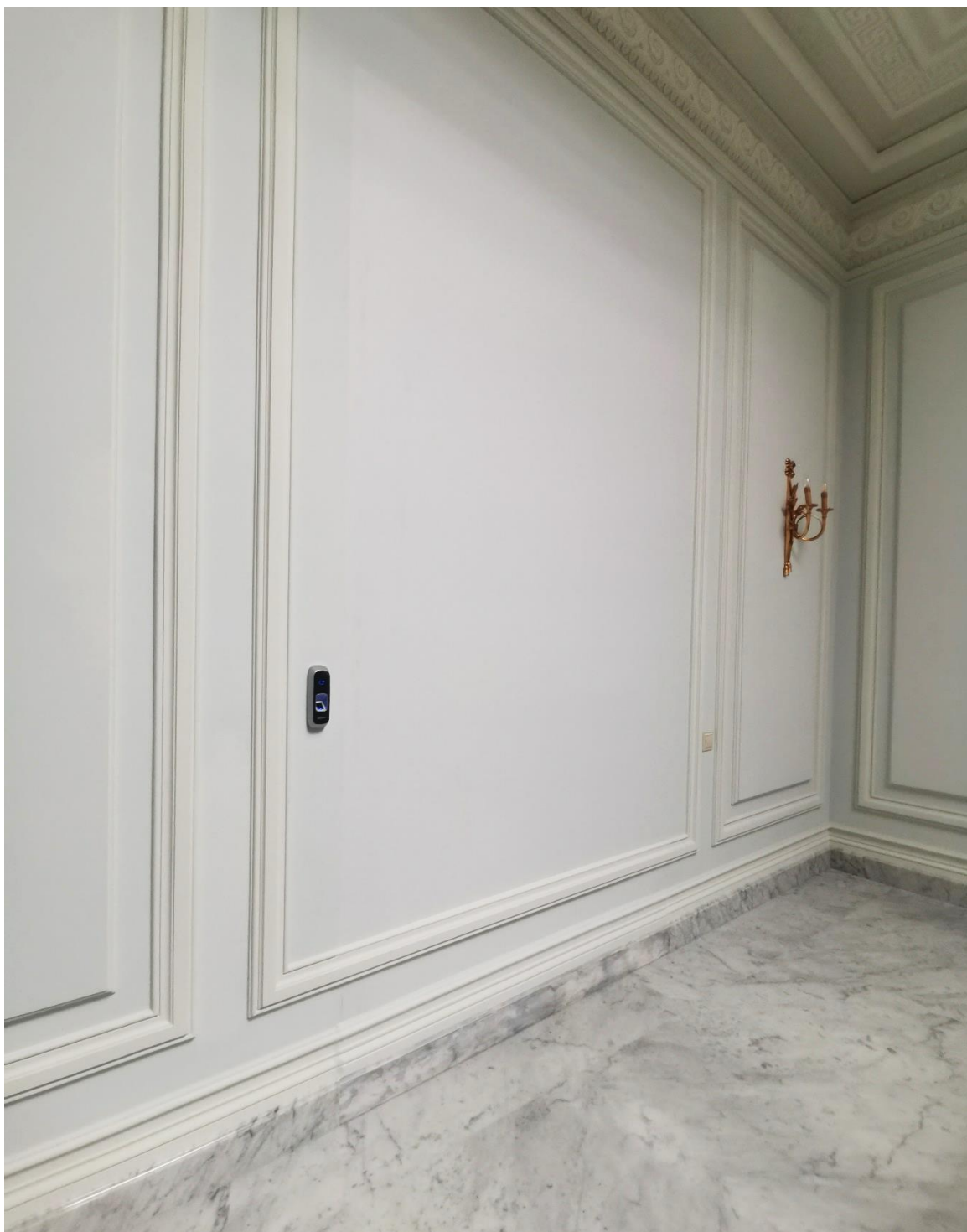
Фото 5. Вид стену по оси По оси 2-1/В лестничной площадки 2-го этажа парадной лестницы Л-6 объекта культурного наследия регионального значения «Дома кн. Л.Д. Вяземского». 08.09.2025г. Е.В. Каткова.
