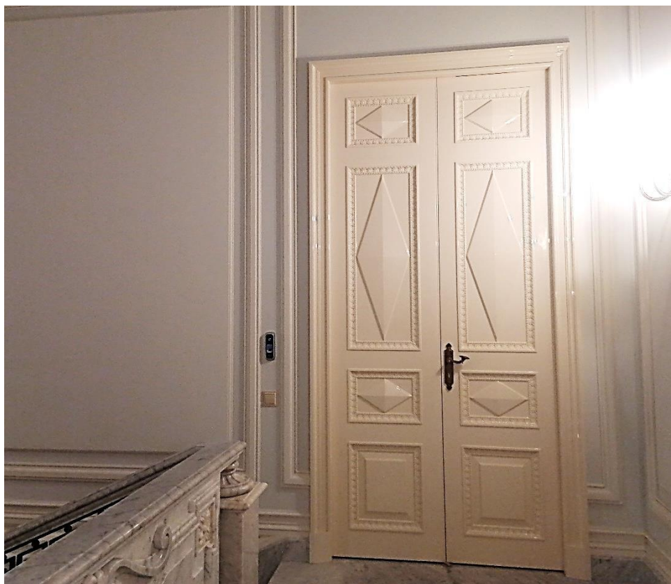
Фото 7. Фрагмент стены по оси 2/В-В* лестничной площадки 2-го этажа парадной лестницы Л-6 объекта культурного наследия регионального значения по оси «Дома кн. Л.Д. Вяземского» (аналог). 08.09.2025г. Е.В. Каткова.
