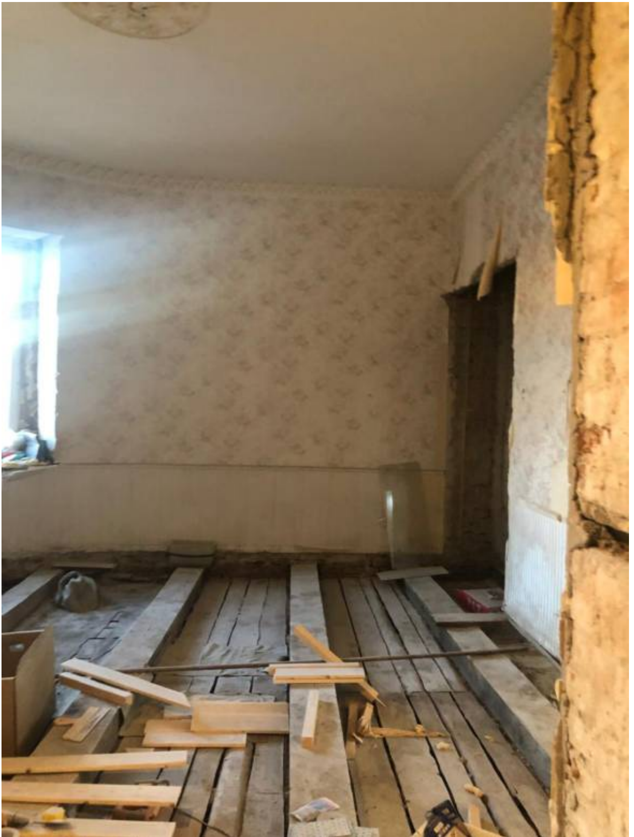
9. Помещение 4 (согласно техническому паспорту).
