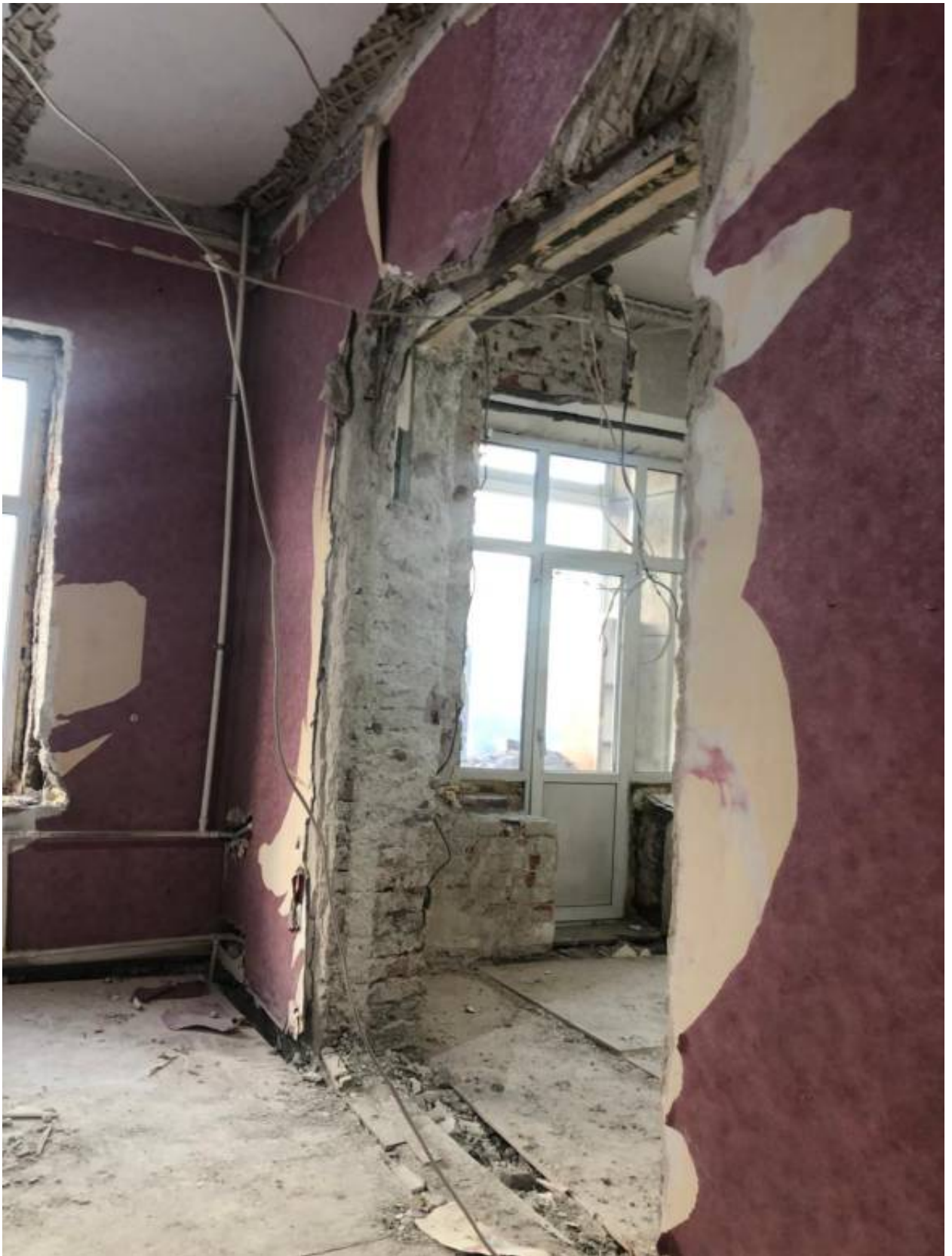
13. Помещение 3 (согласно техническому паспорту).
