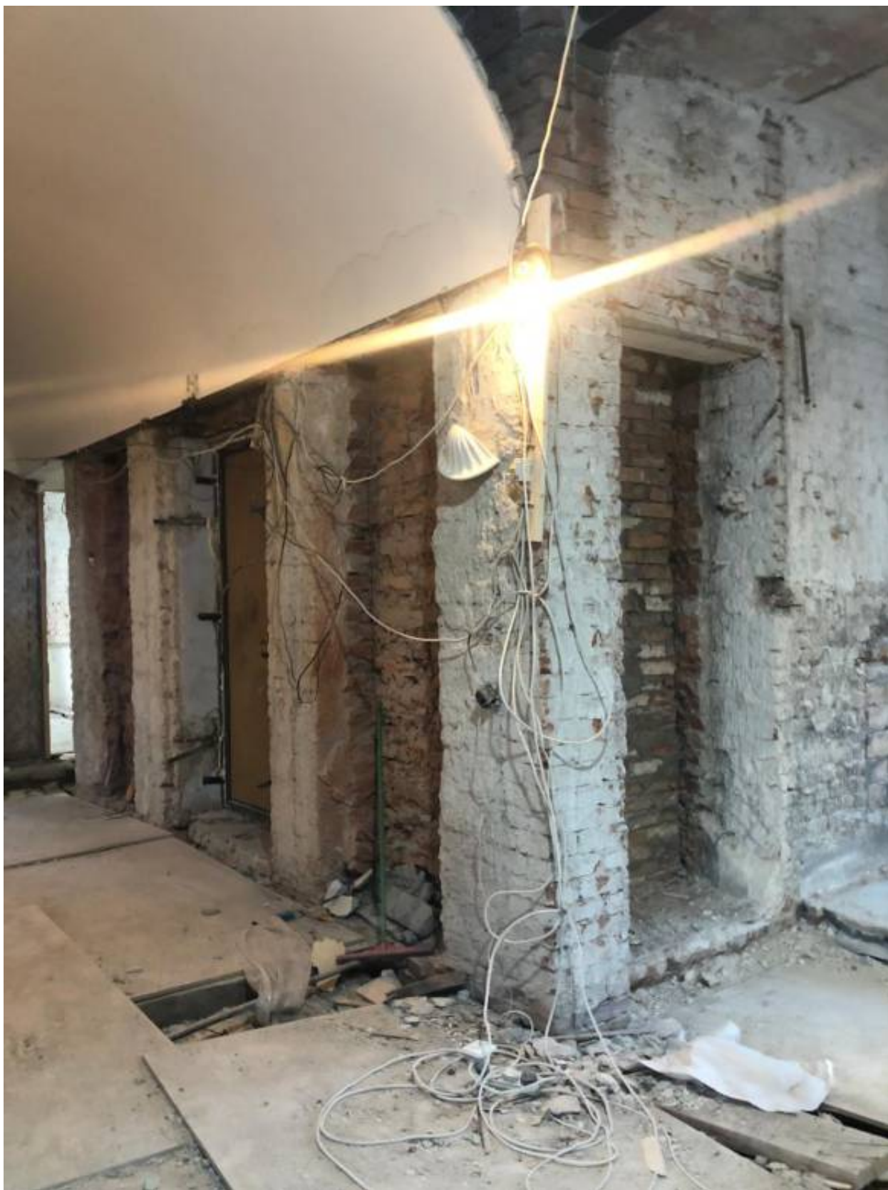
21. Помещение 7 (согласно техническому паспорту).
