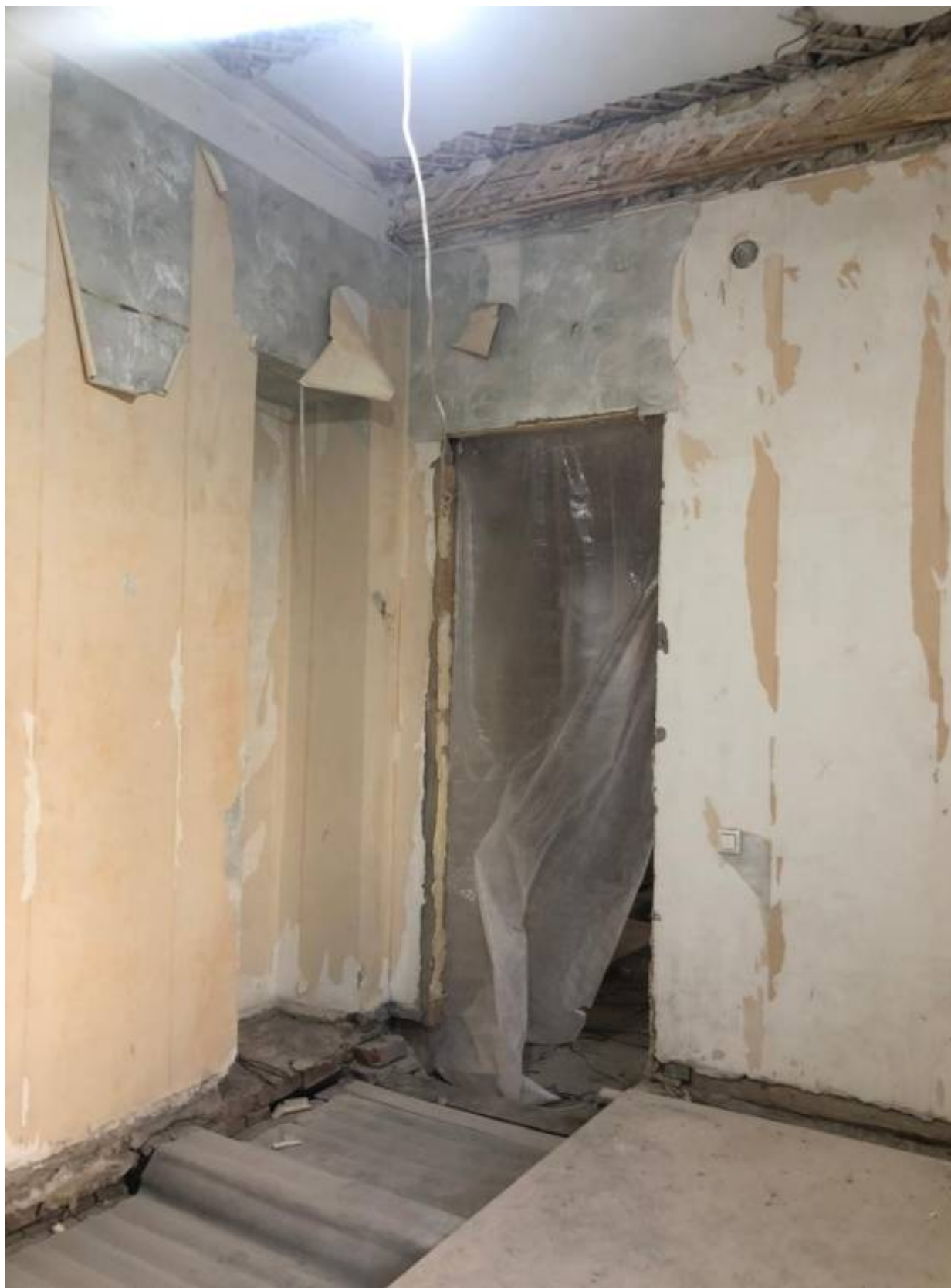
7. Помещение 1 (согласно техническому паспорту).
