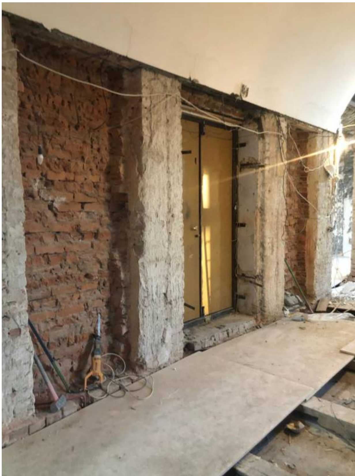
5. Помещение 7 (согласно техническому паспорту).
