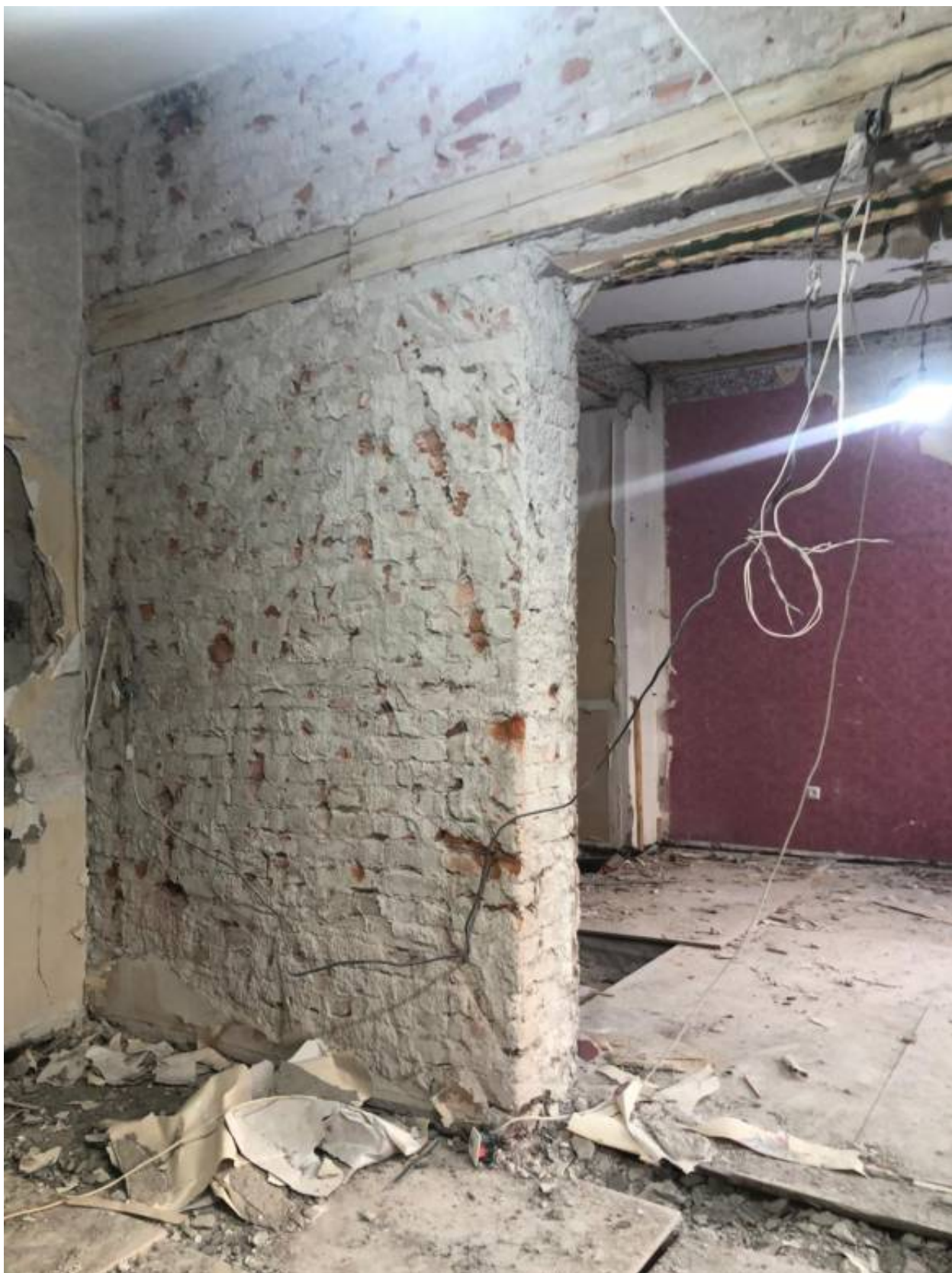
15. Помещение 2 (согласно техническому паспорту).
