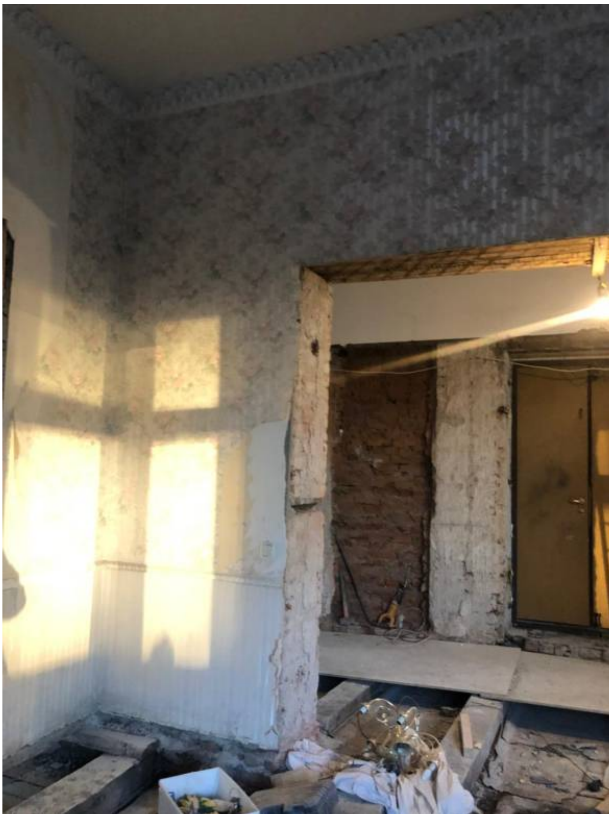
10. Помещение 4 (согласно техническому паспорту).
