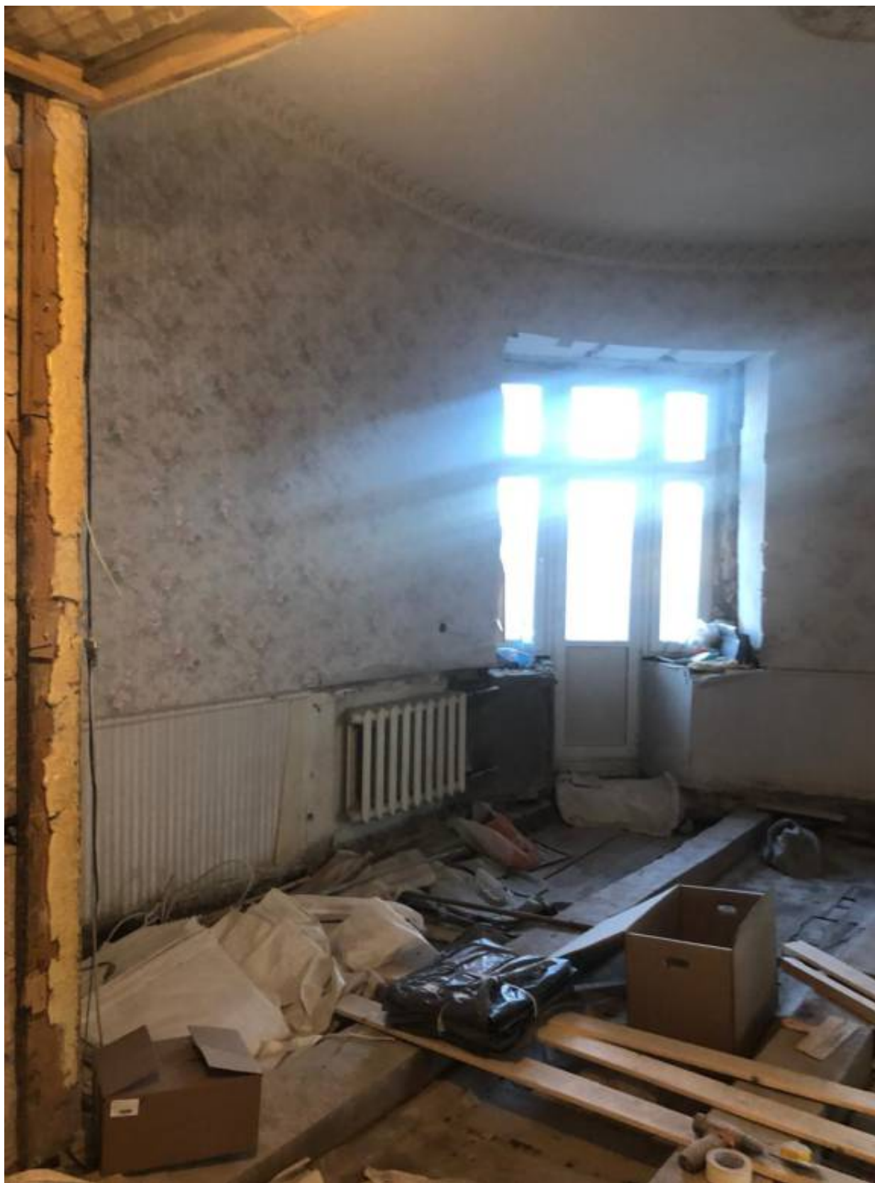
8. Помещение 4 (согласно техническому паспорту).
