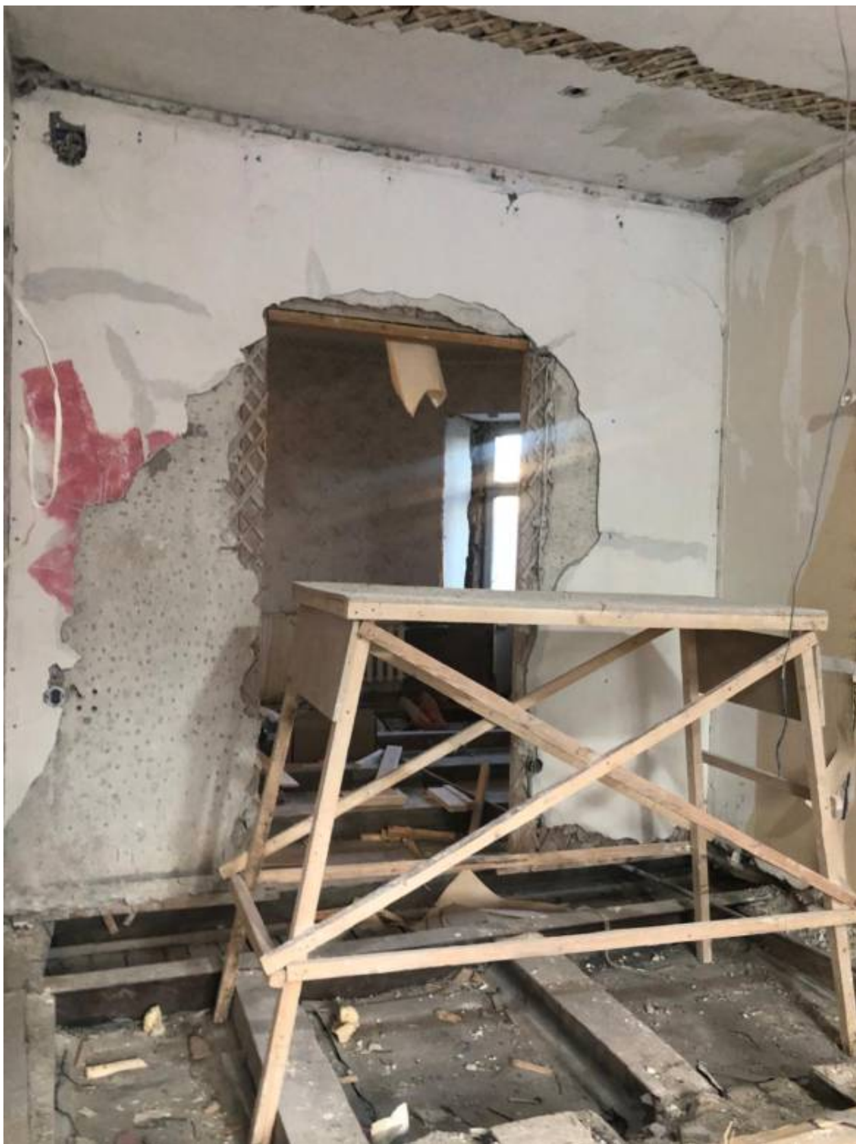
17. Помещение 3 (согласно техническому паспорту).
