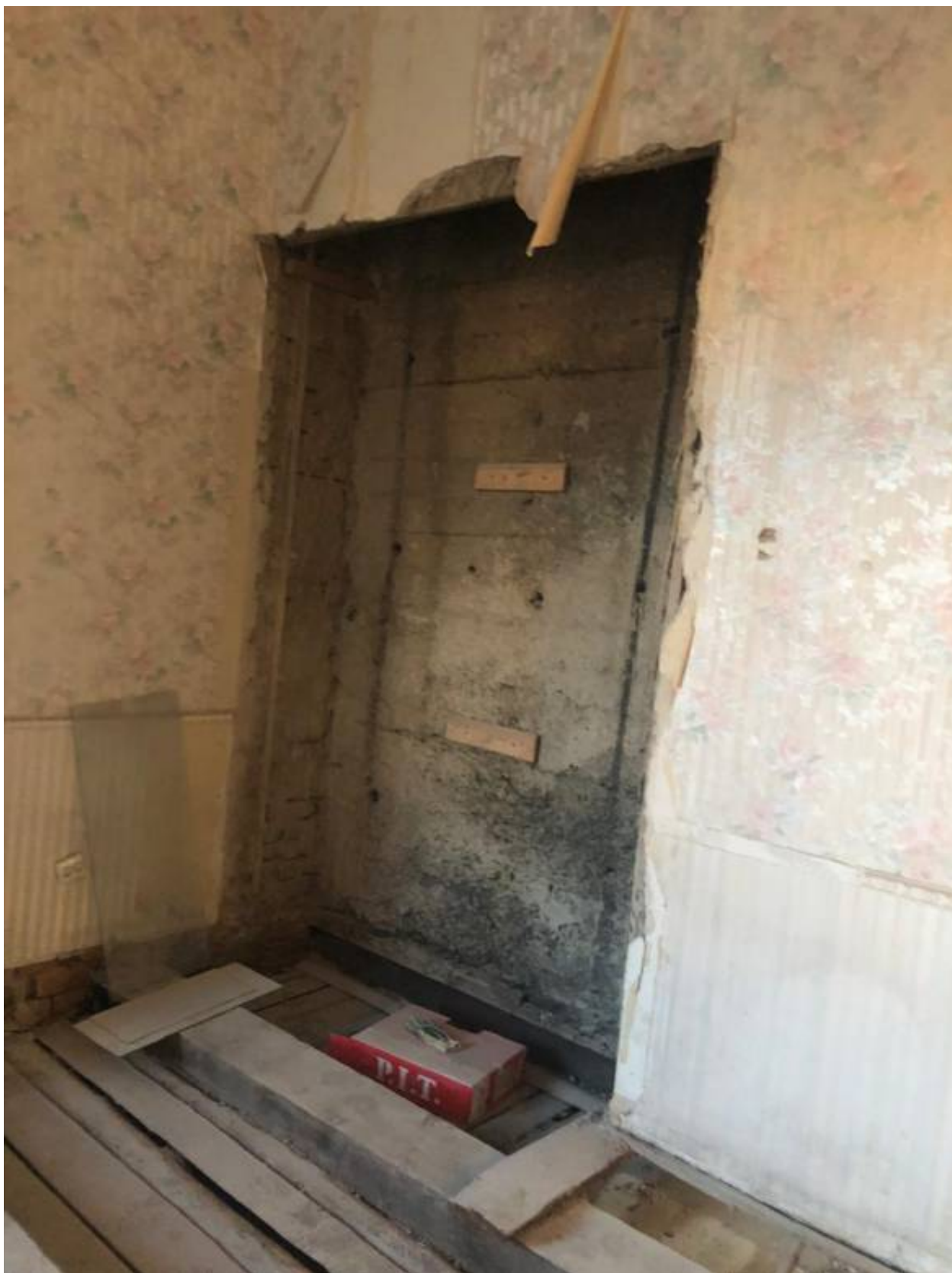
12. Помещение 4 (согласно техническому паспорту).
