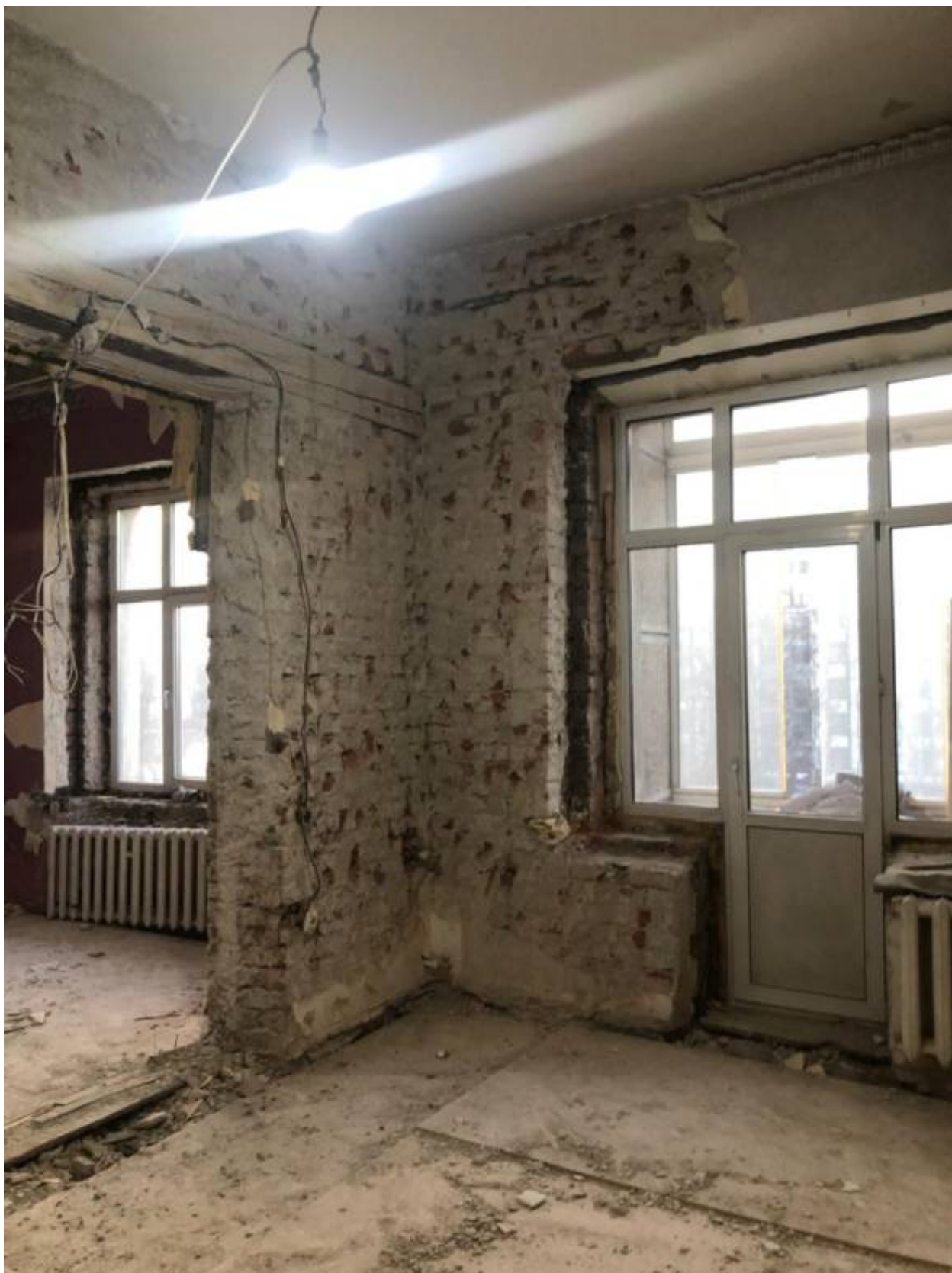
16. Помещение 2 (согласно техническому паспорту).
