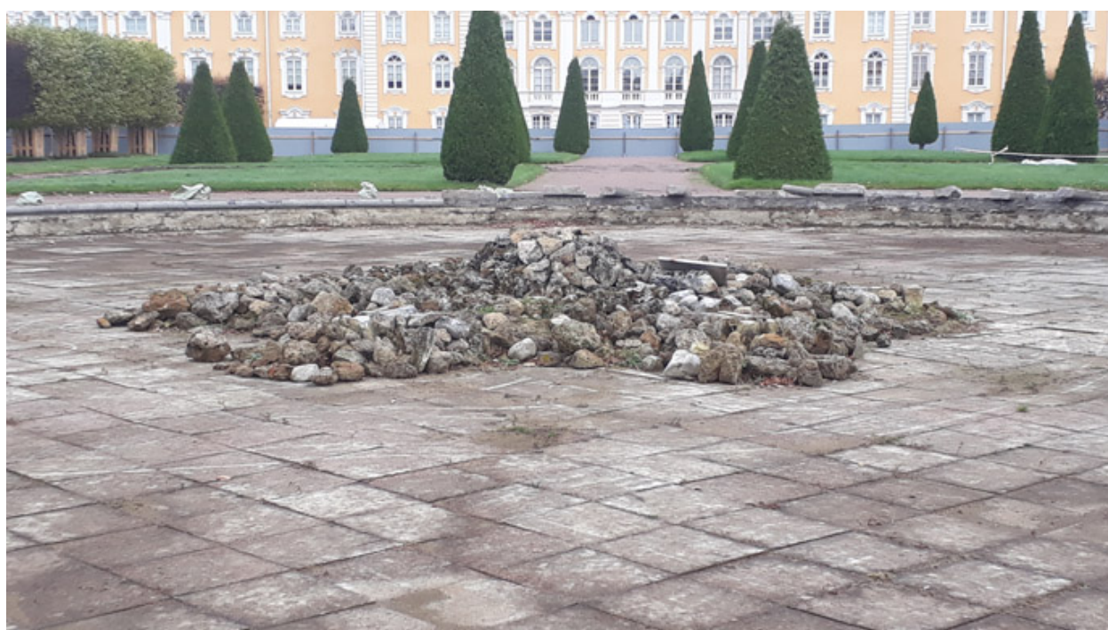
Фото 14. Объекты культурного наследия (Статуя «Амур с театральной маской» и Фонтанные фигуры «Дельфин») (шесть) в составе объекта культурного наследия федерального значения «Пруд с фонтаном «Дубовый»», «Верхнего сада» «Дворцово-паркового ансамбля Петродворца», расположенных по адресу: Санкт-Петербург, г. Петергоф, Санкт-Петербургский проспект, д 47, сооружение 4, лит. ФД.
