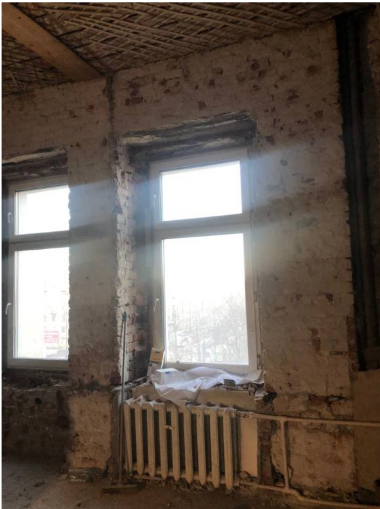
24. Помещение 6 (согласно техническому паспорту).
