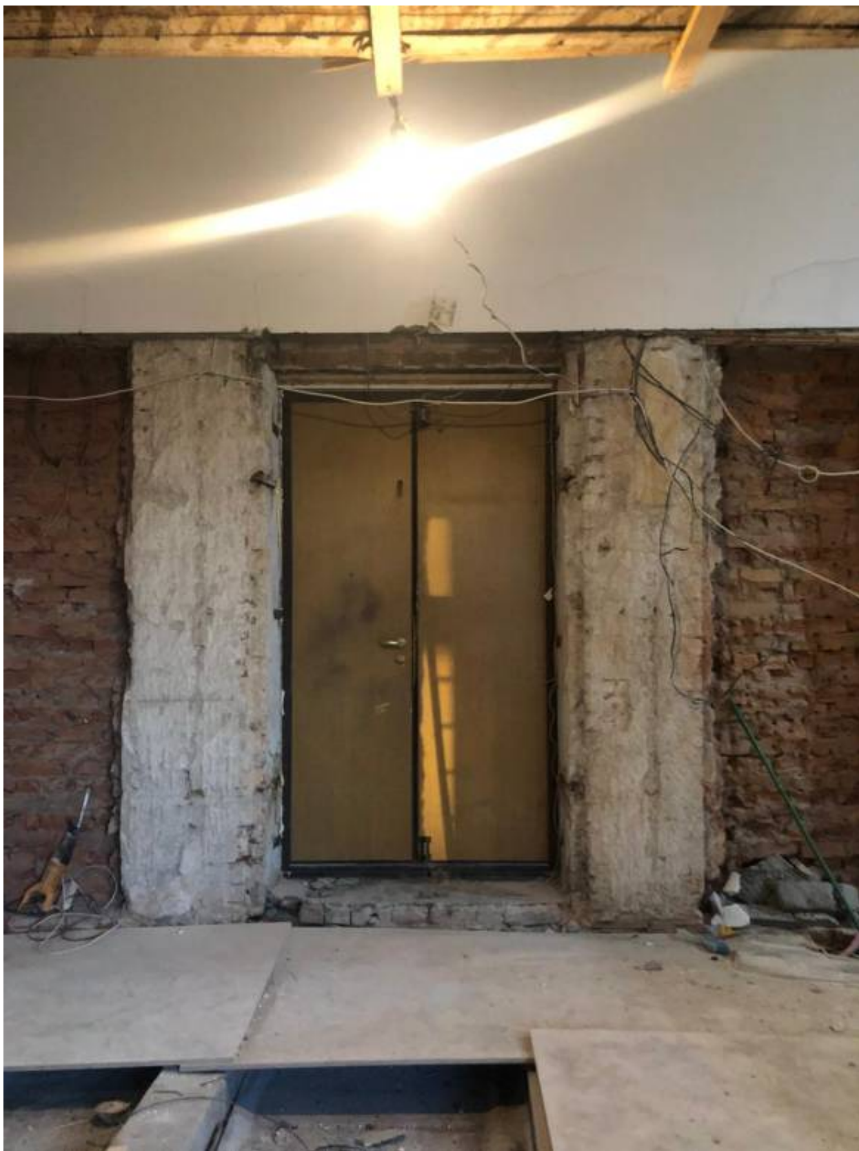
11. Помещение 7 (согласно техническому паспорту).
