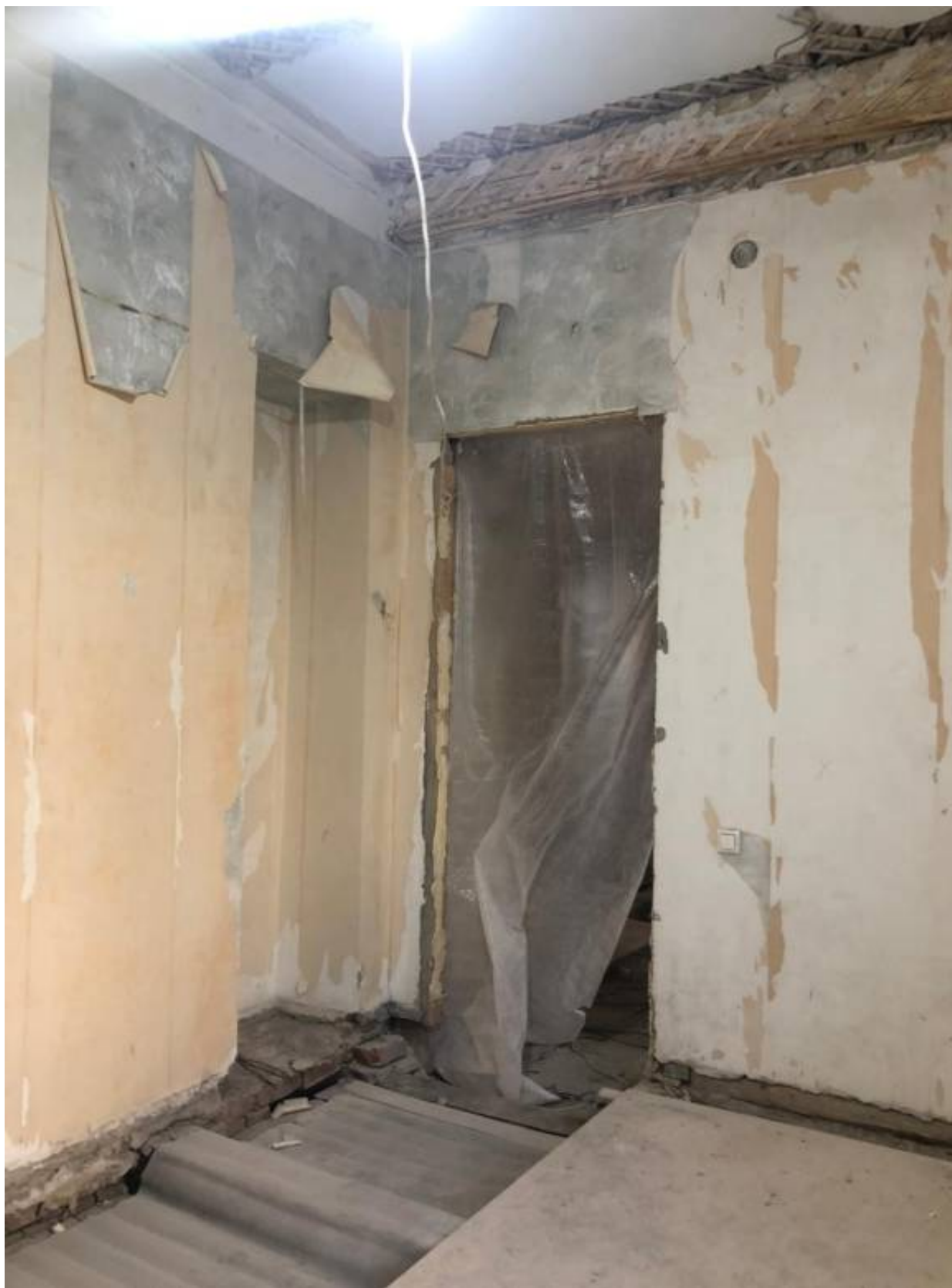
7. Помещение 1 (согласно техническому паспорту).
