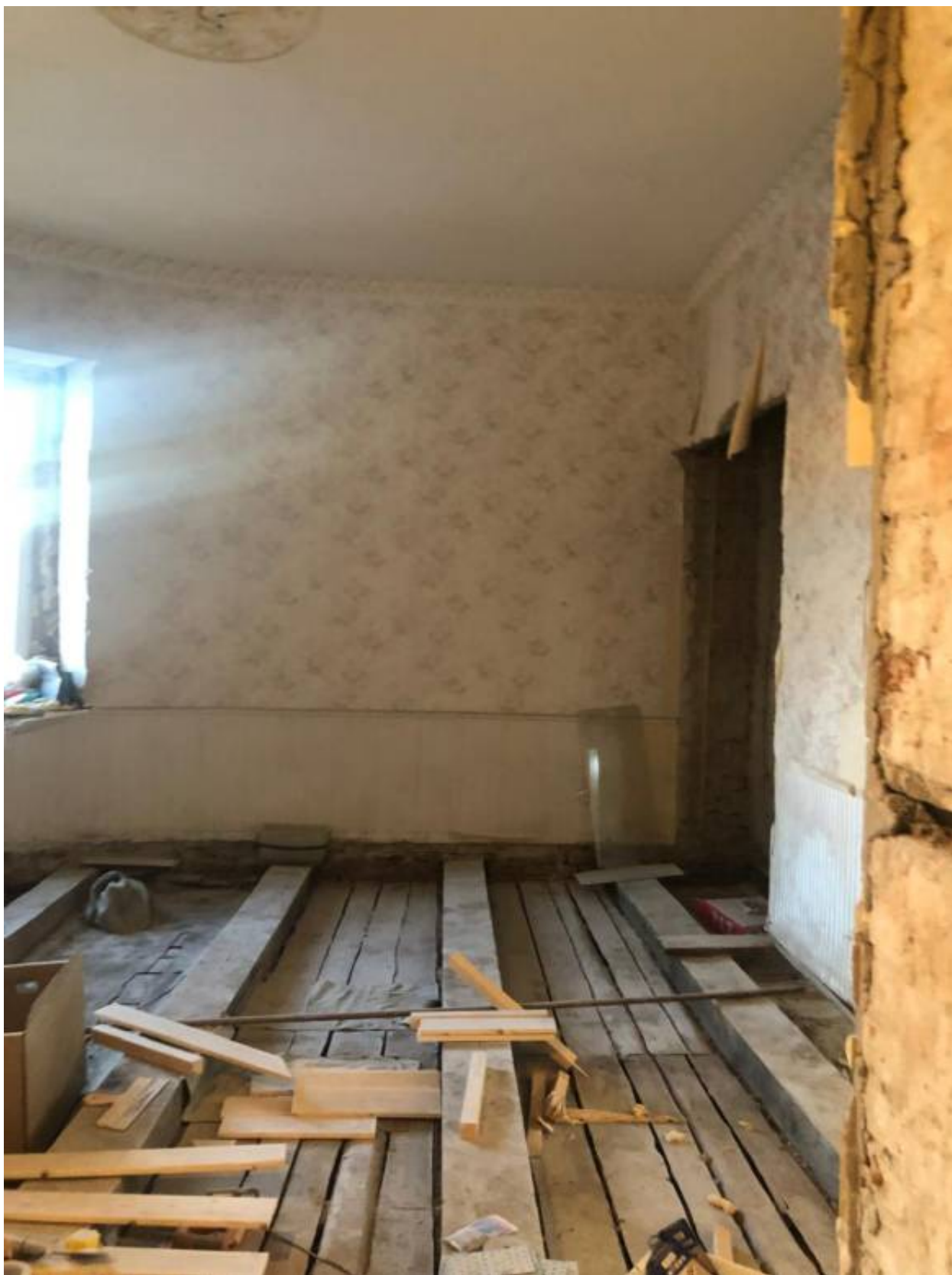
9. Помещение 4 (согласно техническому паспорту).
