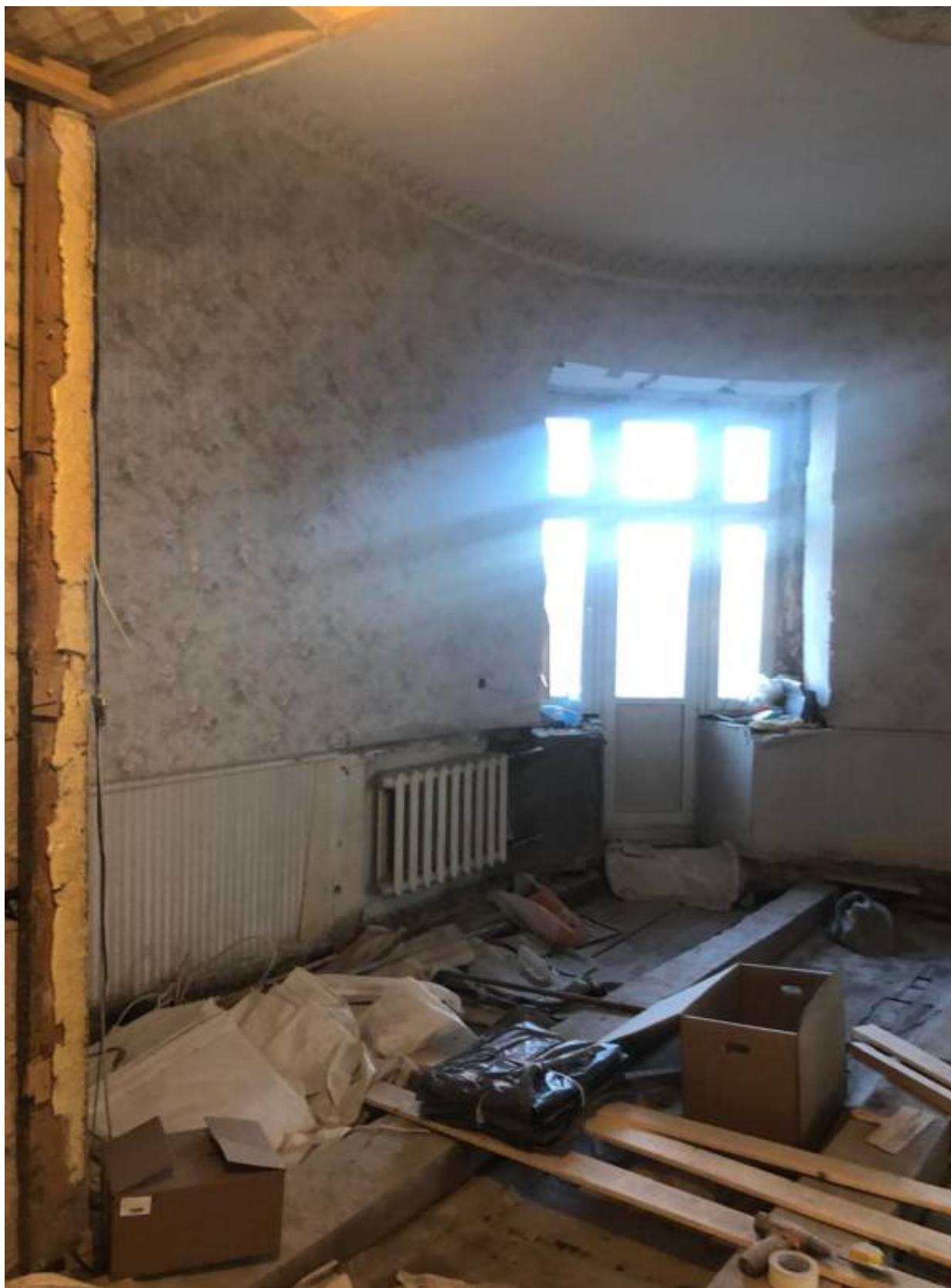
8. Помещение 4 (согласно техническому паспорту).
