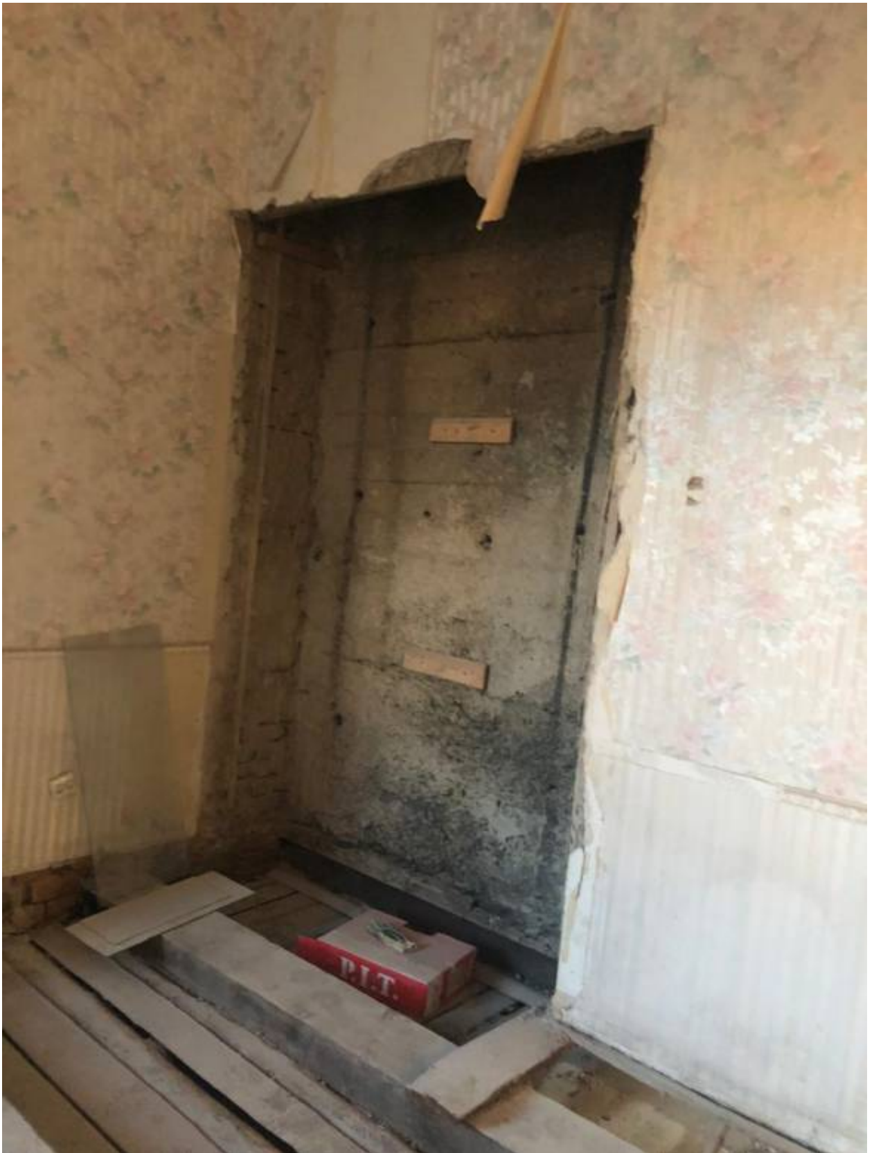
12. Помещение 4 (согласно техническому паспорту).
