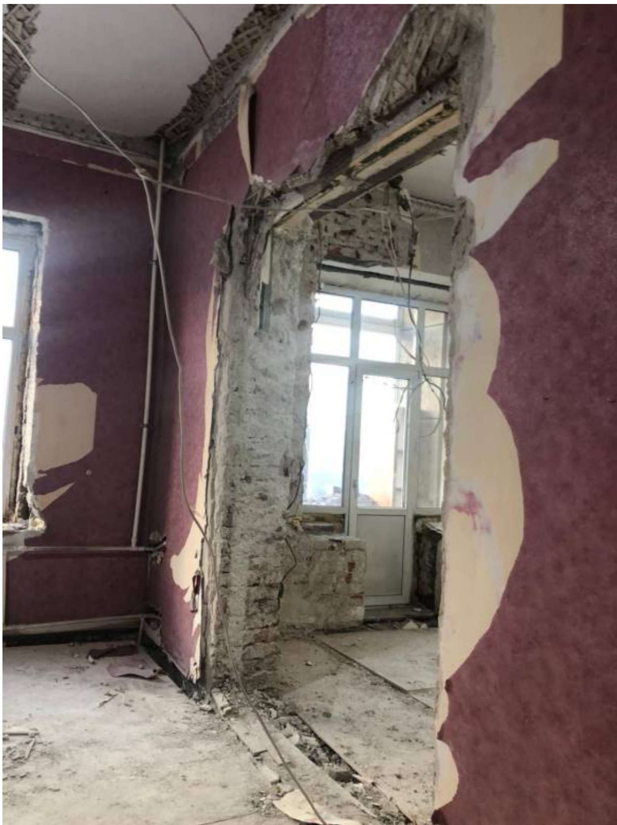
13. Помещение 3 (согласно техническому паспорту).
