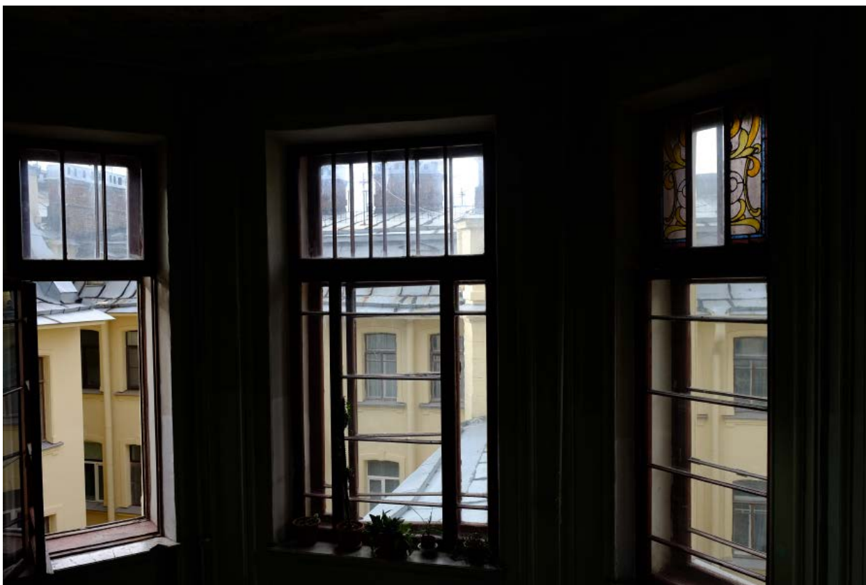
59. Кирочная улица, дом 24, литера А. «Дом Ю.Бака». Парадная лестница № 2. Шестой этаж. Общий вид оконных проемов.
