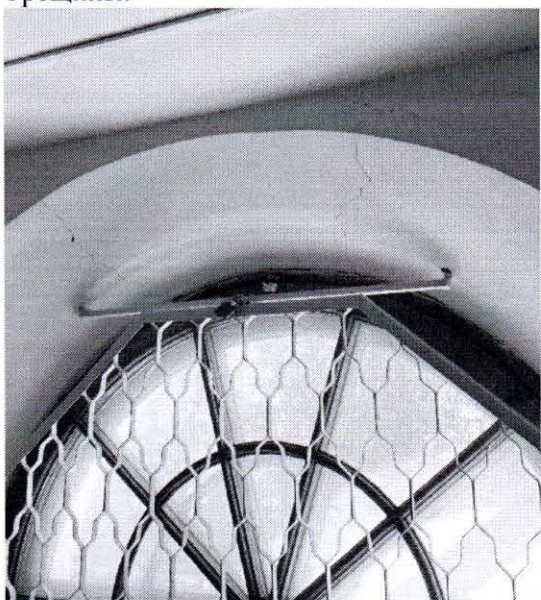
11. Лестница в южной части здания. Трещины.
