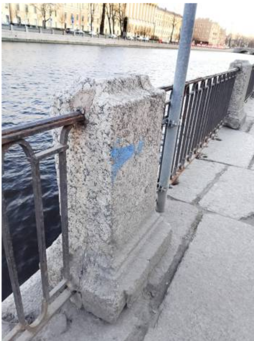
6. Гранитная тумба: вертикальная трещина в нижней части, химическое загрязнение, некачественная домастиковка утраты в месте сопряжения с поручнем.
