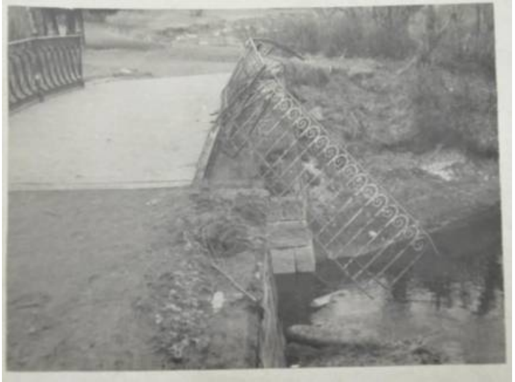
Ил. 28. Разрушения Чугунного мостика в Павловске. Фототека КГИОП № 2501/2 03.07.1937. ГМЗ Павловск.
